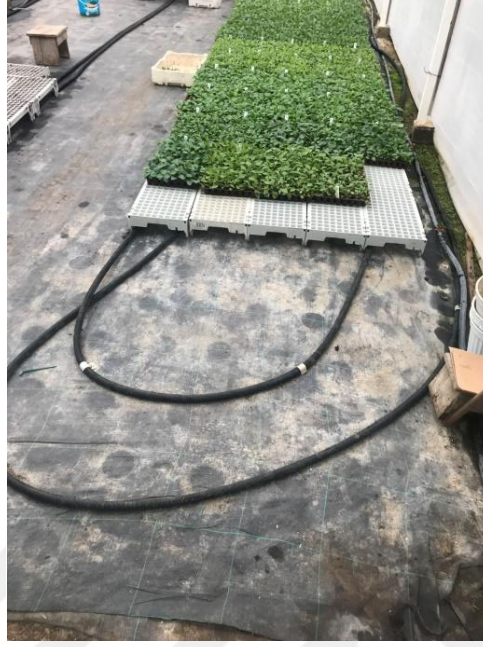
Şekil 3.10 : Zemin ısıtma boruları.
