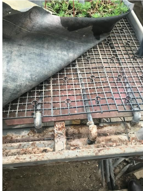
Şekil 3.11 : Masa üzerinde ısıtma boruları.
