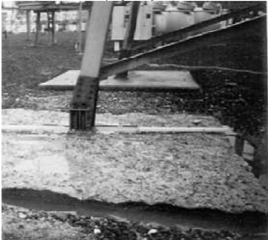
Şekil 2.4. Sülfat etkisiyle ağır hasar görmüş yapı
