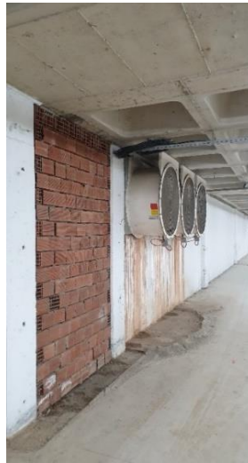
Şekil 3.10 : Örnek bir kurum binasının kapalı otoparkının duman atış bacası ve aksenal fanlar.
