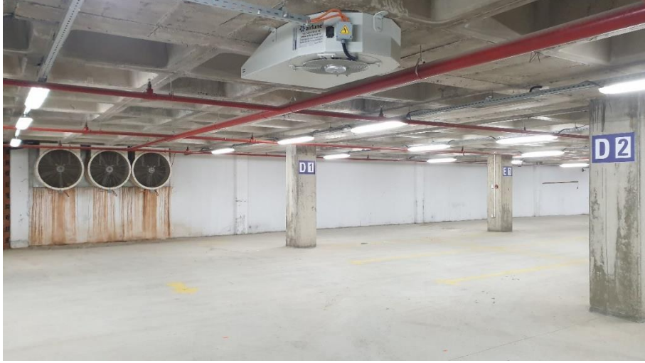
Şekil 3.4 : Örnek bir kurum binası kapalı otoparkı ve eksenel duman atış fanları.
