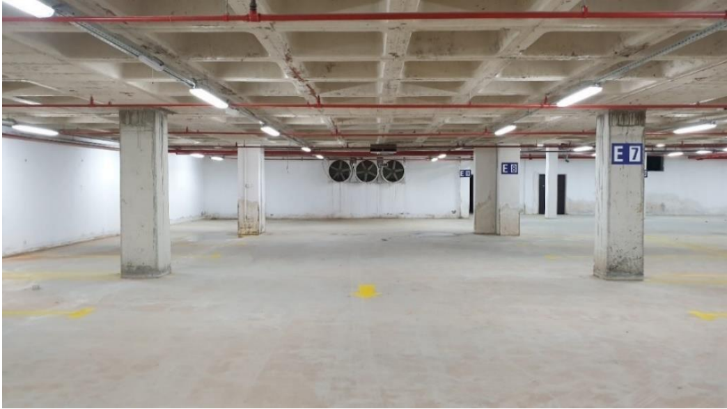
Şekil 3.8 : Örnek bir kurum binası kapalı otoparkının taze hava besleme bacası ve eksenel fanlar.
