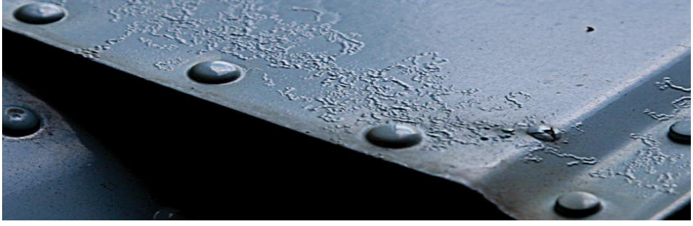
Şekil 1.13 : Tabaka altı korozyon örneği [9].
