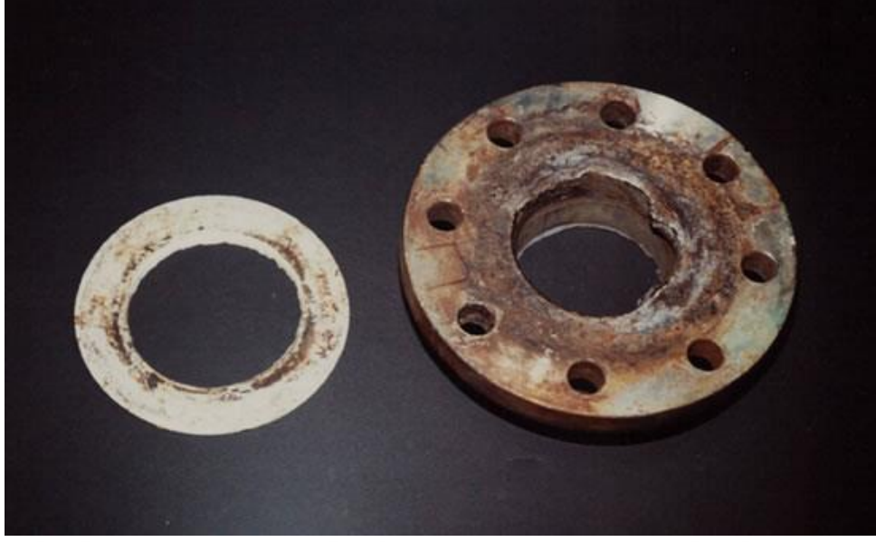
Şekil 1.7 : Metal yüzeyindeki aralık korozyonu örneği [8].
