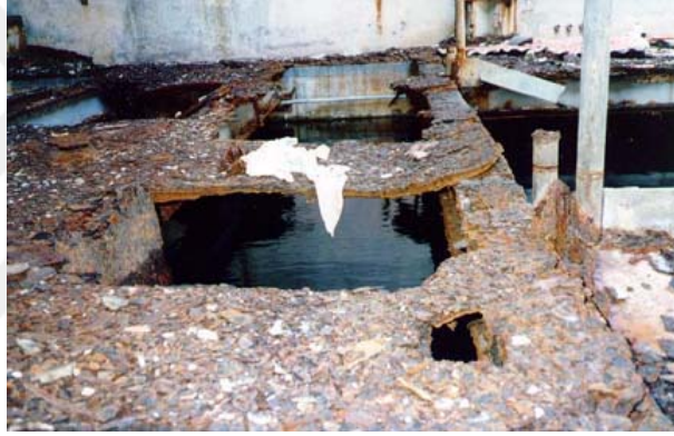
Şekil 1.4 : Çelik yapıda görülen üniform korozyon örneği [19]
