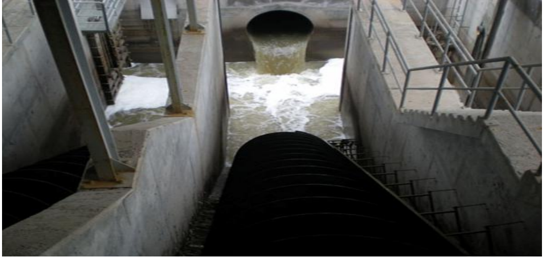
Resim 1. Atık su arıtma tesisine gelen atık suları
