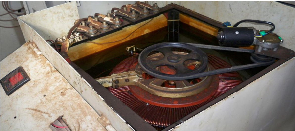
Şekil 4.4. Tesiste bulunan gerilim regülatörünün görünümü
