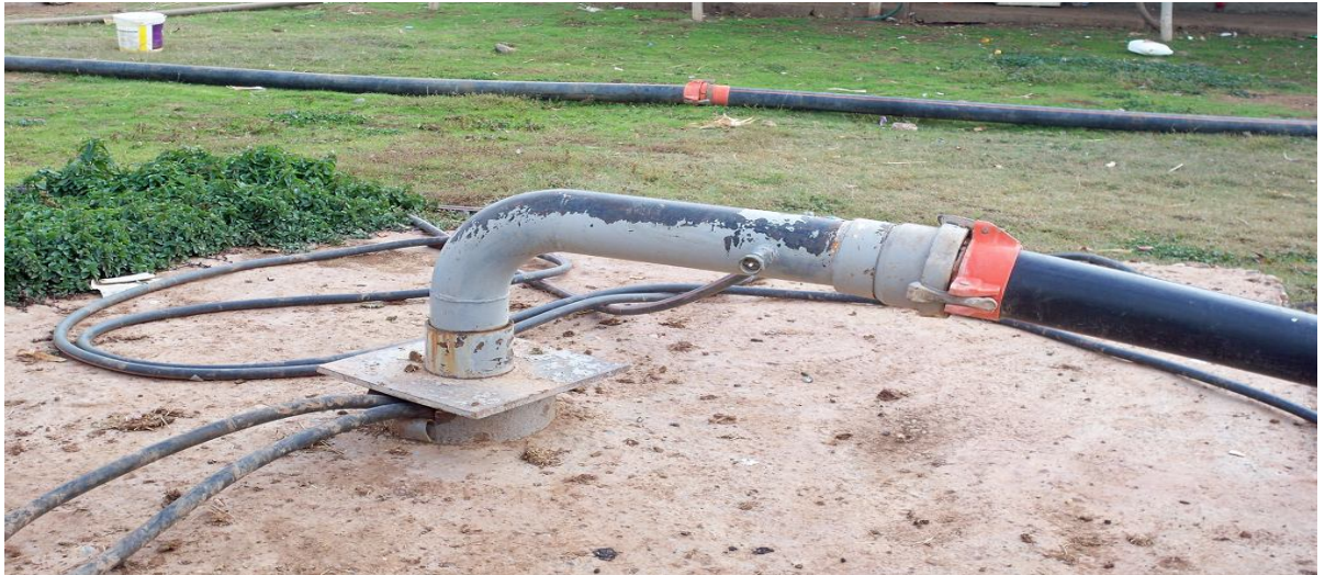
Şekil 4.2. Seçilen tesiste bir pompanın görünümü
