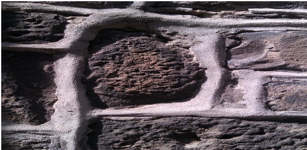
Şekil 2.4 Ulu Camii dış duvarında orijinal sıralar yanına dokuya uymayan örgü sıraları ve çimento harcı derzli iç avlu döşeme
