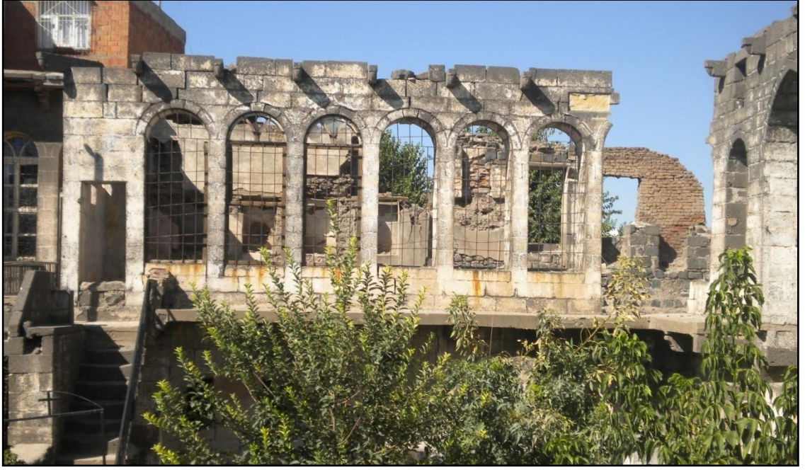
Şekil 5. 11. Konut bölümündeki metal elemanlarda oluşan bozulmalar (2012)
