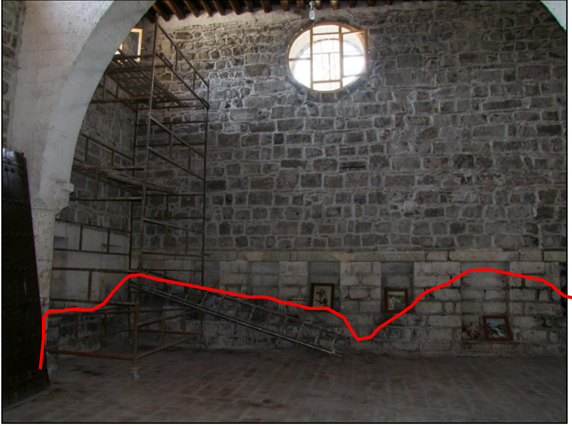
Şekil 5. 10. Zeminden gelen nemin etkisiyle oluşan bozulmalar (2013)
