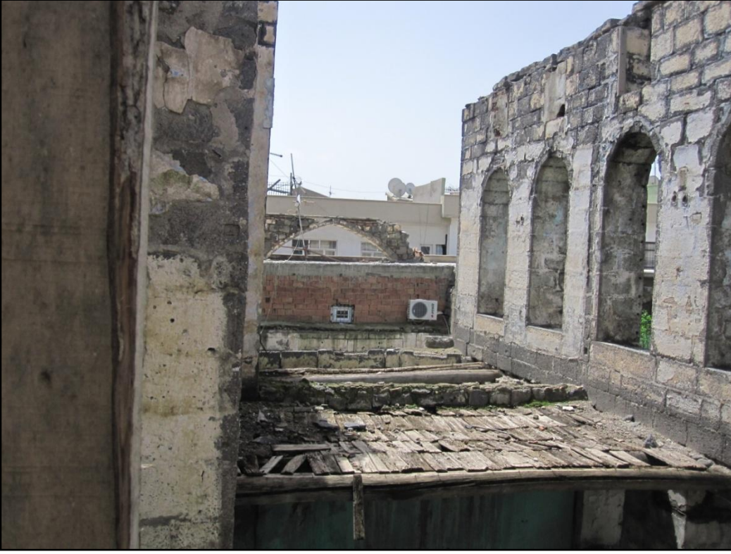
Şekil 5. 1. Zaman ve doğa etkisiyle ahşap elemanlarda oluşan bozulmalar (2012)
