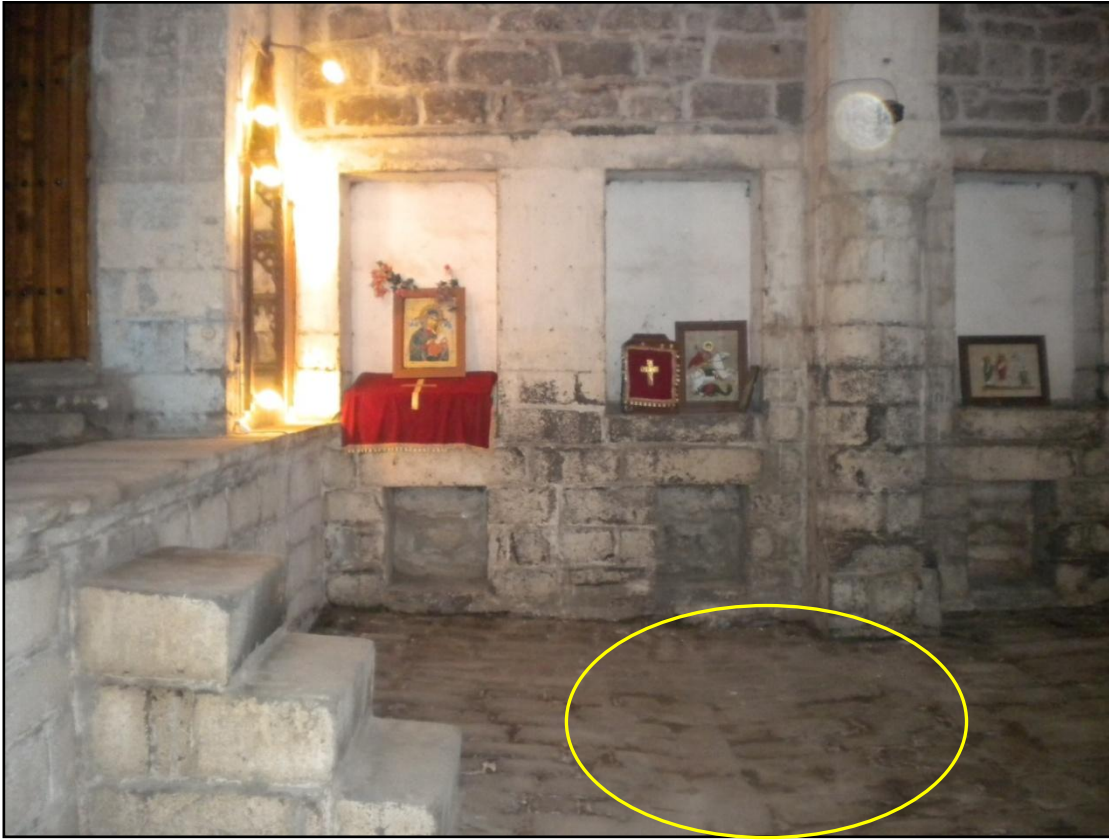
Şekil 5. 12. Kilise içindeki döşemede çökme/oturmalar (2013)
