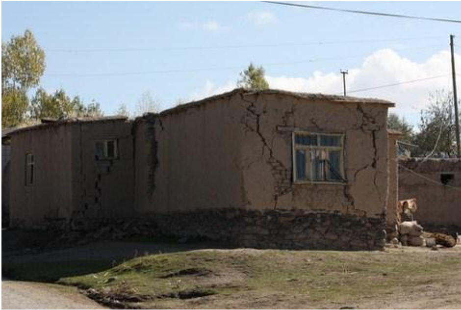
Şekil 3.1. Van-Döşeme Mezrası’nda hasarlı bir yığma yapı örneği (Parsa 2011)
