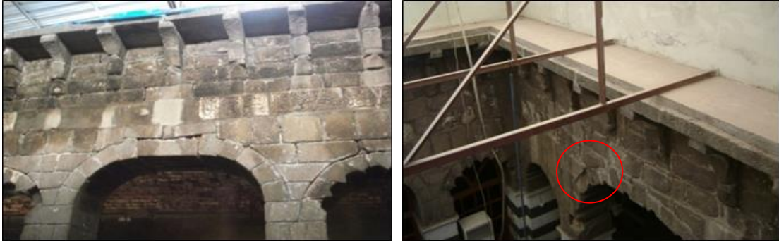
Şekil 4.109. Zinciriye Medresesi orta revak kemerinde oluşan eksen kayması hasarları
