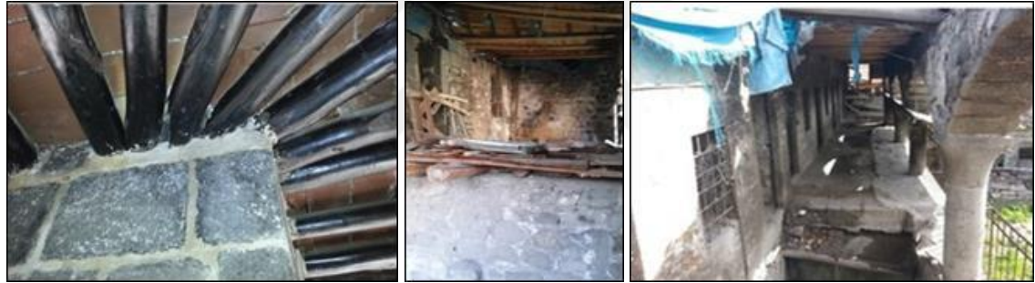
Şekil 4.69. Sülüklü Han ve Çifte Han'daki ahşap kirişlemelerin duvarla bağlantı hasarları
