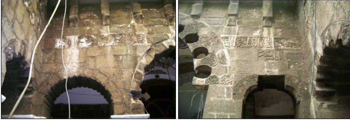
Şekil 4.123. Zinciriye Medresesinde yok olan harçlar yerine yenilenen çimento katkı harçların duvarlarda oluşturduğu kireçlenme ve tuzlanma hasarları (VBM Arşivi)
