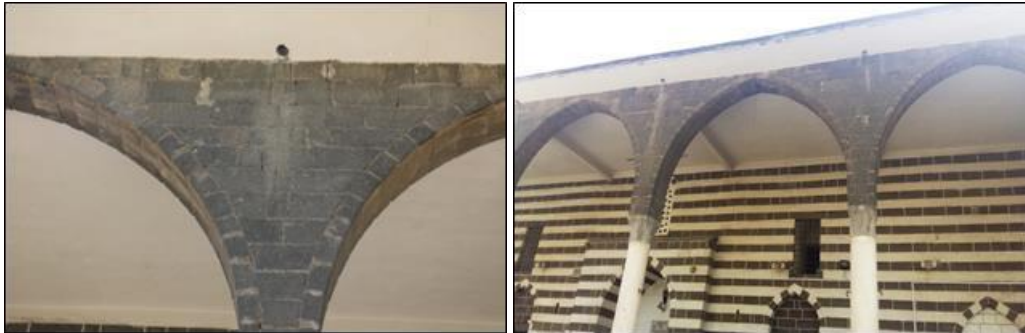
Şekil 4.295. İskender Paşa Camii son cemaat yerindeki kemer tempan yüzeylerindeki bozulmalar
