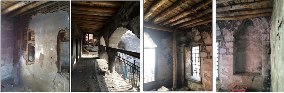
Şekil 4.70.Çifte Han güney cephesindeki ahşap döşemelerdeki taşıyıcı sistem hasarları
