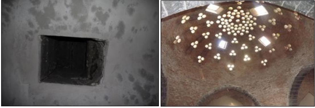
Şekil 4.90. Vahap Ağa Hamamı kapatılan hamam bacası ile yoğuşma sonrası oluşan nem hasarı
