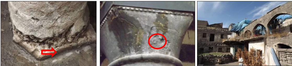
Şekil 4.71. Hasan Paşa Hanı şadırvanı ile Çifte Han Hanı revak sütunlarında parça kopması, erime ve eksen kaymasına bağlı oluşan taşıyıcı sistem hasarları
