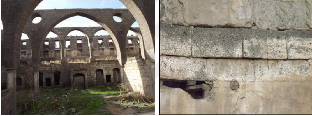
Şekil 4.284. Narteks, naos kemerleri ile naos doğu duvarında görülen aks kayma hasarı
