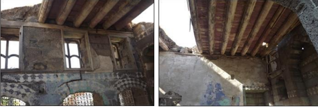
Şekil 3.45. Toprak damda çürüyen ahşap kirişlere bağlı oluşan yıkılma hasarları
