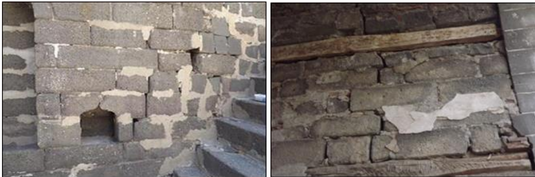
Şekil 3.52. Duvarlarda derz boşalması ve harç kaybına bağlı oluşan ayrışma hasarları
