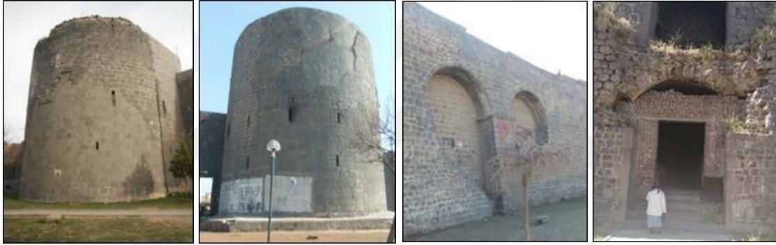
Şekil 4.15. 74-20' numaralı burçlar ile 40-41 numaralı ve tek kapıdaki sur duvarlarında hatalı restorasyon uygulamaları
