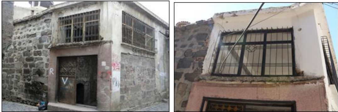
Şekil 4.88.Çardaklı Hamamı hatalı restorasyonunda yapılan nitelsiz eklentiler
