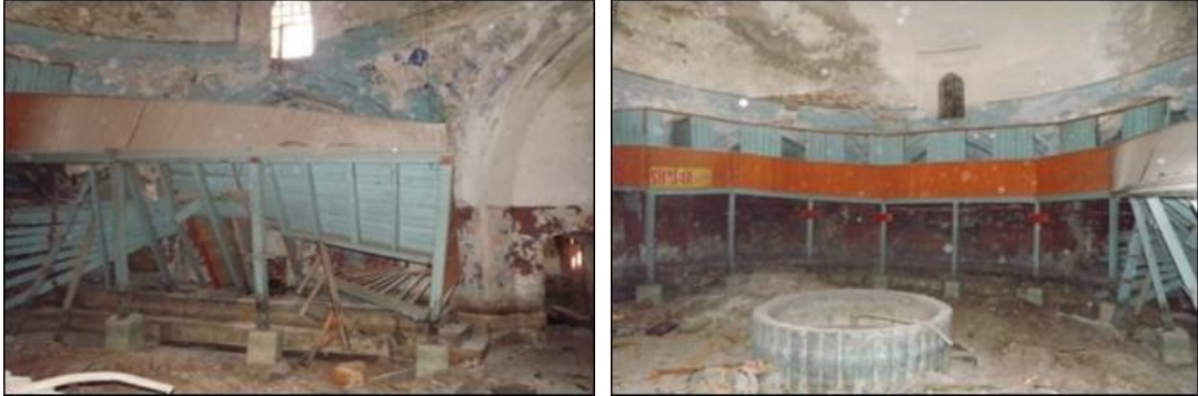
Şekil 4.93. Deva Hamamı'nda bakımsızlık nedeniyle ahşap sekilerde ve duvarlarda oluşan hasarlar
