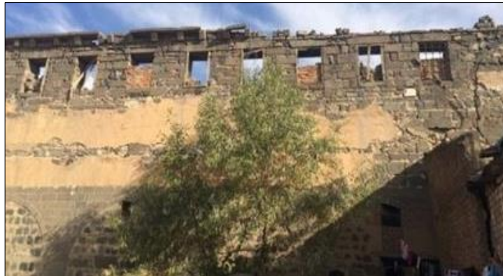
Şekil 4.270. Üst örtüye bağlı cephe duvarında oluşan aşınma ve malzeme kayıpları (Ekim 2017)
