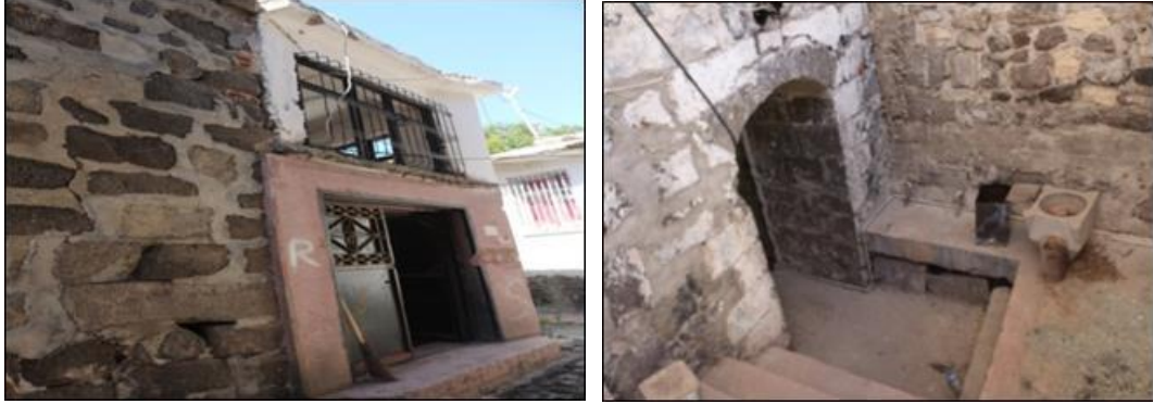
Şekil 4.98.Çardaklı Hamamı girişinde betonarme eklenti ve döşeme kaybı hasarı
