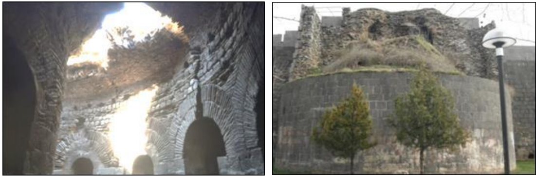
Şekil 3.44. Burçlarda kubbe çatlak ve yıkılma hasarları
