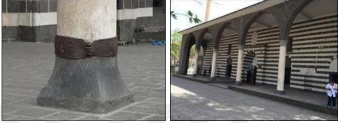
Şekil 4.291.İskender Paşa Cami sütun parçalarının çimento esaslı harçla doldurulması ve korozyon hasarları
