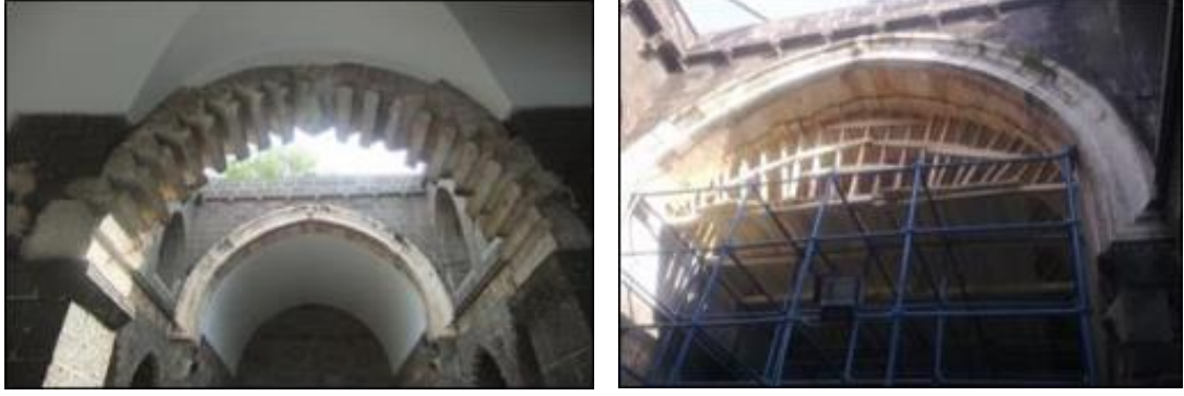
Şekil 4.103. Mesudiye Medresesinde eyvan kemerlerde görülen ayrışma hasarları
