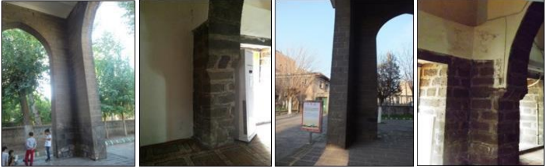
Şekil 3.34. Camilerin son cemaat yerlerindeki ayaklarda görülen ayrışma ve tuzlanma hasarları
