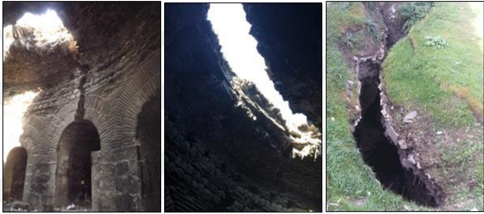
Şekil 4.261. 22 no'lu burcun üst örtüsünde oluşan hasarlar
