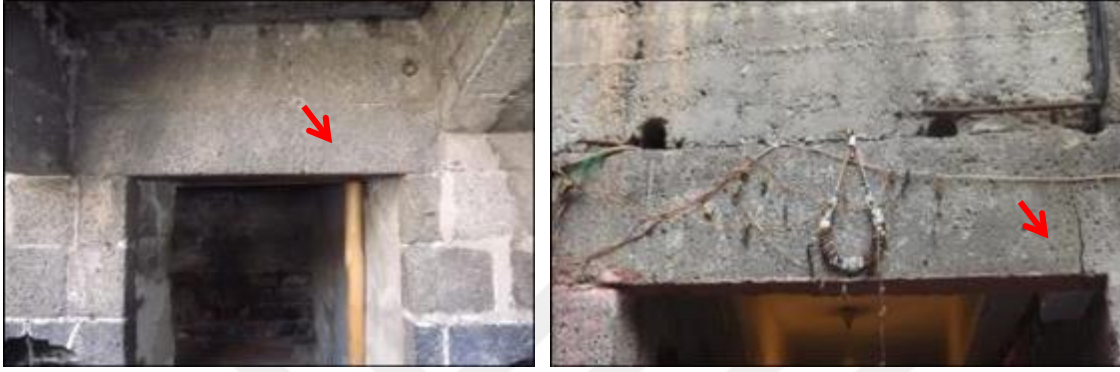
Şekil 4.131. Diyarbakır evlerinde lentolardaki çatlak hasarları
