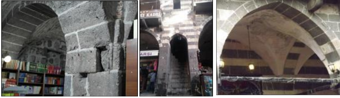
Şekil 4.66.Hasan Paşa Hanı kemer ve yatay taşıyıcı elemanlardaki nem ve malzeme kaybı hasarı
