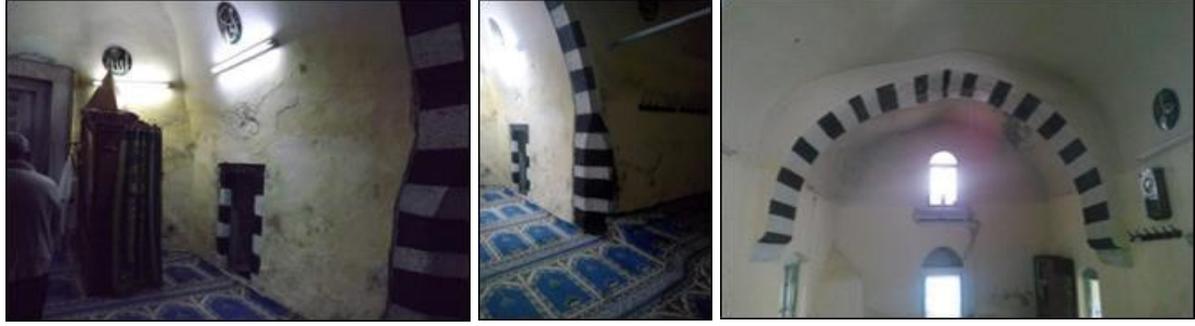
Şekil 4.55. Hoca Ahmet Camisinde bakımsızlığa bağlı oluşan nem ve ayrışma hasarları
