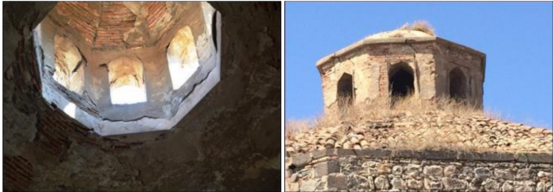
Şekil 4.325. Deva Hamamı soğukluk bölümündeki aydınlık fener duvarlarındaki strüktürel hasarlar
