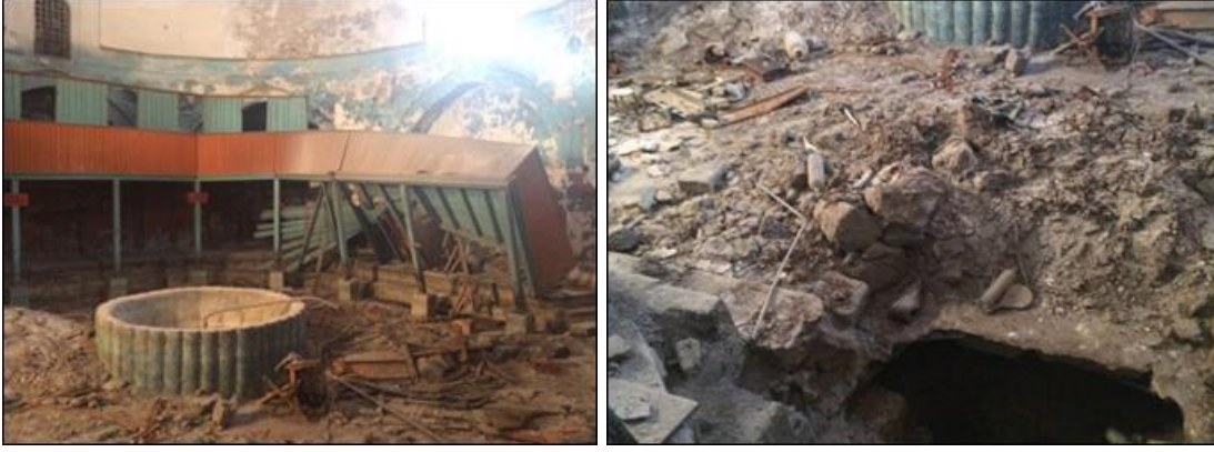
Şekil 4.318. Deva Hamamı soğukluk bölümü zemin döşemesinin çökmesi ve hafriyatlarla dolması
