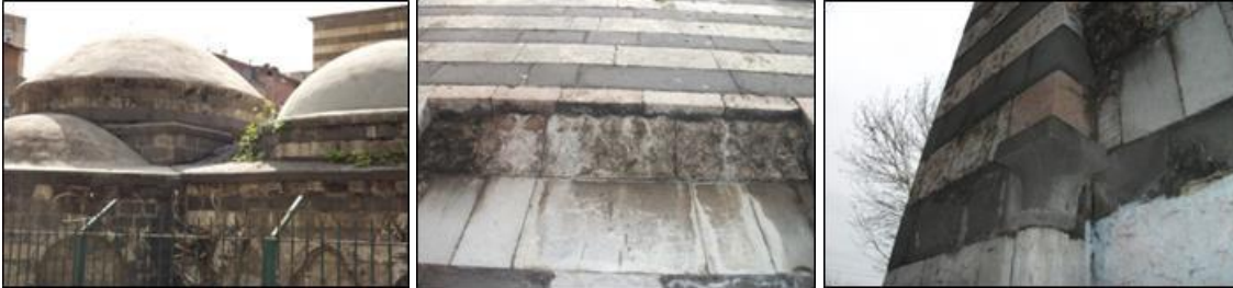
Şekil 4.54. İskender Paşa, Şeyh Mutahhar ve Hoca Ahmet Camilerinde oluşan bitki oluşumu ve kirlenmeye bağlı oluşan hasarlar
