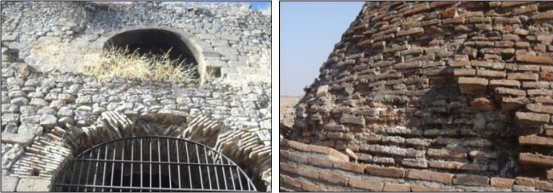
Şekil 3.50. Tuğla malzemeyle yapılmış kemer ve kubbelerde çatlak, ayırışma ve harç kaybı hasarları
