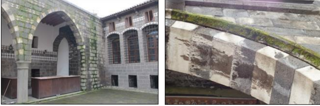
Şekil 3.51. Taş malzemede kirlenme ve bitki oluşumlarına bağlı bozulmalar
