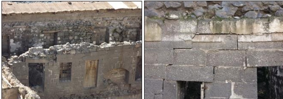
Şekil 4.313. Çifte Han batı cephesindeki üst örtünün yıkılmasıyla lentolarda ve duvarlardaki ayrışma hasarları
