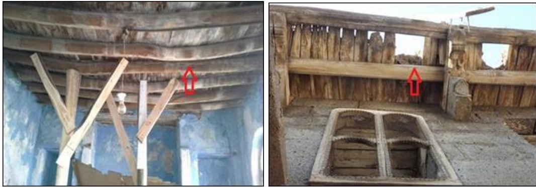
Şekil 3.49. Ahşap malzemede oluşan kayıp ve sehim hasarları
