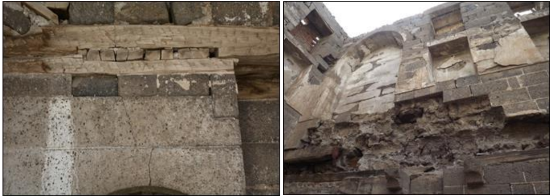
Şekil 4.277. Surp Sargis Kilisesi'nde deforme olan ve taşıyıcılık özelliği azalan ahşap hatıllar
