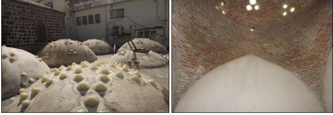
Şekil 4.87. Vahap Ağa Hamamı kubbe dışında ve içinde oluşan bozulmalar
