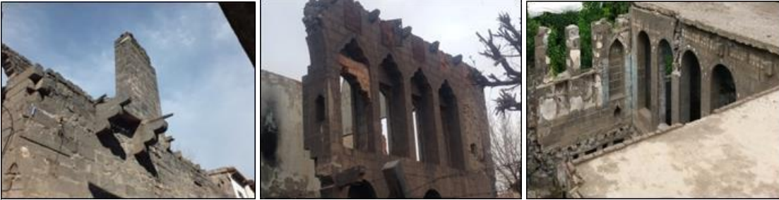
Şekil 4.140. Diyarbakır evlerindeki eksen kaymasına bağlı oluşan hasarlar
