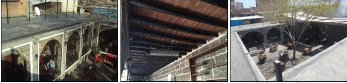
Şekil 4.73.Sülüklü Han hatalı restorasyona bağlı oluşan taşıyıcı sistem hasarları
