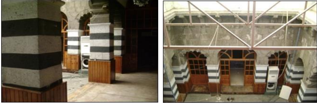
Şekil 4.117. Zinciriye Medresesi kullanıcılar tarafından duvar ve eyvana eklenen ahşap kaplamalar
