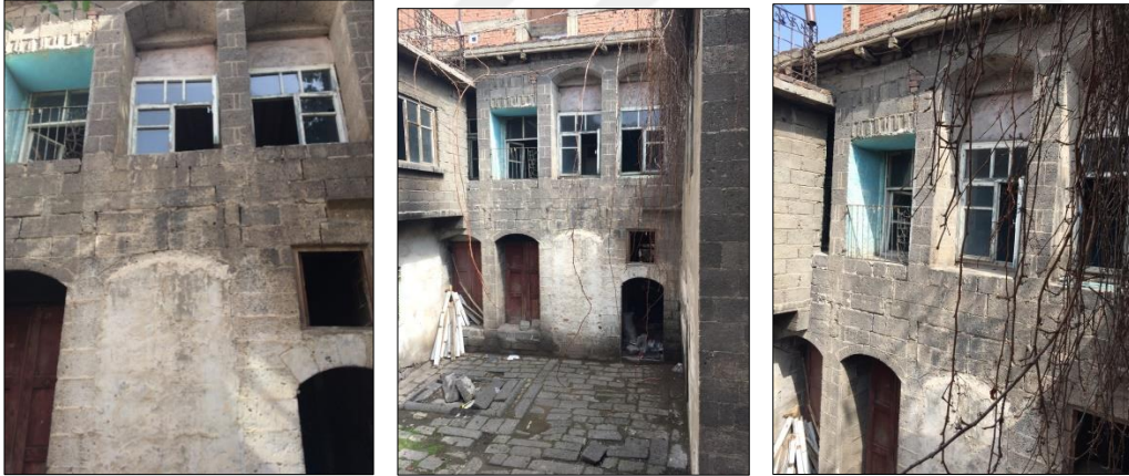
Şekil 4.343. Geleneksel Diyarbakır Evi'nde pencerelerdeki dolgulara bağlı oluşan hasarlar
