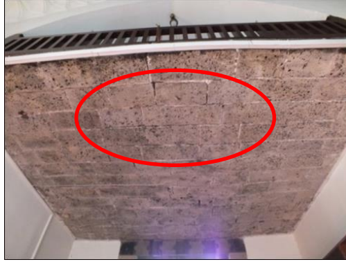
Şekil 4.51. Behram Paşa camii kadınlar mahfilinde açılma hasarı görülen döşeme
