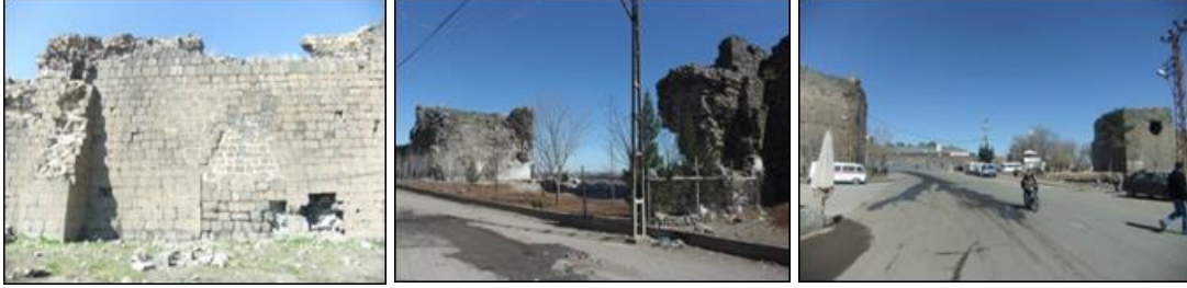
Şekil 4.20. 45-46, 47-48 ve 64-65 numaralı burçlar arasındaki sur duvarlarında tümüyle veya kısmi oluşan malzeme kaybı ve yıkılma hasarları
