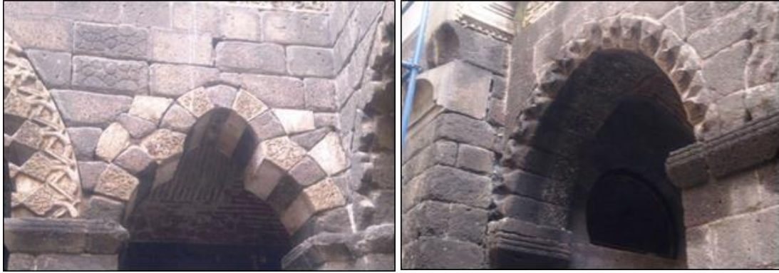
Şekil 4.122. Mesudiye Medresesi batı kanadı revak kemerleri ve duvarlarındaki harç kaybı hasarları
