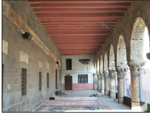
Şekil 4.105. Mesudiye Medresesi revak üstündeki betonarme döşemeye bağlı kemer ve sütunlardaki ayrışma, kayma hasarları (VBM Arşivi 2010)
