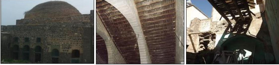
Şekil 4.26. Saint George (Kara Papaz) Kilisesi Kubbesinde Oluşan Bitkilenme, Mar Petyum Kilisesindeki betonarme damın yaptığı ezilme ve patrikhane bölümünün çöken üst örtü hasarları
