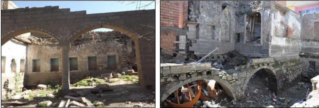
Şekil 4.136. Diyarbakir evlerindeki döşemelerde oluşan oturma ve çökme hasarları
