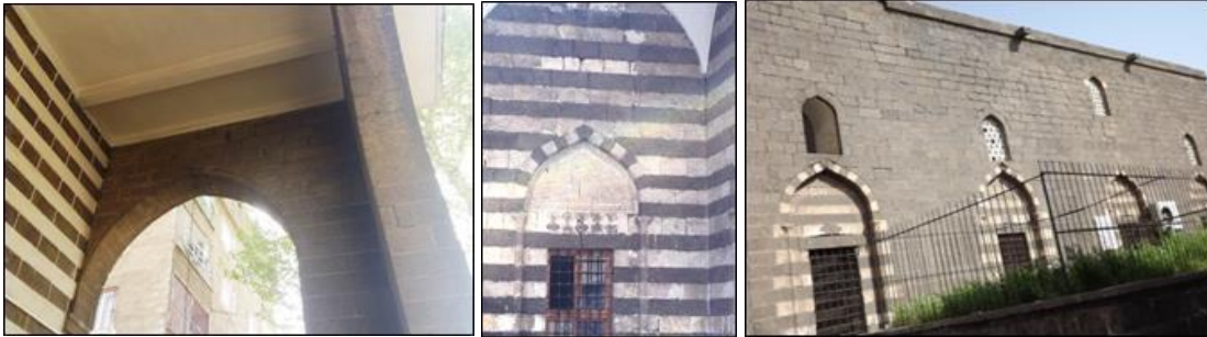
Şekil 4.39. İskender Paşa ve Parlı Safa Camilerinde oluşan duvarlardaki ayrışma hasarları
