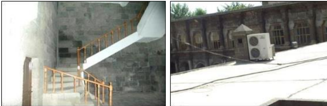
Şekil 4.114. Mesudiye Medresesinde kullanıcılar tarafından yapılan betonarme merdiven ve tesisatlar
