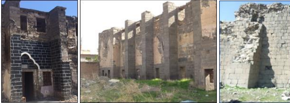
Şekil 3.31. Payandalarda oluşan ayrışma ve yıkılma hasarları
