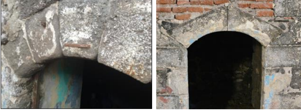
Şekil 4.329. Deva Hamamı soğukluk ve sıcaklık bölümlerindeki kapı kemerlerindeki harç kayıpları
