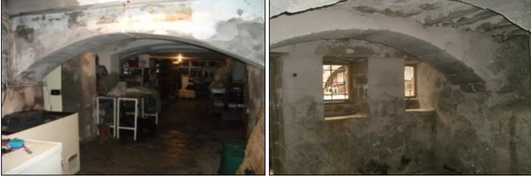
Şekil 4.143. Bodrum katlarda zemin neminden kaynaklanan bozulmalar
