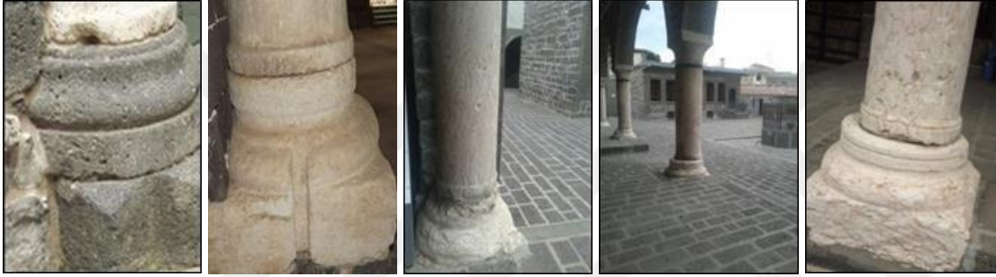
Şekil 4.28. Saint George ve Meryem Ana Kilisesi'nde oluşan eksen- aks kayması ve buna bağlı oluşan hasar örnekleri
