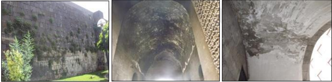
Şekil 4.14. 74-75 no'lu sur duvarları ve 20' ve 4 no'lu burçlarda oluşan nem hasarları
