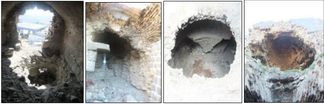
Şekil 4.11. 47'- 60- 57- 56 numaralı burç döşemelerinde oturma, çökme hasarları
