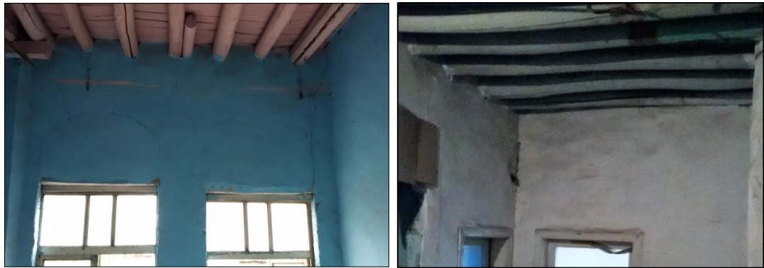
Şekil 4.339. Geleneksel Diyarbakir Evi ahşap kirişlemelerde oluşan sehim ve çürüme hasarları
