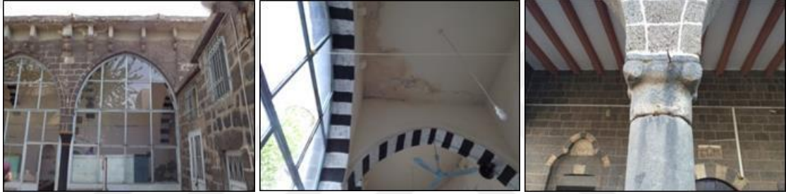
Şekil 4.47. Hoca Ahmet Cami ile Ali Paşa Camisinde betonarme döşemeye bağlı hasarlar
