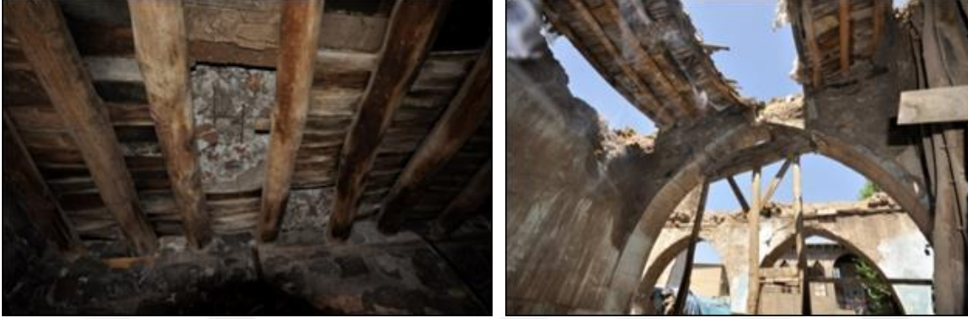
Şekil 3.35. Ahşap döşemelerde oluşan çökme hasarları
