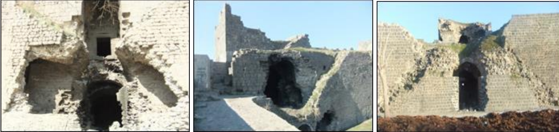
Şekil 4.21. 14-24 ve 60 numaralı burç ve sur duvarları ile merdivenlerde yıkılma hasarları
