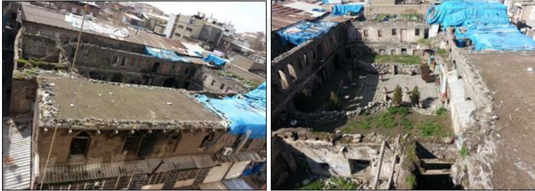
Şekil 4.309. Çifte Han'daki üst örtünün yıkılmış doğu batı ve güney kanatları
