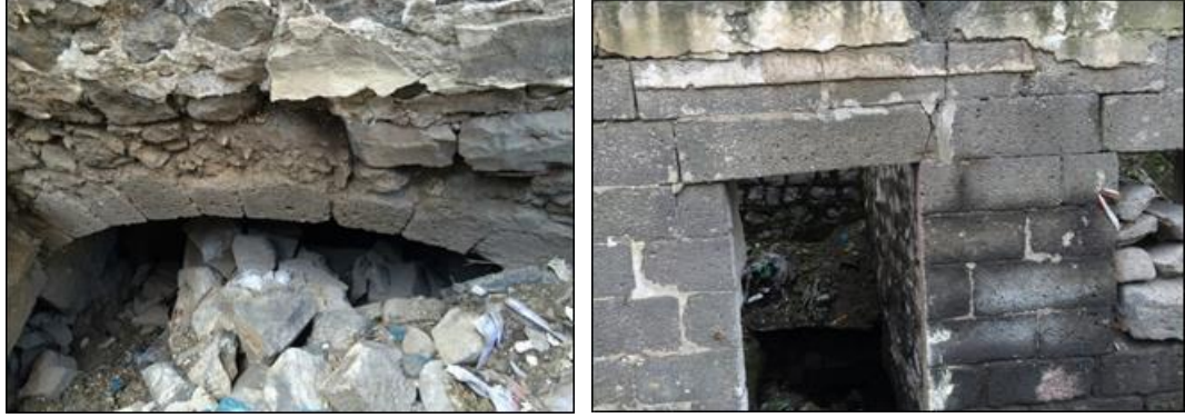
Şekil 4.310. Çifte Han Güneydoğu Cephesindeki Yıkılan Zemin Duvarlarındaki Hasarlar
