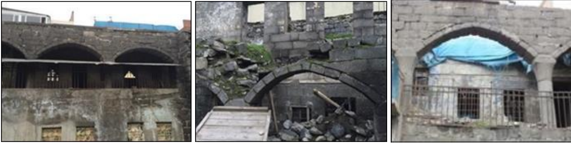
Şekil 4.67.Çifte Han'daki kemerlerde ayrışma ve yıkılmalara bağlı oluşan hasarlar
