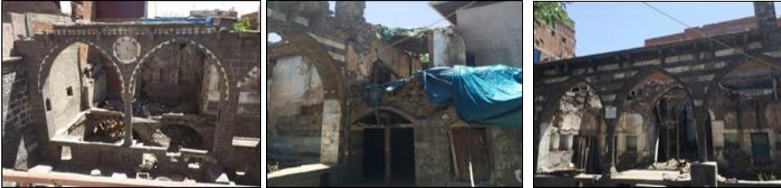
Şekil 4.155. Evlerindeki harç kayıplarıyla oluşan taşıyıcı sistem hasarları
