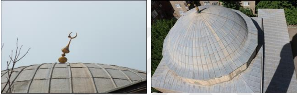
Şekil 4.294. İskender Paşa Camii kubbesindeki kurşun kaplamalarındaki bozulmalar
