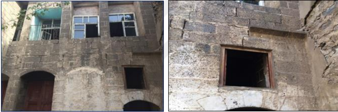
Şekil 4.128. Geleneksel Diyarbakır Evinde duvarlarda oluşan ayrışma ve çözülme hasarları
