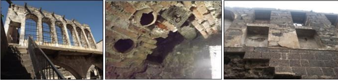
Şekil 4.37.Mar Petyum Keldani Kilisesi patrikhane bölümü duvarında, Meryem Ana Kilisesindeki küplerde ve Surp Sargis Kilisesinde taş ve dolgu harcındaki malzeme kaybı hasarları
