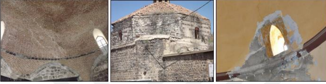
Şekil 4.83. Vahap Ağa ve Paşa Hamamlarının kubbelerinde oluşan çatlak hasarları
