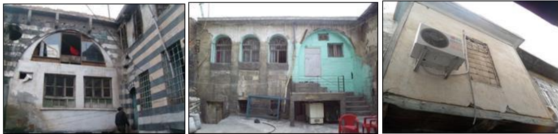
Şekil 4.149. Evlerde kullanıcıya bağlı oluşan taşıyıcı sistem hasarları
