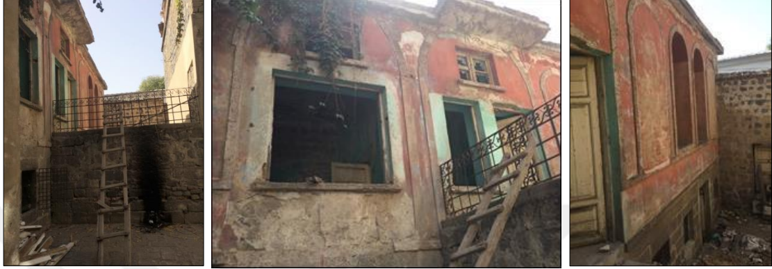
Şekil 4.338. Geleneksel Diyarbakir Evi batı cephesinde oluşan hasarlar
