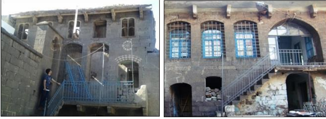
Şekil 4.127. Duvarlarda Oluşan Ayrışma ve Çözülme Hasarları
