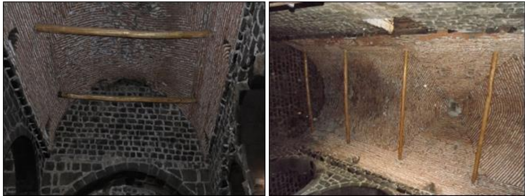
Şekil 4.250. Keçi Burcunda tonozların güçlendirilmesinde kullanılan ahşap gergi çubukları
