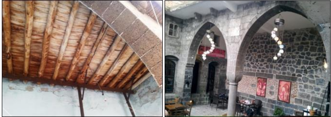
Şekil 4.146. Diyarbakır evlerinde ahşap kiriş hasarları ve hatalı restorasyonlar
