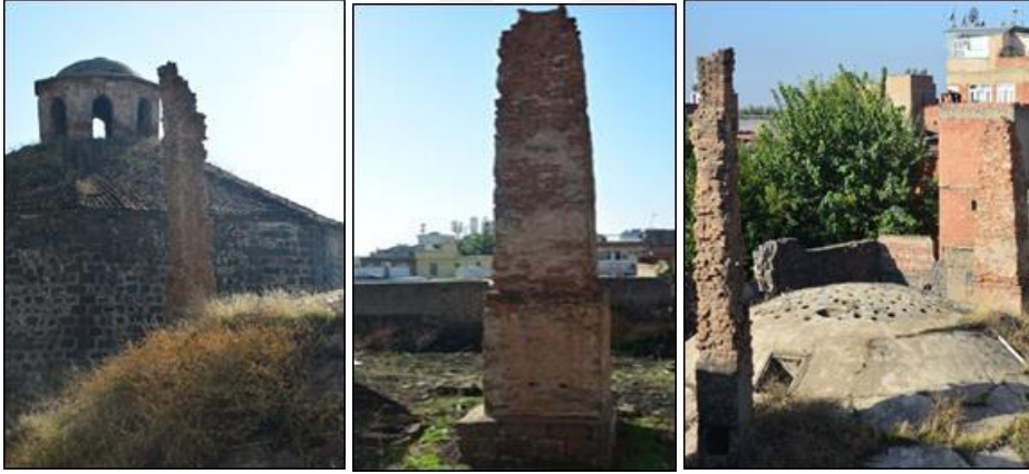
Şekil 4.327. Deva Hamamı baca duvarlarındaki malzeme kaybı hasarları
