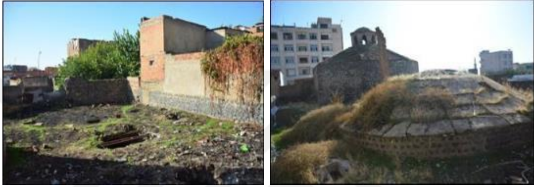
Şekil 4.334. Deva Hamamı üst örtüsündeki toprak dolgu ve bitki oluşum hasarları
