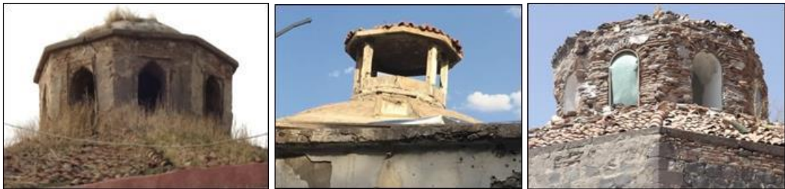
Şekil 4.82. Deva, Çardaklı ve Melik Ahmet Paşa Hamamlarındaki fenerlerde oluşan hasarlar
