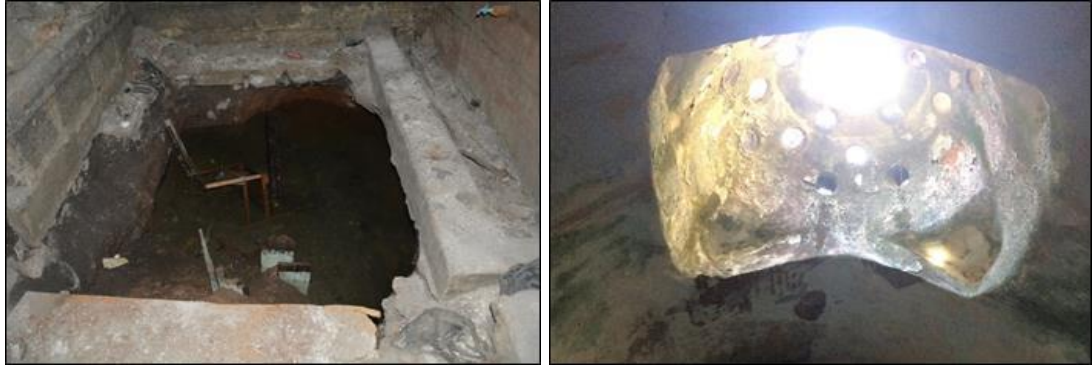
Şekil 4.320. Deva Hamamı ılıklik döşemesindeki çökme ve fil gözlerindeki hasarlar
