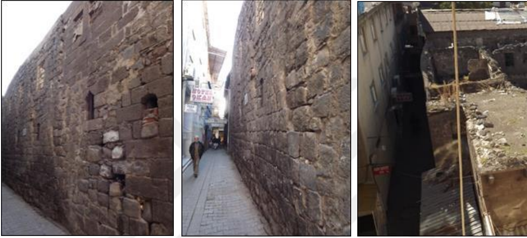
Şekil 4.302. Çifte Han aks kayması olan doğu cephe duvarı
