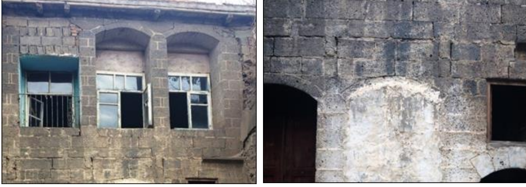
Şekil 4.139. Geleneksel Diyarbakır Evi'nde derz boşalmalarına bağlı oluşan ayrışma hasarları
