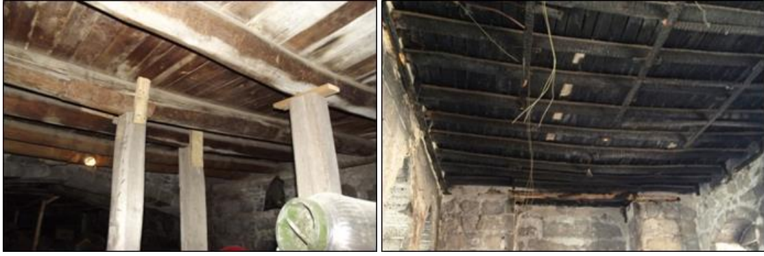
Şekil 4.148. Diyarbakır evlerinde ahşap kiriş hasarları ve kullanıcıların yaptığı hatalı müdahaleler
