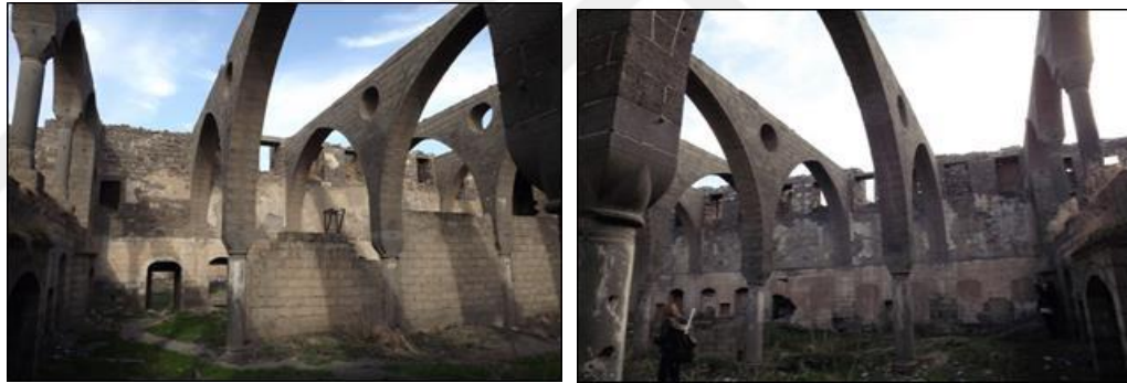
Şekil 4.283. Surp Sargis Kilisesi naos bölümündeki sütunlar arası ve cephe duvarlarındaki niteliksiz dolgu ve eklentiler
