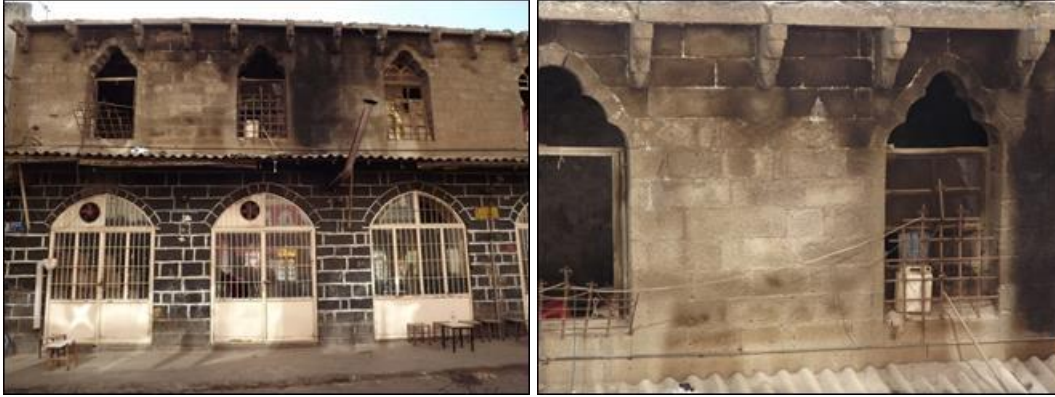
Şekil 4.306. Çifte Han kuzey cephe duvarındaki kullanıcılara bağlı oluşan bozulma ve hasarlar
