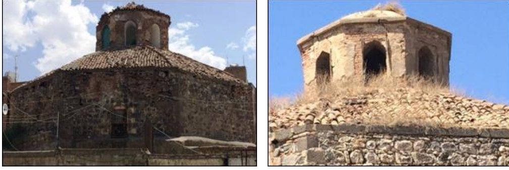
Şekil 4.79. Melik Ahmet Hamamı ile Deva Hamamı duvarlarındaki ayrışma ve çözülme hasarları
