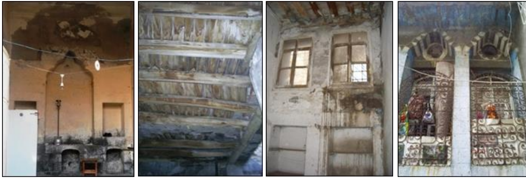
Şekil 4.142. Diyarbakır evlerinde neme bağlı duvar, cephe ve üst örtüde oluşan hasarlar
