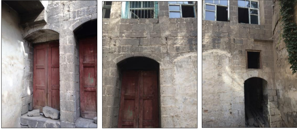
Şekil 4.341. Geleneksel Diyarbakır Evi güney kanadındaki lento ve kemerlerde oluşan hasarlar
