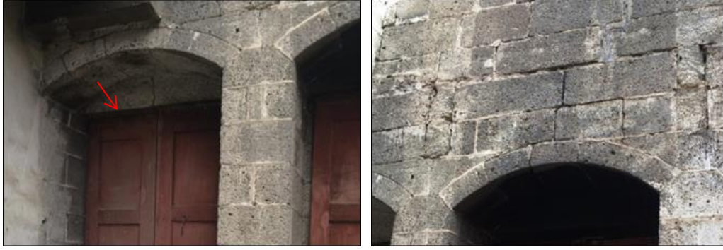
Şekil 4.133. Geleneksel Diyarbakır Evinde kemer ve lentolarda oluşan ayrışma ve çatlak hasarları
