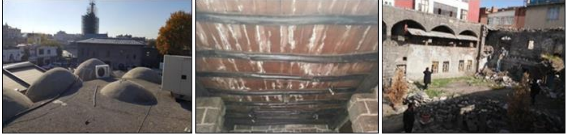
Şekil 4.68. Hasan Paşa kubbesindeki çatlaklar ile Sülüklü Han ahşap döşemesindeki sehim hasarları
