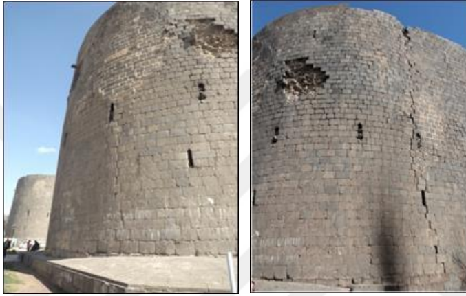
Şekil 4.256 Urfa Kapı 22 No'lu burcun batı ve güney cephesindeki çatlaklar
