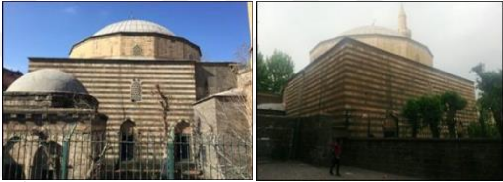
Şekil 4.292. İskender Paşa Camii doğu ve batı cephe duvarlarında oluşan kirlenme, derz boşalması ve harç kaybına bağlı oluşan hasarlar
