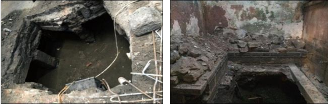
Şekil 4.84. Çardaklı ve Deva Hamamlarında sıcaklık ve ılıklik bölümlerinde çöken döşemeler
