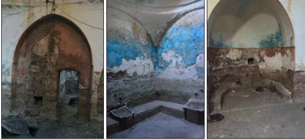
Şekil 4.323. Deva Hamamı soğukluk, sıcaklık ve halvet oda duvarlarında oluşan hasarlar
