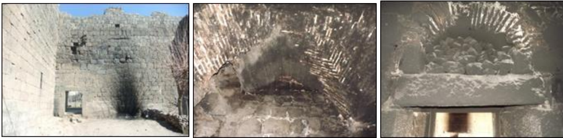
Şekil 4.18. 20-30 numaralı burç ve sur duvarlarında ateş yakılarak oluşan malzeme kaybı hasarları
