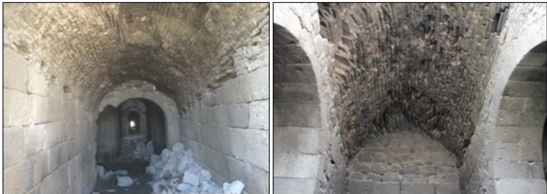
Şekil 3.40. Tonozlarda oluşan malzeme kaybı, derz boşalması ve yangın hasarları
