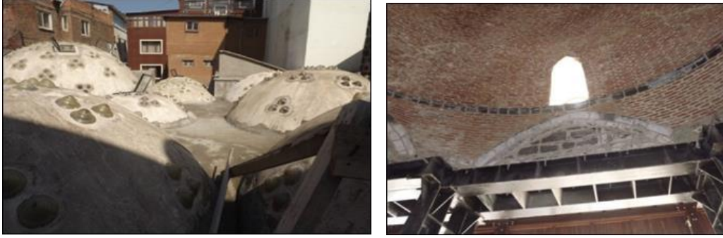
Şekil 4.95.Vahap Ağa Hamamında yapı eleman kaybıyla oluşan hasarlar
