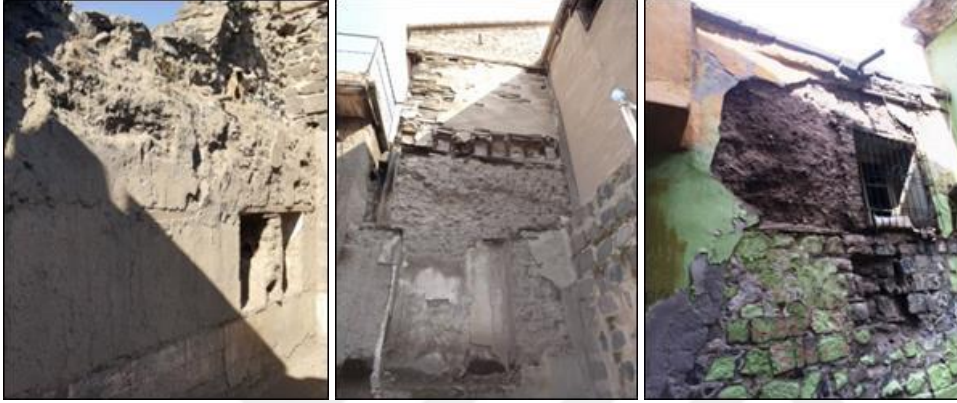
Şekil 3.48. Kerpiç malzeme ile yapılan duvarlarda malzeme kaybı ve ayrışma hasarları
