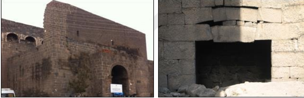
Şekil 4.13.Urfa Kapı ve 57-58 burç arasındaki sur duvarındaki ayrışma ve aks kayma hasarları
