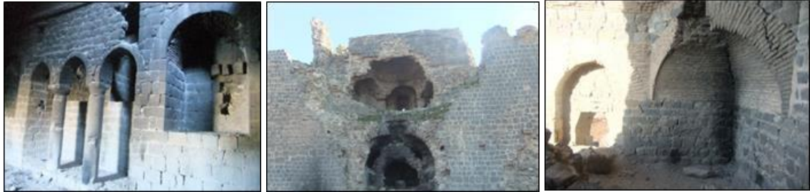
Şekil 4.8. 39-56-58 numaralı burçlardaki kemer ve örgü elemanlarında çatlak malzeme kaybı ve ayrışma hasarları
