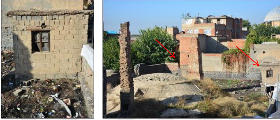
Şekil 4.326. Deva Hamamı duvar ve üst örtüsünün üzerindeki niteliksiz eklentiler
