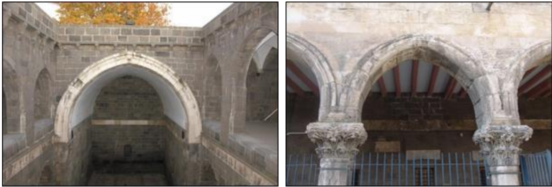
Şekil 4.118. Mesudiye Medresesinde doğa koşullarına bağlı oluşan yosun tutma kirlenme ve duvarlarda tuzlanmaya bağlı bozulmalar
