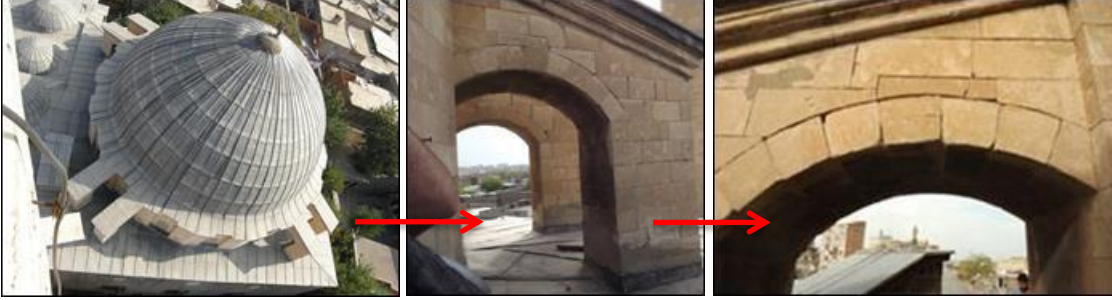
Şekil 3.32. Behram Paşa Cami kubbe kasnağını destekleyen kemerli payandalarda ayrışma hasarları
