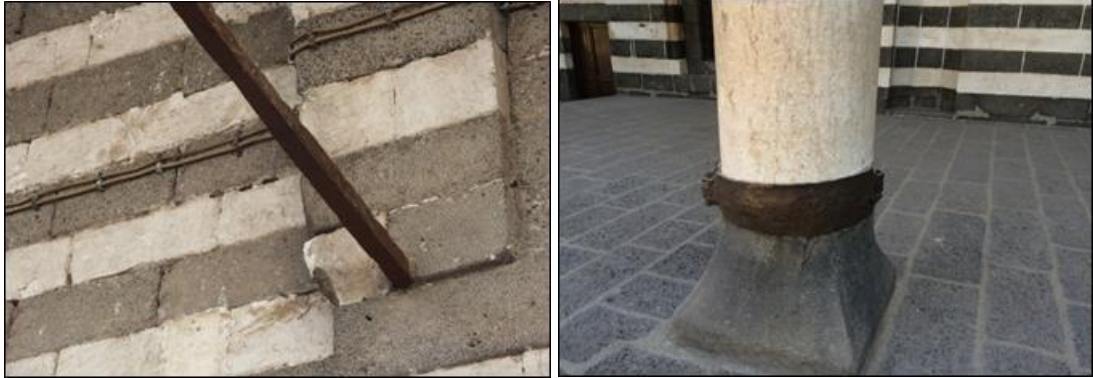
Şekil 3.54. Gergi kirişi ve sütun çemberinde (bilezikler) görülen korozyona bağlı bozulmalar
