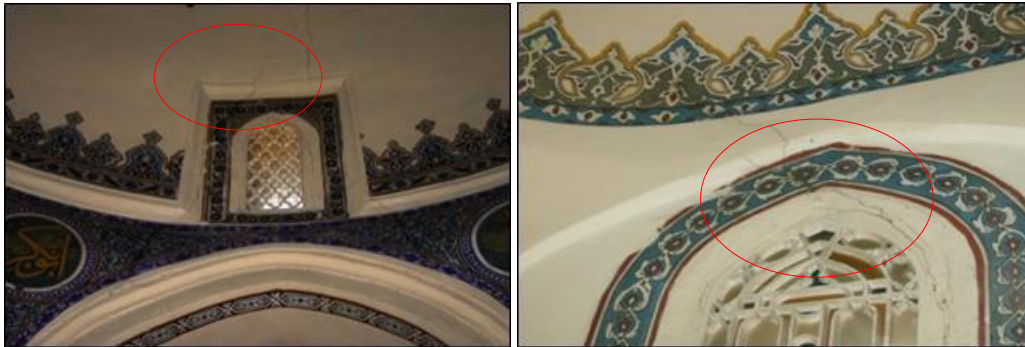
Şekil 4.43. Melik Ahmet Cami kubbesinde zemine bağlı oluşan çatlak hasarları
