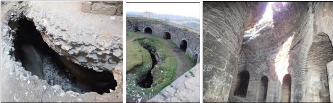
Şekil 4.257. 22 No'lu burcun üst örtüsünde göçme hasarı sonucu oluşan yarıklar
