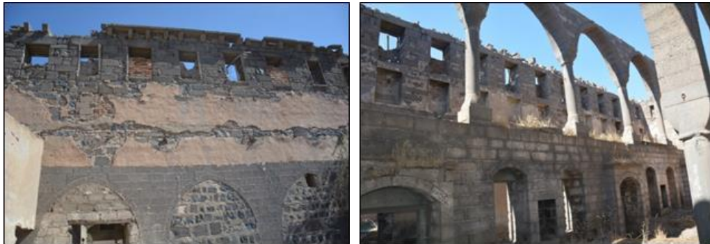
Şekil 4.271. Surp Sargis Kilisesi iç ve dış cephe duvarlarındaki malzeme kaybı hasarları
