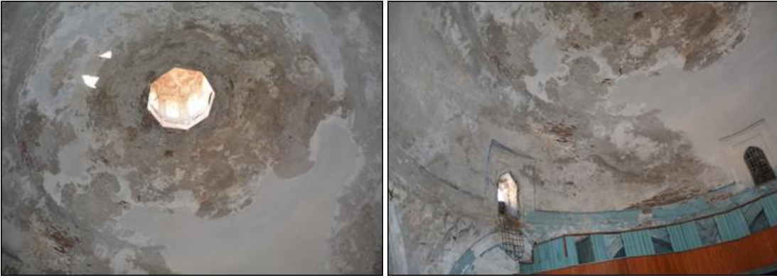
Şekil 4.319. Deva Hamamı soğukluk bölümündeki kubbe fenerinde oluşan nemlenme sorunları
