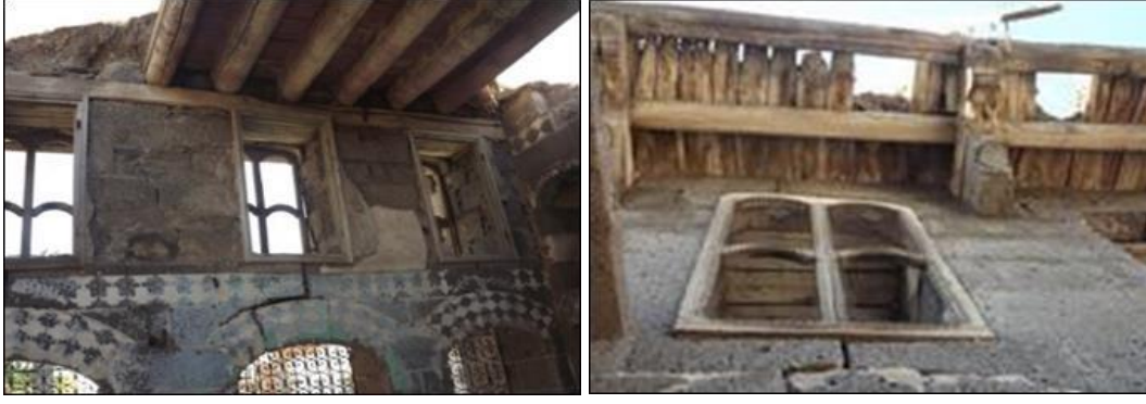
Şekil 4.135. Diyarbakir evlerinde üst örtüde oluşan hasarlar
