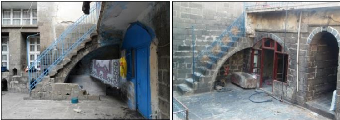
Şekil 4.132. Merdivenleri taşıyan kemerlerde açılmalara bağlı oluşan hasarlar
