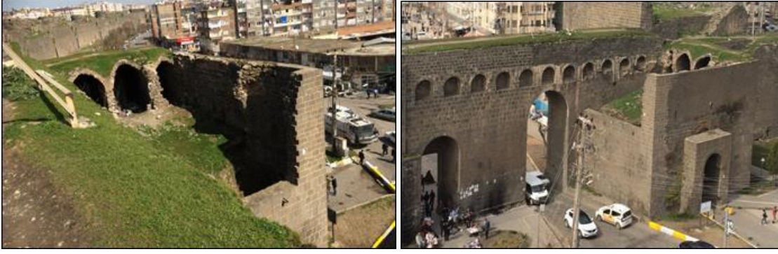
Şekil 4.258. Urfa Kapı kuzey kapısının yıkılan güney duvarı
