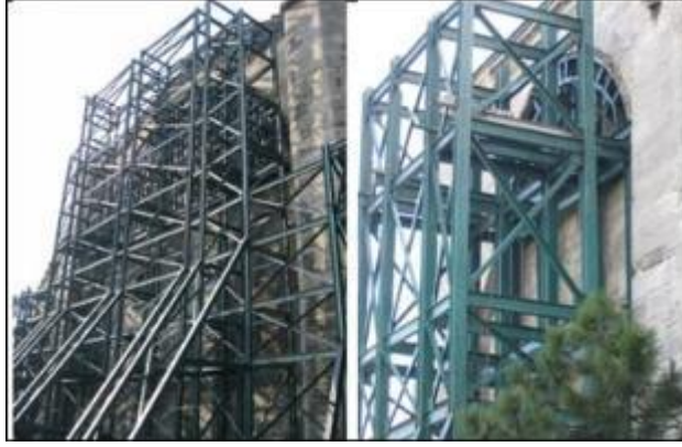
Şekil 3.79. Statik bozulmaya uğramış duvarların geçici acil müdahaleyle askıya alınması (Çelik 2014)
