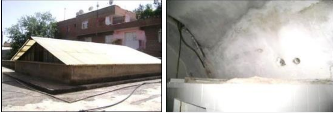
Şekil 4.113. Zinciriye Medresesi betonarme üst örtü ve ıslak hacimlerde hatalı restorasyon nedeniyle neme bağlı oluşan hasarlar (VBM Arşivi 2015)
