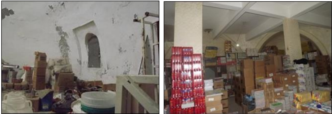
Şekil 4.91. Melik Ahmet Paşa Hamamında onarım sonrası oluşan taşıyıcı sistem hasarları
