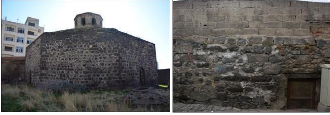
Şekil 4.322. Deva Hamamı soğukluk bölümü kubbe çevresindeki çevre duvarı ile kuzey cephe duvarında oluşan malzeme kaybı hasarları
