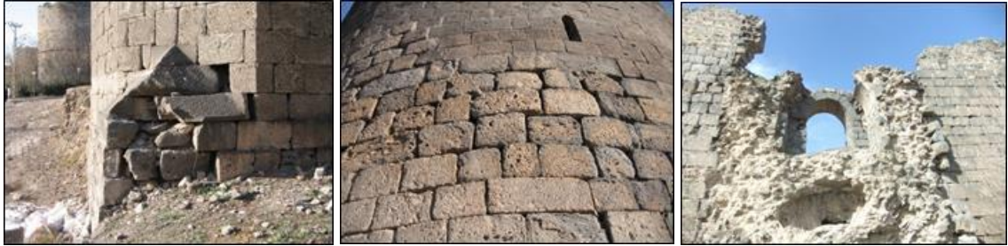
Şekil 4.22. 48-49 ve 51 numaralı burçlardaki harç kaybına bağlı oluşan hasarlar
