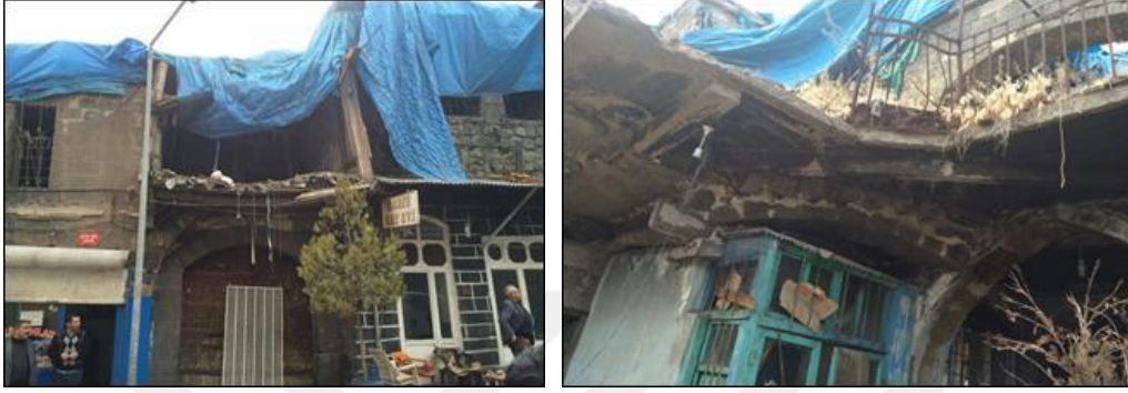
Şekil 4.312. Yıkılan cumba ve giriş aralığı üzerinde yapılan betonarme saçak
