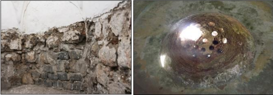
Şekil 4.99.Çardaklı Hamamı duvarları ve Deva hamamı kubbelерinde oluşan harç kayıp hasarları
