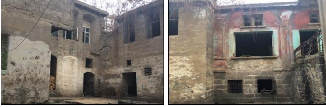
Şekil 4.150. Geleneksel Diyarbakır Evi'nde kullanıcıya bağlı duvarlarda oluşan hasarlar
