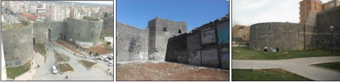
Şekil 4.16. Sur diplerindeki peysaj düzenlemelerine bağlı nemlenme hasarları
