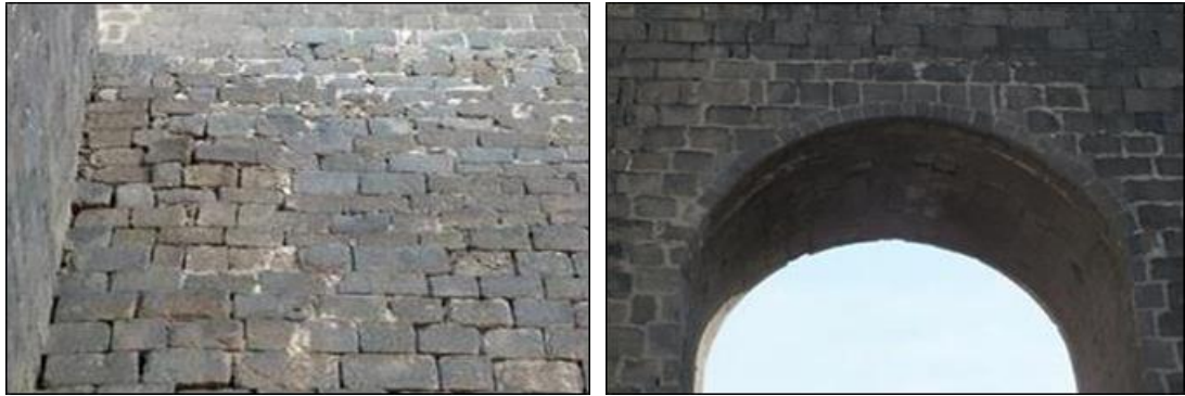
Şekil 3.47. Trafik titreşimine bağlı duvarlarda oluşan ayrışma, harç kaybı ve şişme hasarları
