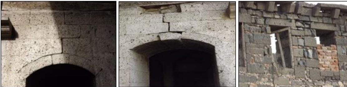
Şekil 4.29.Sarp Sargis Kilisesinde oluşan eksen kaymasına bağlı hasarlar
