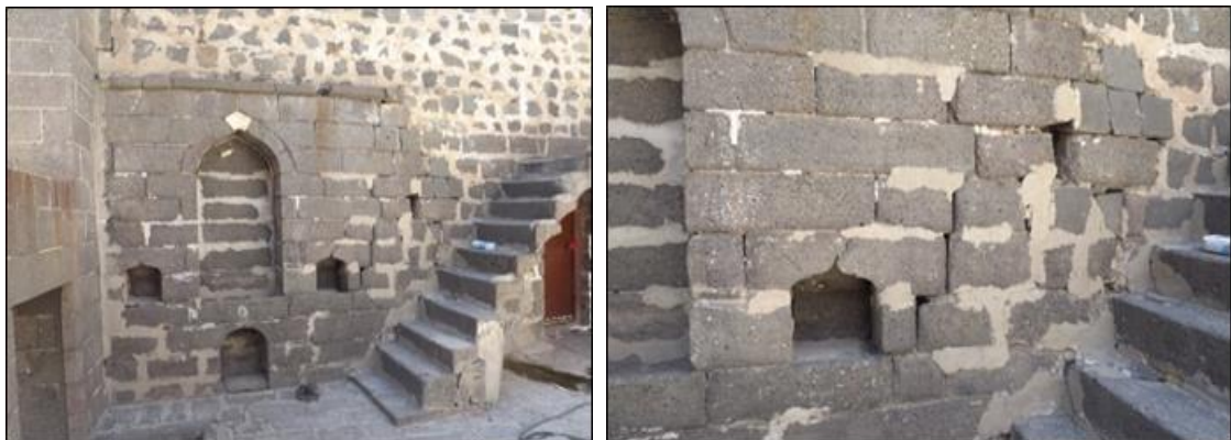
Şekil 4.138. Diyarbakır evlerinde derz boşalmalarına bağlı oluşan ayrışma hasarları
