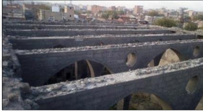
Şekil 4.269. Surp Sargis Kilisesi'nde yıkılan ahşap kirişli üst örtüsü (Ekim 2017)
