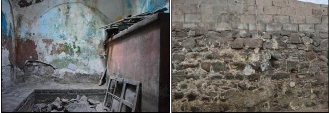
Şekil 4.324. Deva Hamamı iç ve dış duvarlarda oluşan nem, tuzlanma ve malzeme kaybı hasarları
