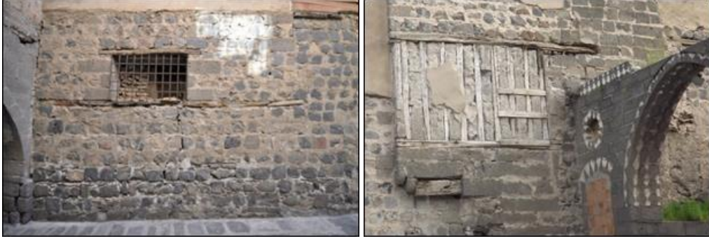
Şekil 3.36. Duvarlarda ahşap lento ve hatılarda çürümeye bağlı ayrışma hasarları
