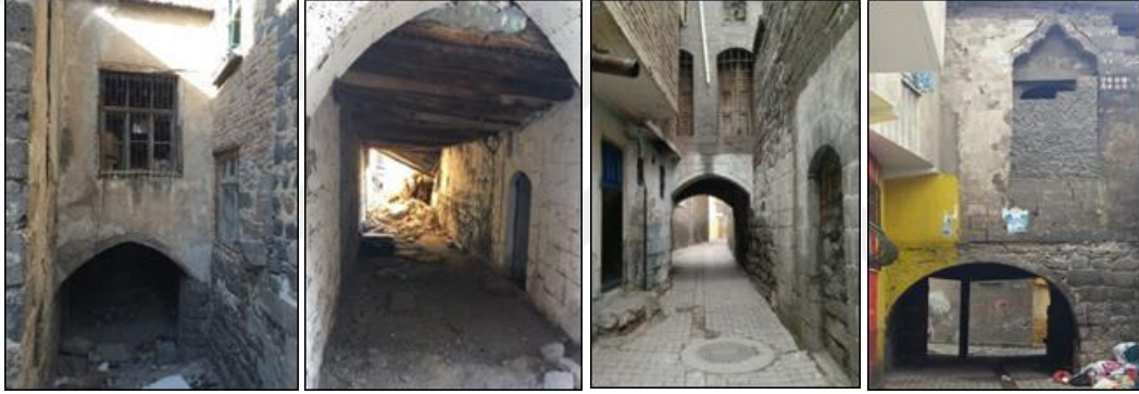
Şekil 4.153. Sokaklarda doğa koşulları ve bakımsızlık nedeniyle hasarlı kabaltılar
