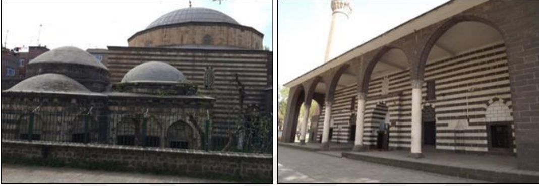
Şekil 4.289. İskender Paşa Cami doğu ve kuzey cephesinde oluşan hasarlar
