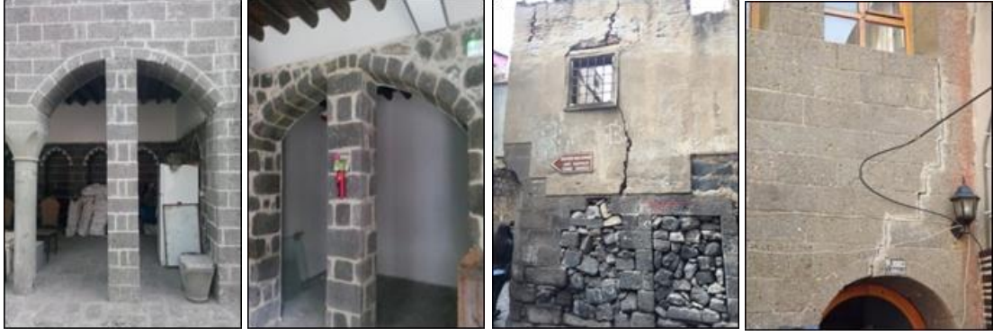
Şekil 4.145. Evlerde hatalı restorasyon uygulamaları ve oluşan hasarlar
