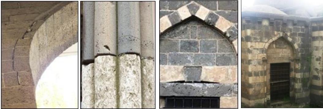
Şekil 4.57. Camilerdeki harçların boşalması ve yok olmasına bağlı oluşan hasarlar
