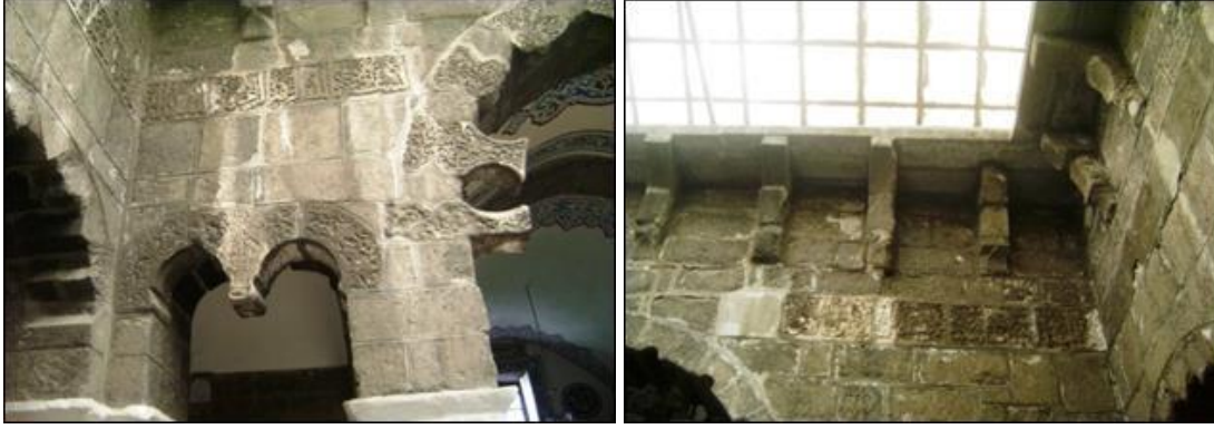
Şekil 4.119. Zinciriye Medresesinde bakımsızlık-doğa koşullarına bağlı oluşan, duvarlarda tuzlanma, ayrışma, çözülme ve harç kaybı hasarları
