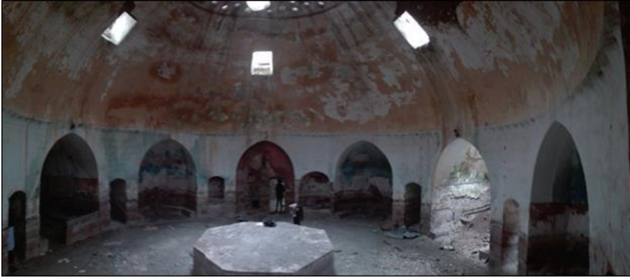
Şekil 4.92. Deva Hamamı'nda kullanıcılar tarafından yapılan onarımlar sonrası duvar ve kubbelerde oluşan hasarlar
