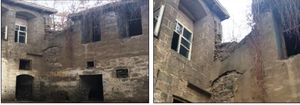
Şekil 4.141. Geleneksel evde eksen kaymasına bağlı oluşan hasarlar
