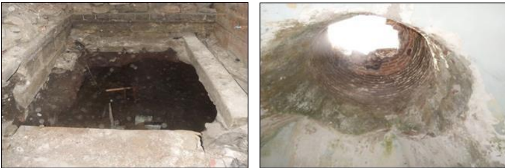
Şekil 4.97. Deva Hamamı'nda döşeme ve kubbede oluşan yapı elemanı kaybı hasarları
