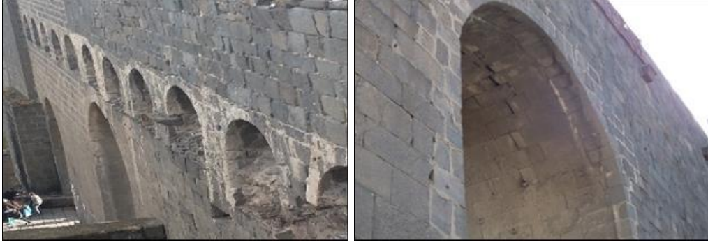
Şekil 4.9. 21-22. Burçlar arasındaki Urfa Kapı kemer ve örgü elemanlarındaki ayrışma hasarları
