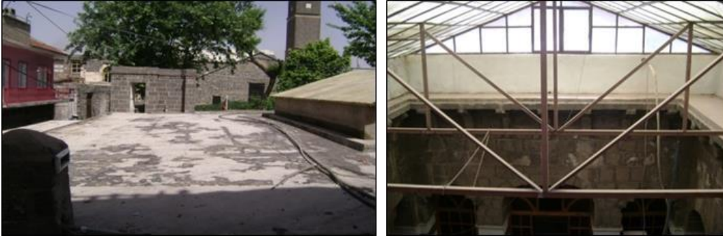
Şekil 4.106. Zinciriye Medresesinde restorasyon öncesi yük düzensizliğine neden olan betonarme döşeme ve döşeme üstündeki çelik elemanlar
