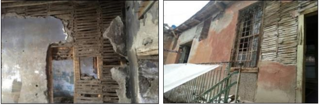
Şekil 4.129. Bağdadi yapım tekniği kullanılan duvarlarda görülen malzeme kaybı hasarları
