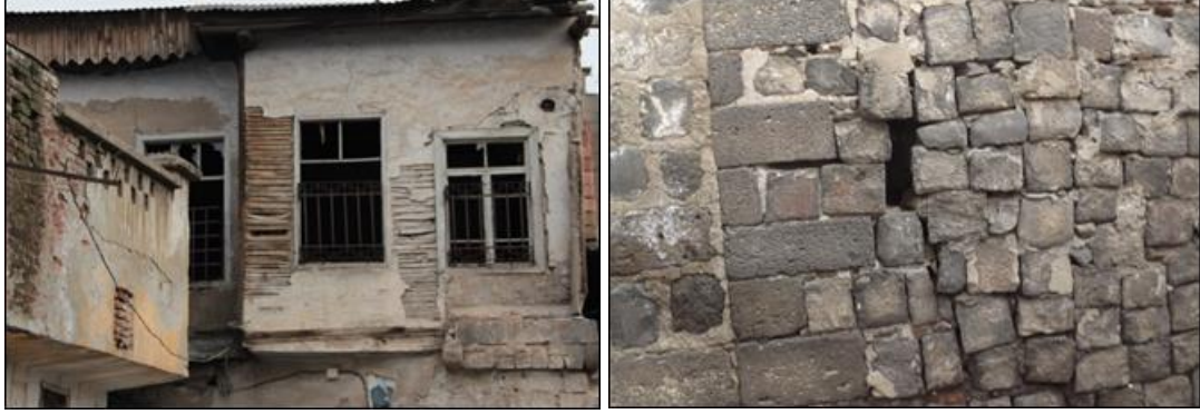
Şekil 3.53. Yapılarda sıva ve harç kaybına bağlı oluşan hasarlar
