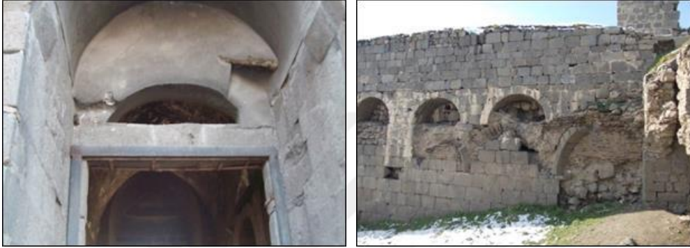
Şekil 4.260.Urfa Kapı kuzey kapısı üzerindeki beton kaplamalar ile kapının birinci katındaki hasarlı ve doldurulmuş kemerli nişler
