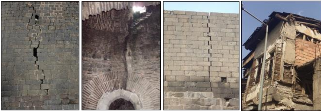
Şekil 3.29. Duvarlarda oluşan ayrışma hasarları
