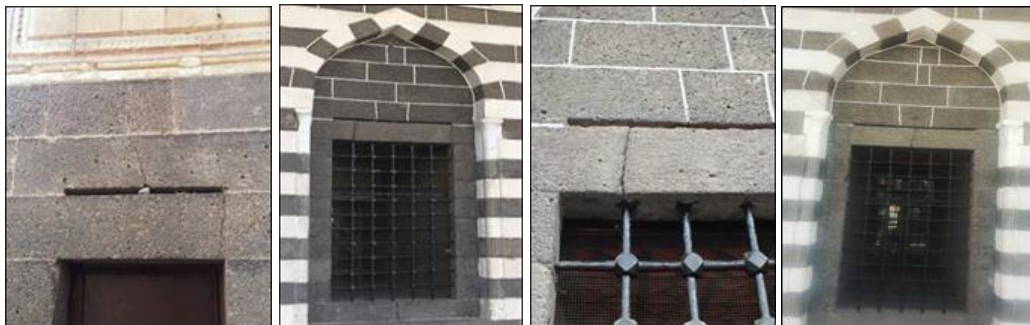
Şekil 4.41. İskender Paşa Cami lentolarında oluşan çatlak hasarları
