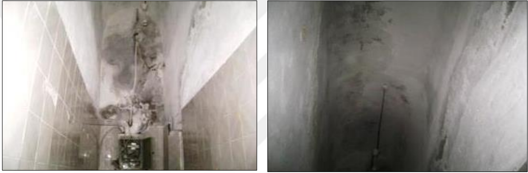
Şekil 4.110. Zinciriye Medresesi iç duvar ve tonozlarda neme bağlı oluşan hasarlar
