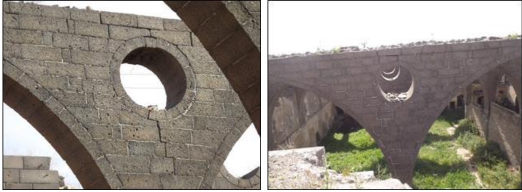
Şekil 4.273. Surp Sargis Kilisesi tempan yüzeylerde oluşan derz boşalması ayrışma hasarları
