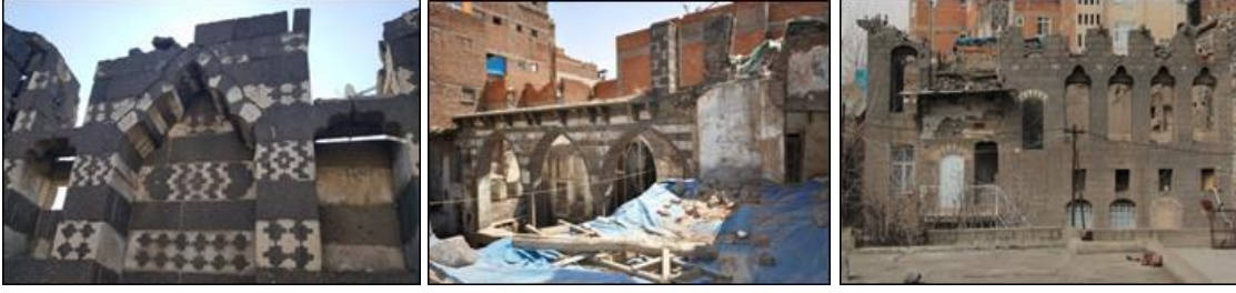
Şekil 4.154. Diyarbakir evlerinde yapı elemanı kayıplarıyla oluşan taşıyıcı sistem hasarları
