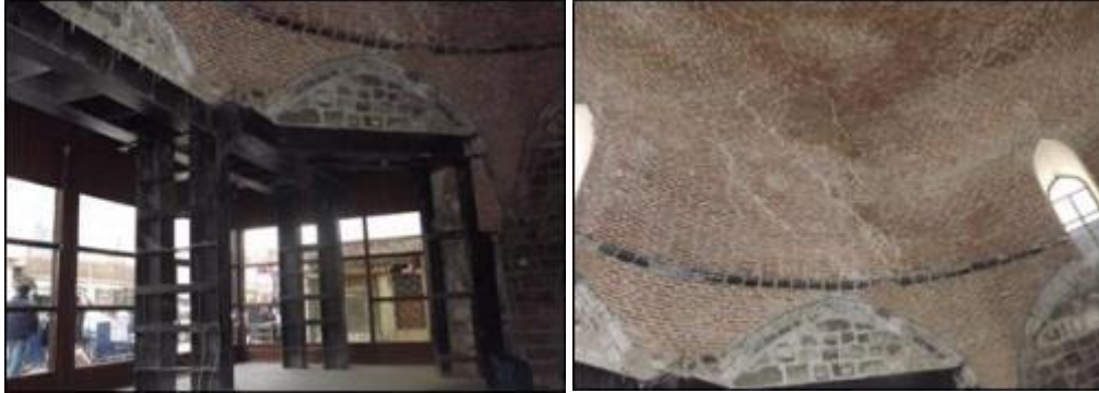
Şekil 4.86.Vahap Ağa Hamamı'ndaki giriş ve soğukluk bölümündeki hatalı restorasyona bağlı kubbede oluşan çatlak hasarları
