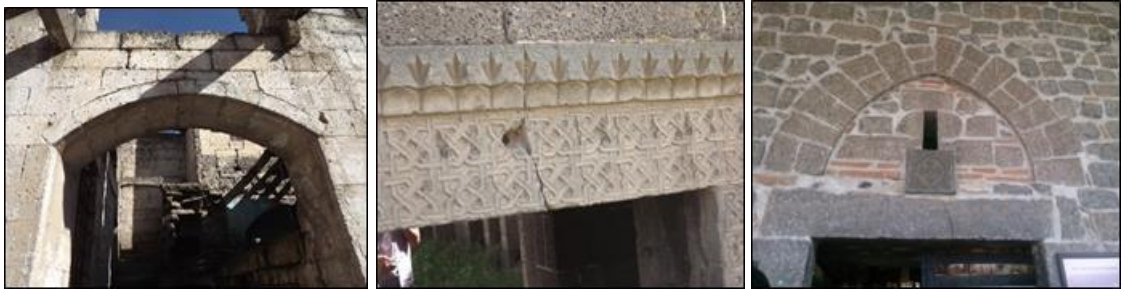
Şekil 4.25.Mar Petyum Keldani Kilisesi, Surp Sargis Kilisesi, Meryem Ana Kilisesi kemer ve lentolarında oluşan çatlak, ayırışma ve malzeme kayıpları
