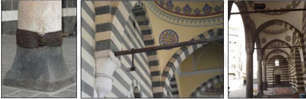
Şekil 4.56. Camilerde gergi çubuk ve bileziklerdeki korozyona bağlı oluşan hasarlar
