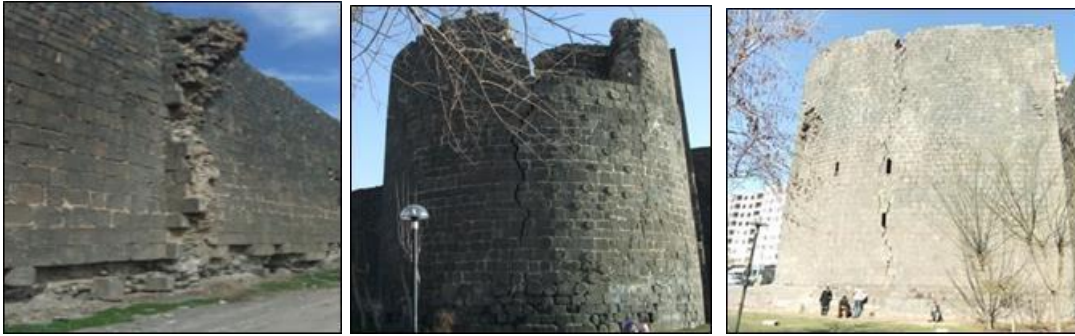
Şekil 4.6. Burçlar ve sur duvarları ile payandalardaki ayrışma hasarları (51-52, 20-20')
