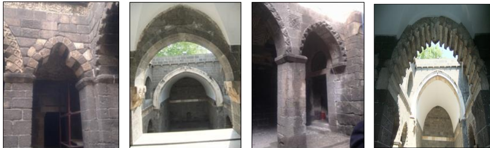
Şekil 4.107. Mesudiye Medresesinde restorasyon öncesi oluşan derz boşalma hasarları
