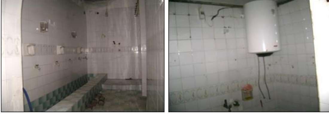
Şekil 4.115. Zinciriye Medresesinde kullanıcılar tarafından taş duvarların seramikle kaplanması ve hatalı tesisat uygulamaları
