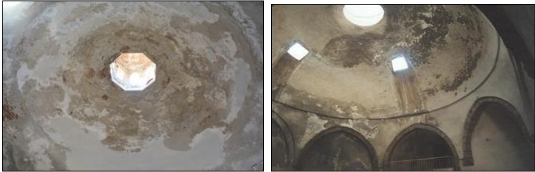
Şekil 4.85. Deva ve Çardaklı Hamamı iç ve dış cephede neme bağlı oluşan bitkilenme hasarı
