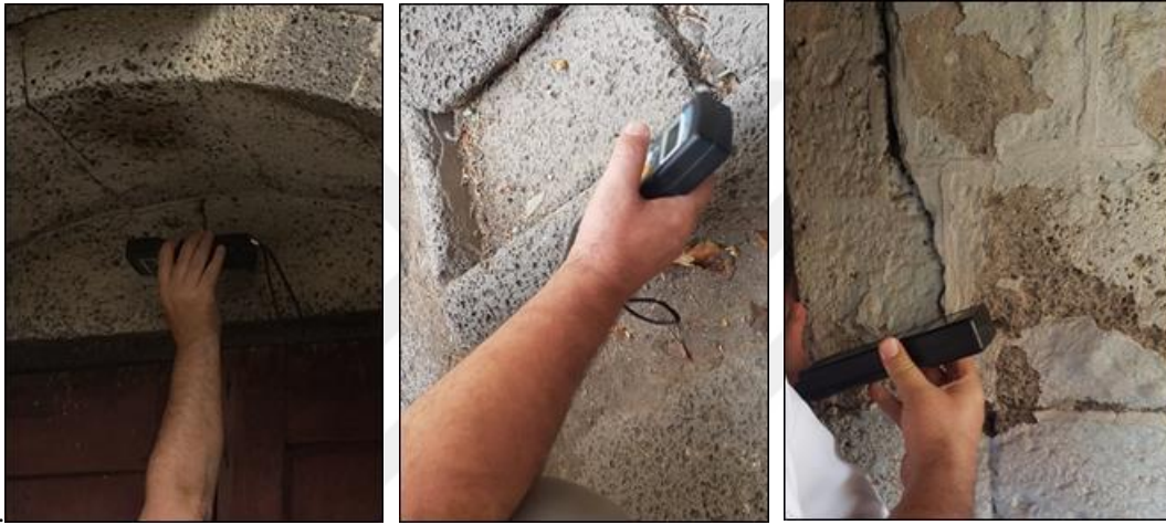
Şekil 4.228. Geleneksel Diyarbakır Evinde arasındaki çatlak değişimi ölçümleri
