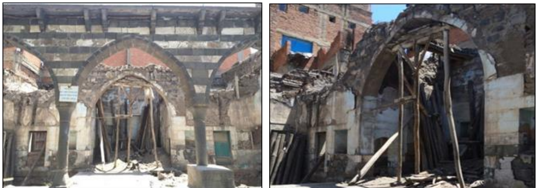
Şekil 4.130. Diyarbakır Evlerinde kemerlerde oluşan açılma ve yıkılma hasarları
