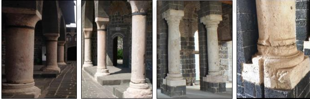
Şekil 3.33. Sütunlarda oluşan hasarlar
