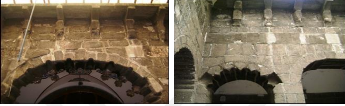
Şekil 4.108. Zinciriye Medresesinde derz boşalmalarına bağlı oluşan hasarlar (VBM Arşivi 2015)
