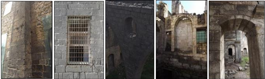
Şekil 4.27. Diyarbakır kiliselerinde derz boşalmalarına ve malzeme kaybına örnekler (Latin, Saint George, Mar Petyum ve Surp Sargis Kiliseleri)
