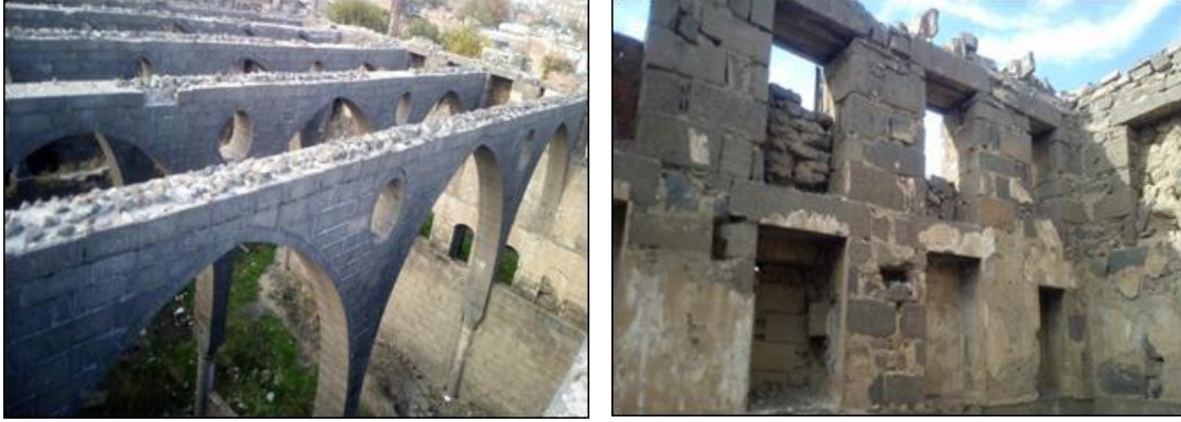
Şekil 4.278. Surp Sargis Kilisesi'nde yıkılan üst örtüye bağlı oluşan hasarlar
