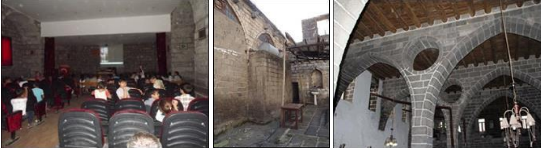
Şekil 4.33. Latin, Mar Petyum Keldani ve Ermeni Katolik Kiliselerinde kullanıcı kaynaklı hasarlar
