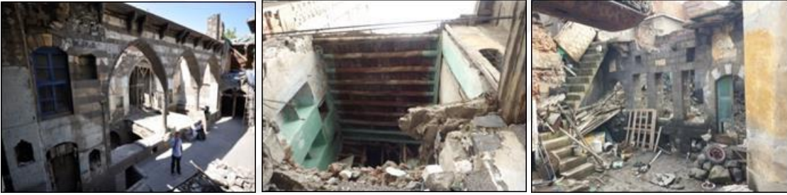
Şekil 4.151. Diyarbakır evlerinde doğa koşulları ve bakımsızlığa bağlı oluşan hasarlar
