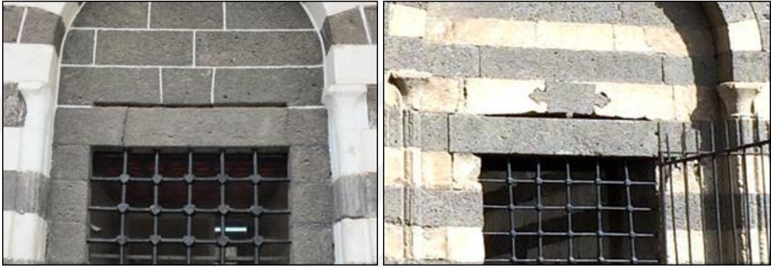
Şekil 4.296. İskender Paşa Camii lentolarında oluşan çatlak hasarları
