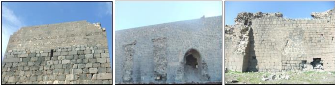
Şekil 4.12. 54-55-46 numaralı burçlardaki derz boşalmaları ve malzeme kayıpları
