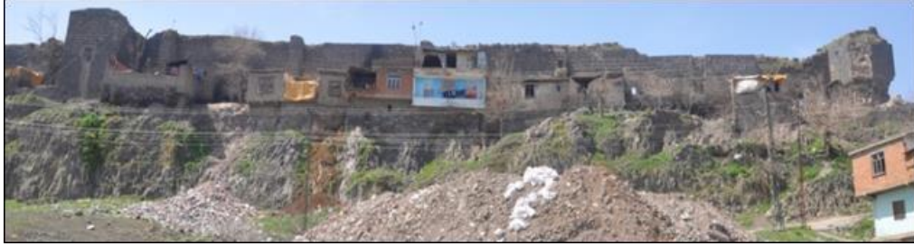
Şekil 4.17. 66-67 numaralı burçlar arasında sur duvarlarındaki kullanıcıya bağlı müdahale ve hasarlar
