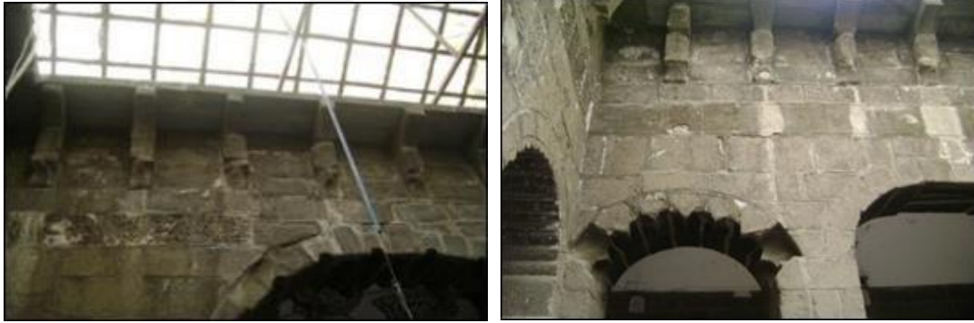
Şekil 4.102. Zinciriyeye Medresesi restorasyon öncesinde duvarlarda tuzlanmaya bağlı oluşan hasarlar
