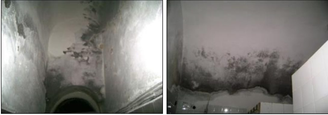
Şekil 4.116. Zinciriye Medresesinde tesisat ve neme bağlı oluşan hasarlar
