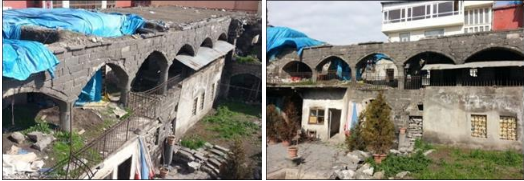
Şekil 4.311. Çifte Han kuzey revak kemerlerinde ayrışma aks kayması hasarları
