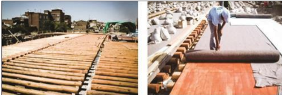
Şekil 4.247. Surp Giragos Kilisesi üst örtüsünün ahşap kirişlerle tamamlanması ve geotekstil serilerek yalıtım uygulaması (Halifeoğlu 2012)
