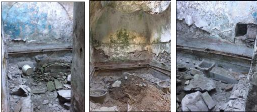
Şekil 4.333. Deva Hamamı halvet odalarındaki döşeme hasarları
