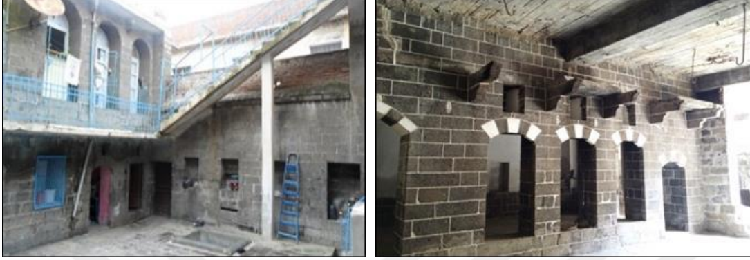
Şekil 4.147. Diyarbakır evlerinde hatalı restorasyon uygulamaları ve oluşan hasarlar
