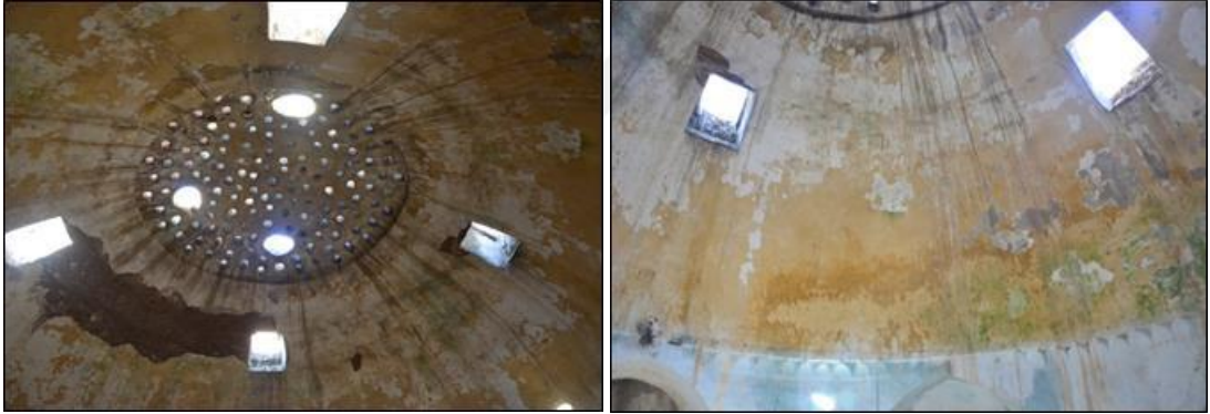
Şekil 4.331. Deva Hamamı sıcaklık kubbesindeki fil gözleri ile pencerelerdeki hasarlar
