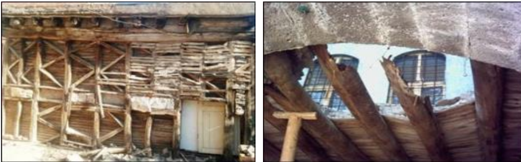
Şekil 4.152. Doğa koşulları ve bakımsızlığa bağlı ahşap kiriş ve ahşap duvarlarda oluşan hasarlar
