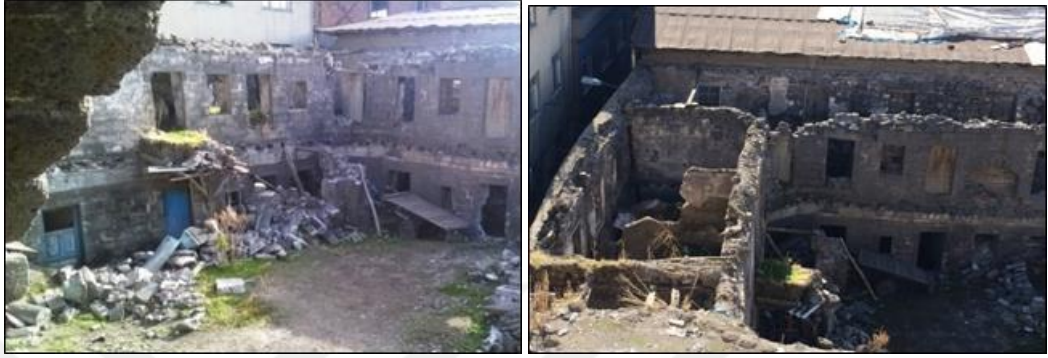
Şekil 4.307. Çifte Han doğu duvarı iç ve dış duvarlarındaki hasarlar
