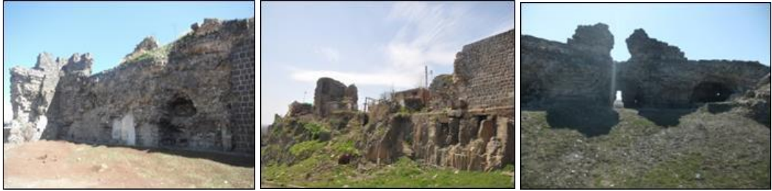
Şekil 4.19. 31-63 ve 64 numaralı burçlarda doğa koşulları ve bakımsızlık nedeniyle oluşan hasarlar
