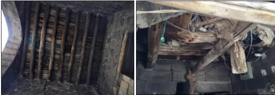
Şekil 3.21. Ahşap malzemede neme bağlı oluşan çürüme, çatlama ve tuzlanma hasarları
