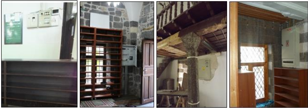
Şekil 4.52. Camilerde restorasyon sonrası hatalı tesisat uygulamaları
