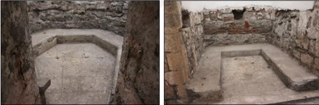
Şekil 4.89. Çardaklı Hamamında kullanıcılar tarafından döşemeler üzerinde yapılmış beton sekiler
