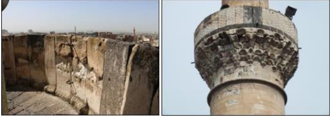
Şekil 4.293. İskender Paşa Cami minare şerefelerinde oluşan parça kopması ve malzeme kaybı hasarları
