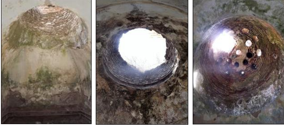
Şekil 4.332. Deva Hamamı ılıklik, halvet odalarındaki kubbe ve fil gözlerindeki hasarlar
