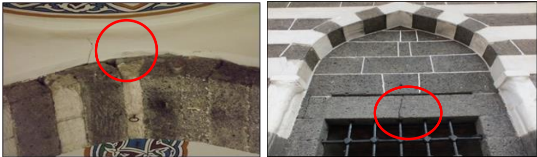
Şekil 4.288. İskender Paşa Cami kubbe ve pencere lentolarındaki çatlak hasarları
