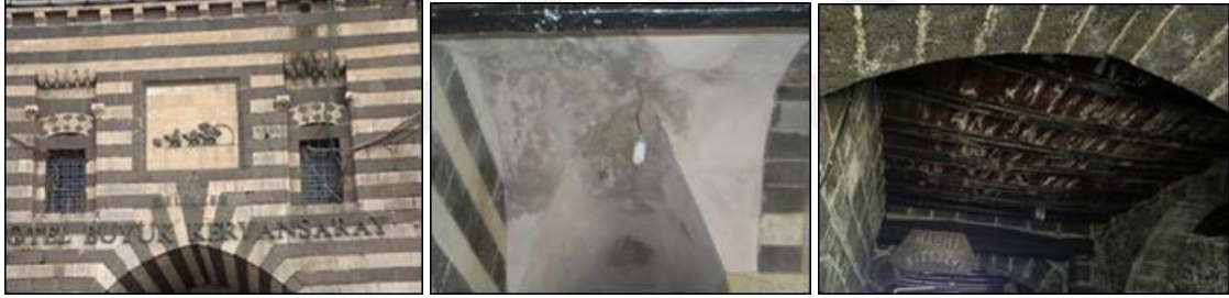
Şekil 4.72. Hüsrev Paşa, Hasan Paşa ve Sülüklü Han'da neme bağlı oluşan hasarları
