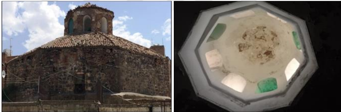
Şekil 4.94. Melik Ahmet Hamamı aydınlık fenerinde oluşan ayrışma ve malzeme kaybı hasarları
