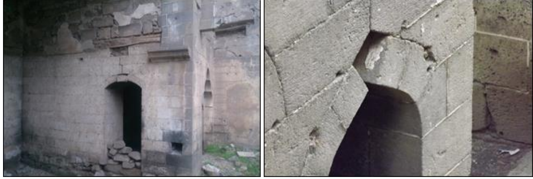
Şekil 4.280. Kemerlerde oluşan aks kayması, ayrışma ve malzeme kaybı hasarları
