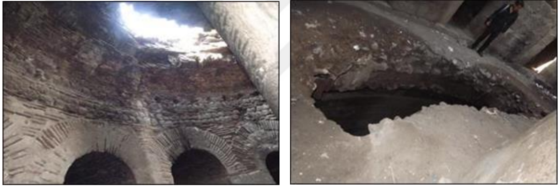
Şekil 4.259. Burçlardaki ayrışma hasarları ve strüktürel bozulmalar (22 no'lu burç)
