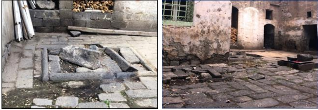
Şekil 4.137. Geleneksel Diyarbakır Evinde avlu ile döşemelerde oluşan oturma ve çökme hasarları
