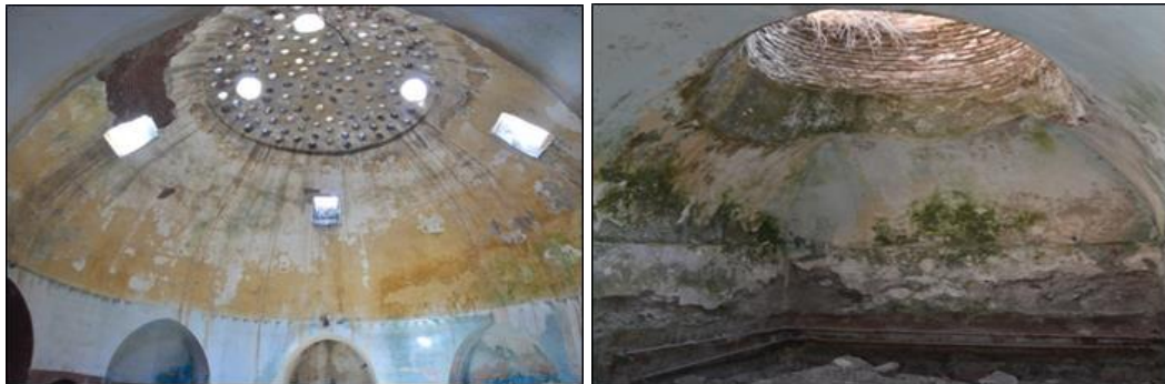
Şekil 4.321. Deva Hamamı sıcaklık bölümü eyvan, kubbe ve halvet odalarındaki hasarlar
