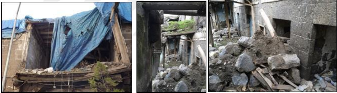
Şekil 4.75. Çifte Han'da doğa koşulları ve bakımsızlığa bağlı oluşan yıkılma hasarları
