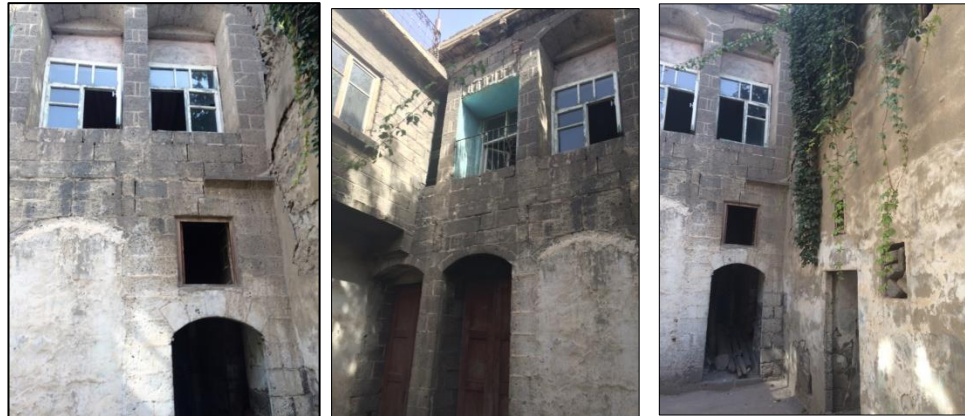
Şekil 4.340. Geleneksel Diyarbakır Evi güney ve batı kanadındaki duvarlarda oluşan hasarlar
