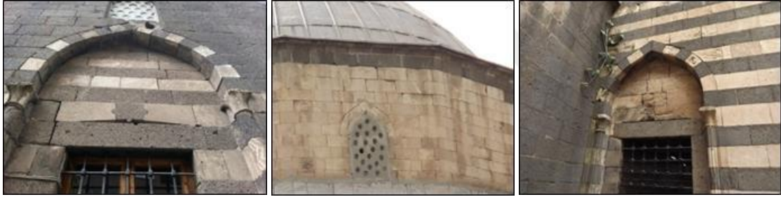
Şekil 4.44. İskender Paşa ve Behram Paşa Camilerinde derz boşalmalarına bağlı oluşan ayrışma hasarları
