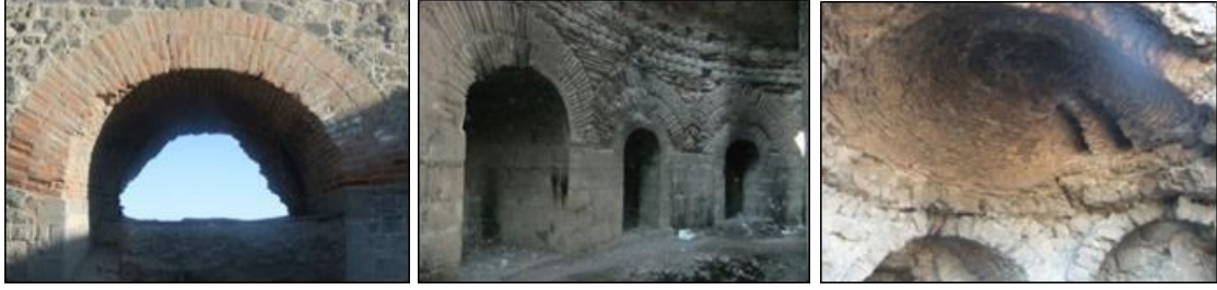
Şekil 4.5. 49-50 no'lu burçlar arasındaki sur duvarında ve 21nolu burç içindeki tuğla kemerler ve 56 no'lu burcun tuğla malzemedan yapılmış kubbesi
