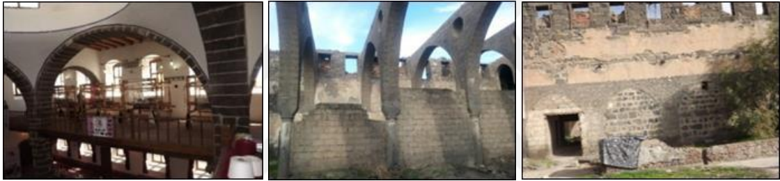
Şekil 4.34. Protestan ve Surp Sargis Kiliselerinde kullanıcı kaynaklı oluşan hasarlar
