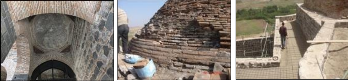
Şekil 4.31. Saint George Kilisesi kubbeye oluşan nem sorunları donatılı beton dam yapımı
