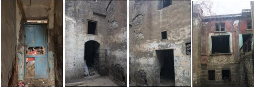
Şekil 4.144. Geleneksel Diyarbakır Evi'nde neme bağlı duvarlarda oluşan hasarlar
