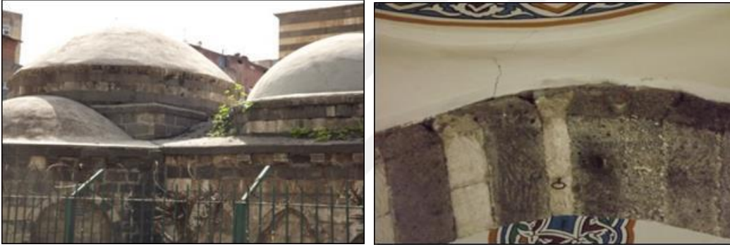
Şekil 4.42. İskender Paşa ve Parlı Safa Camilerinde kubbelerdeki nem ve çatlak hasarları
