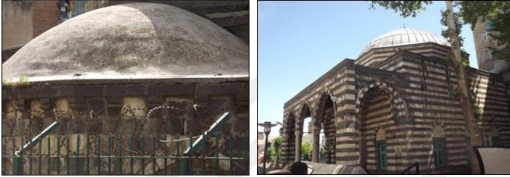
Şekil 4.49. İskender Paşa ve Şeyh Mutaahhar Camide restorasyon sonrası yapılan betonarme döşeme nedeniyle oluşan ayrışma, nem ve biyolojik kirlilik hasarları
