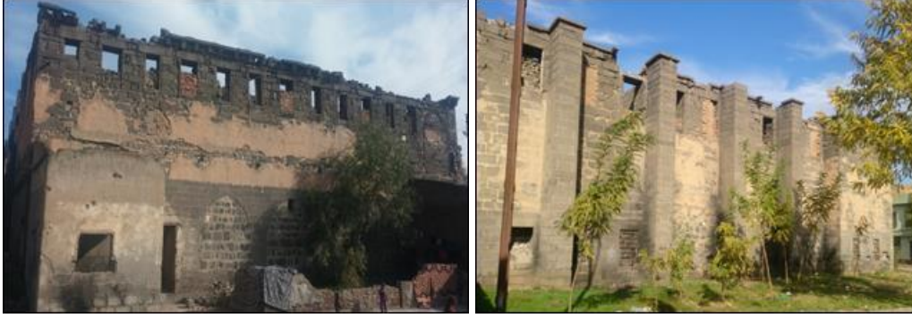
Şekil 4.281. Surp Sargis Kilisesi cephe duvarlarındaki sıva ve dolgular
