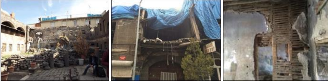
Şekil 4.76. Çifte Han kuzey cephesindeki çöken cumba, taş ve bağdadi duvarlarda harç ve yapı elemanı kayıpları
