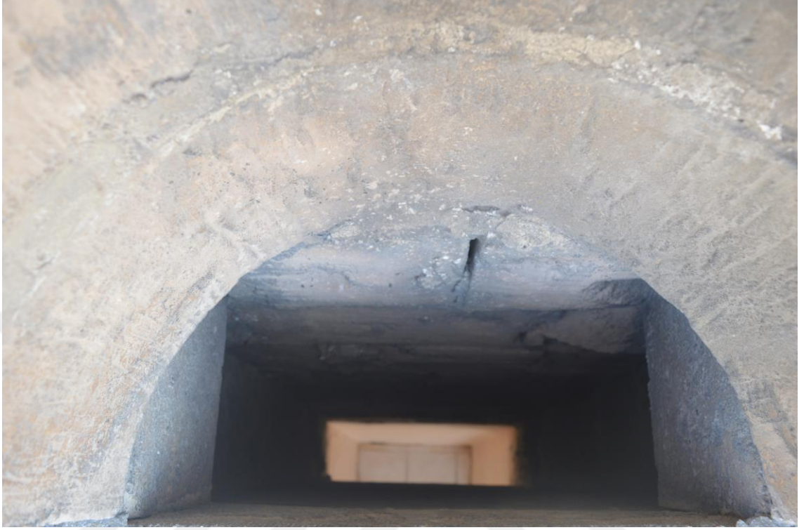
Şekil 4.55. Hava Kanalının Damdan (Üstten) Görünümü (Melikoğlu 2018)
