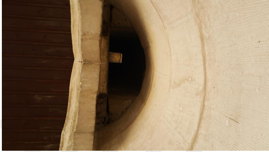
Şekil 4.28. Ortadaki Nişte Bulunan Havalandırma Kanalı'nın Alttan Görünümü (Melikoğlu 2018)
