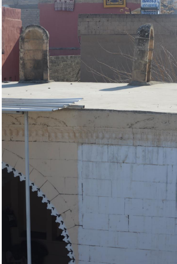
Şekil 4.61. Sonradan Yapılan Beton Kaplama ile Kotu Yükseltilen Dam (Melikoğlu 2018)
