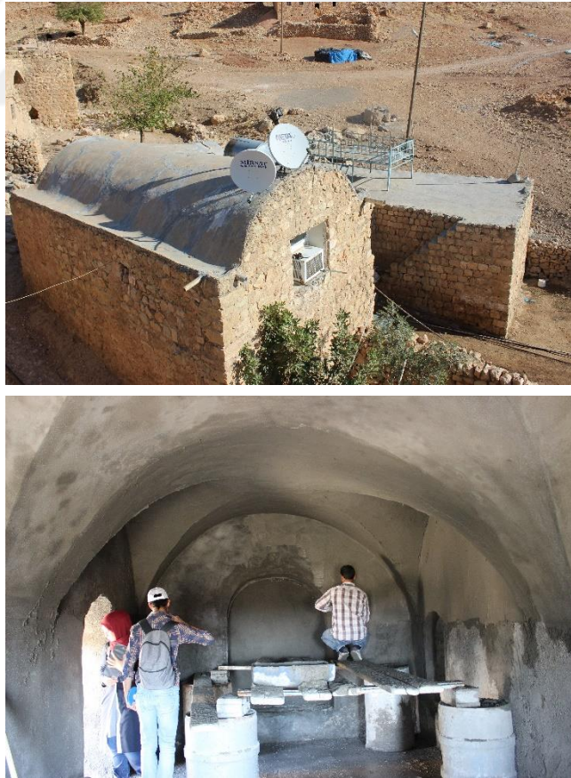
Şekil 5.17: Yapılara koruma amacı ile uygulanan niteliksiz malzeme
