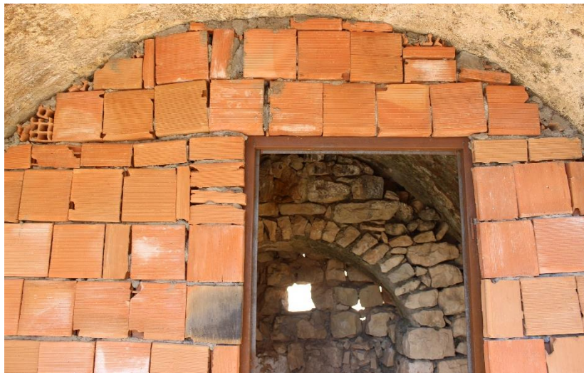
Şekil 5.10: Çimentolu malzemeler ile müdahale yapılmış duvarlar (Ö.Yıldız, 2018)
