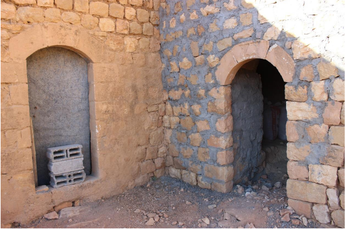
Şekil 5.16: Çimento malzemesi ile müdahale yapılmış yapı (Ö.Yıldız, 2018)
