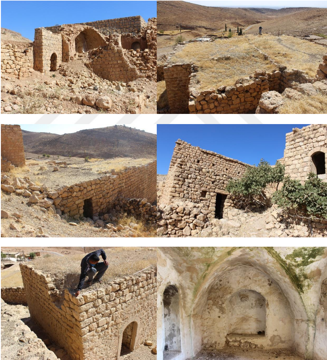
Şekil 5.9 : Yapılarda görülen bozulmalar (Ö.Yıldız, 2018)
