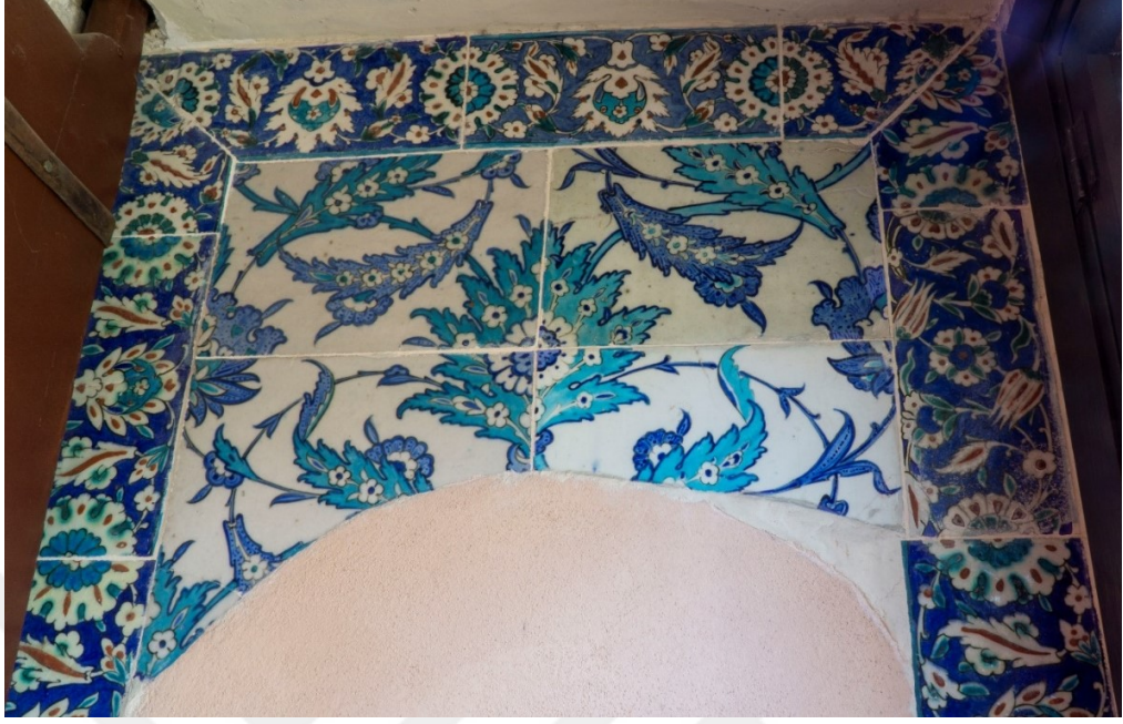
Resim 3.26. Pencerelelerin kapak arkası çinilerinin bu günkü durumu. (Foto: Betül Öztürk Arşivi).
