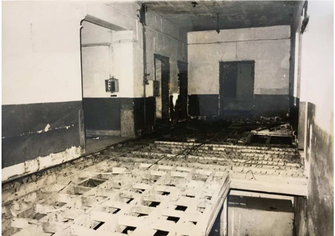
Şekil 4.5 Yapının Değiştirilmiş Salon Döşemesi ve Sonradan Eklenen Merdiven Boşluğu (İstanbul 1 Numaralı KVKBK)
