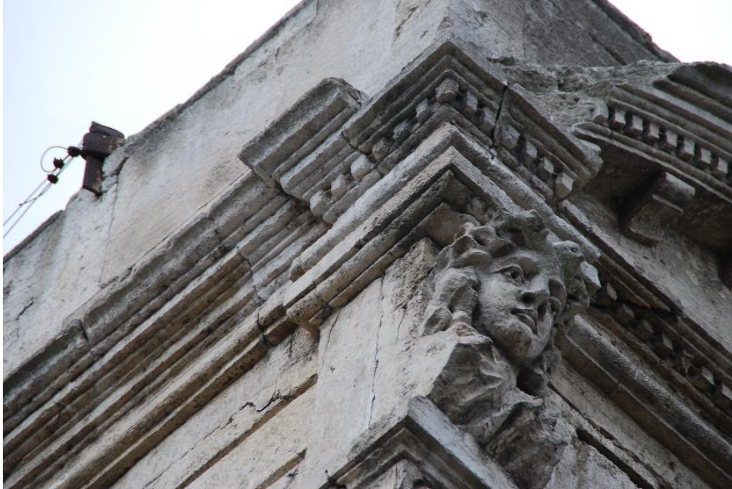
Şekil 3.125 Saat Kulesi Malzeme Erozyonu ve Parça Kopmaları (2018)
