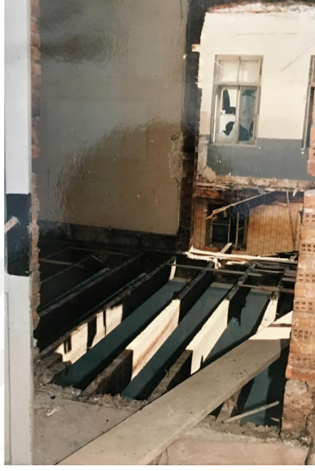
Şekil 4.18 1982 Yılı Yapının Yıkılan Ahşap Döşemeleri (İstanbul 1 Numaralı KVKBK)
