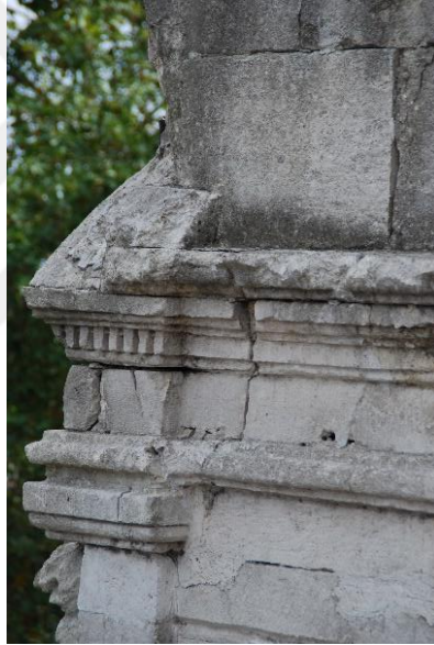
Şekil 3.124 Yapı Cephesindeki Bazı Çatlak ve Kırıklar (2018)
