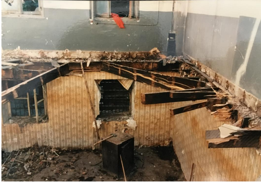
Şekil 4.19 1982 Yılı Yapının Yıkılan Ahşap Döşemeleri (İstanbul 1 Numaralı KVKBK)
