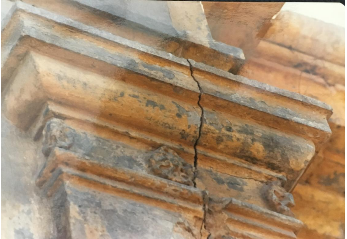
Şekil E.28 Cephe Plasteri, 1985 (İstanbul 1 Numaralı KVKBK)
