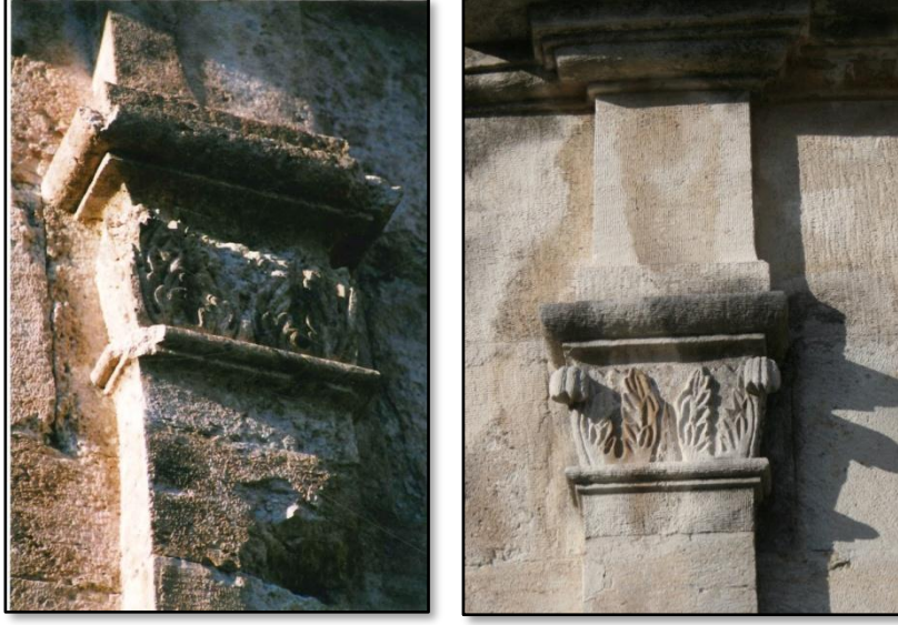
Şekil 124: Pencerenin Sol Yanındaki Pilastr - 2003 Restorasyon Öncesi / 2017
