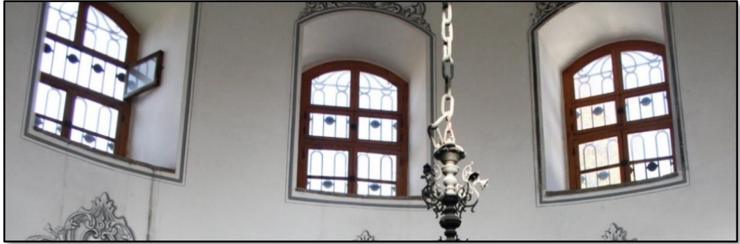
Şekil 111: Üst Pencere Tabanlarındaki Tuğla - 2001 Restorasyon Öncesi / 2017
