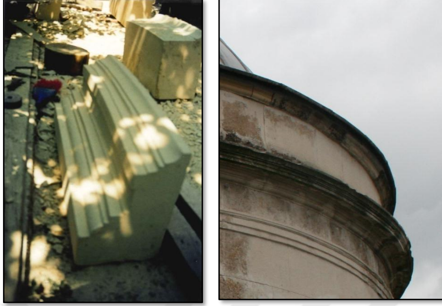
Şekil 126: Profilli İmitasyon Kubbe Alt Silmesi - 2003 Restorasyon Öncesi / 2017
