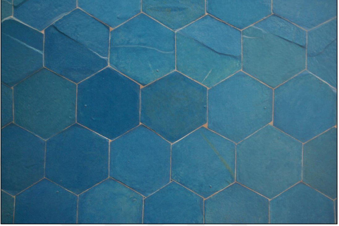
R.57: Bursa Muradiye Camii Batı Duvarı Güney Yönlü Pencerenin Solunda Kalan Çinilerden Bir Detay
