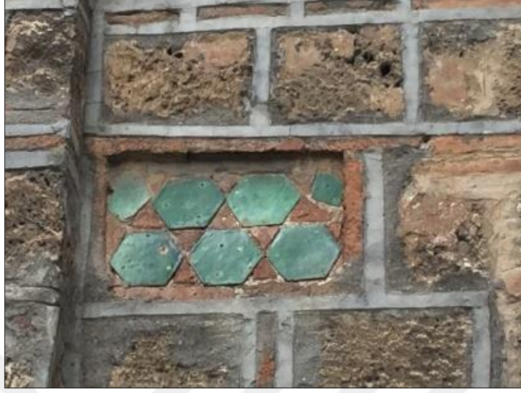
Resim 6: Bursa Orhan Bey Camii Mihrap duvarının Doğusunda Bulunan Pencerenin Sol Tarafı
