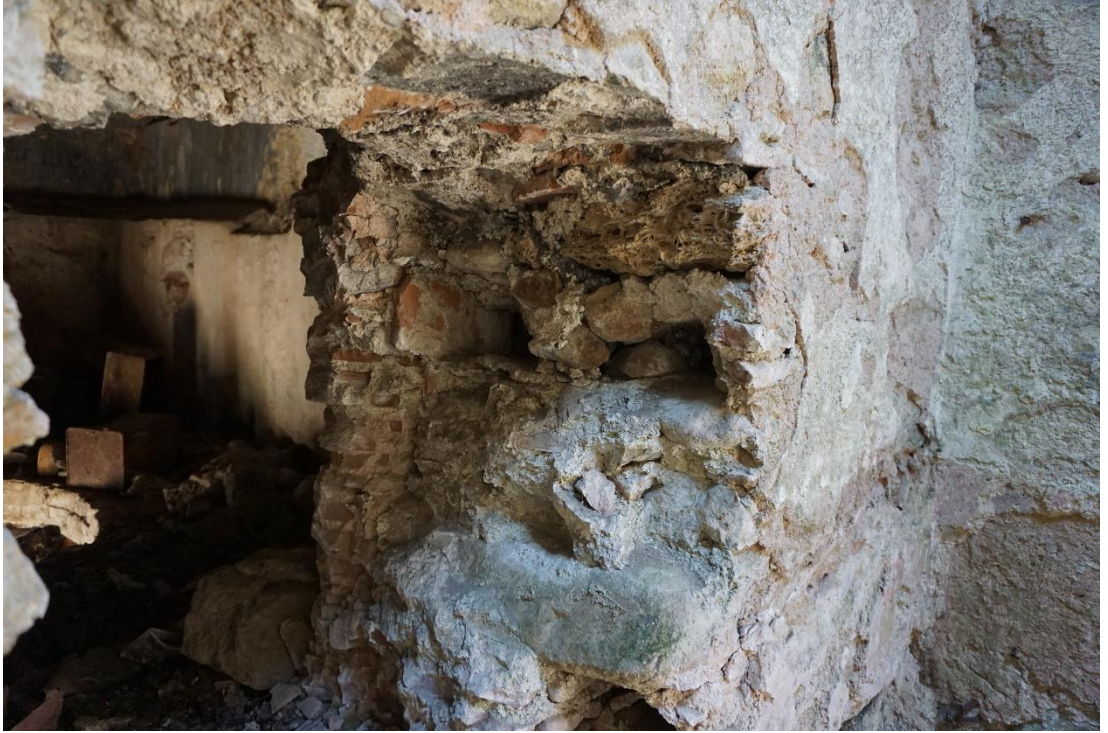
Şekil 17 : Z03 Su Deposu Doğu Duvarındaki Açıklığın Görünüşü (F. Terzi 2018)
