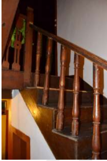
Şekil B. 99. Fevkâni katı ikinci kata bağlayan merdiven korkuluğu (Eylül, 2018).
