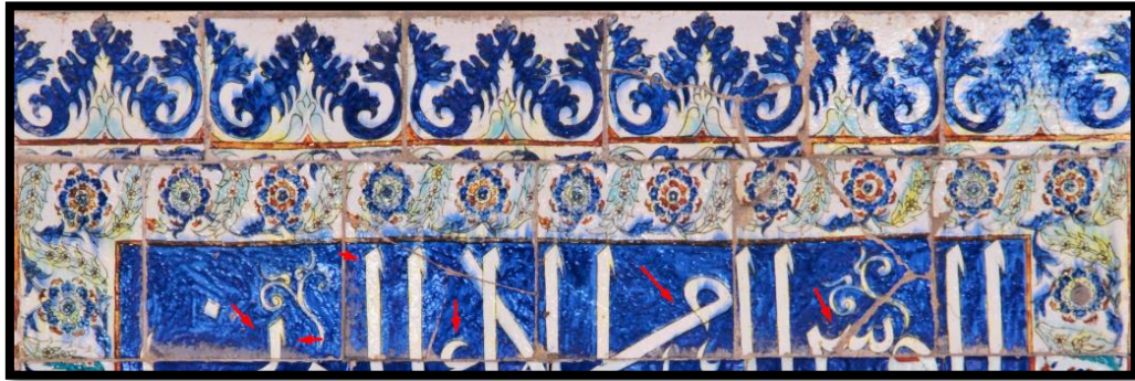
Fotoğraf 139: Hatalı restore edilen kısım
