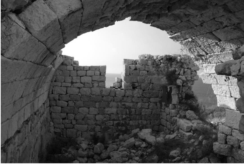
Şekil C. 73. Yapının kapı açıklığının bulunduğu güney duvarı, 2017 (©BOGA Arşivi).
