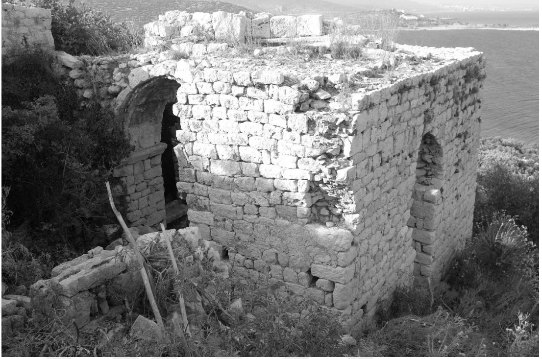
Şekil C. 45. Narteksin doğu duvarına köşeden bakış. Duvarın güney köşesinde bozulmuş kemer izi görülmektedir, 2010 (©BOGA Arşivi).
