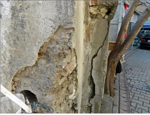
Şekil 2.75. Çeşme üzerinde bulunan çatlaklar (Özge Tokur, 2019)
