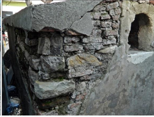
Şekil 2.76. Çeşmede bulunan hasarlar (Özge Tokur, 2019)
