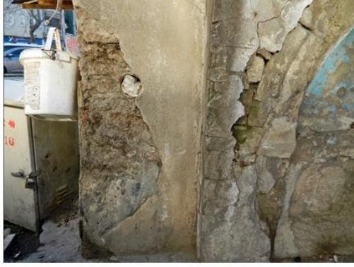
Şekil 2.69. Çeşme üzerinde oluşan bazı kırıklar (Özge Tokur, 2019)
