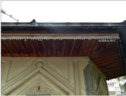
Şekil 2.105. Çeşmenin saçaklarında oluşan kırılmalar (Özge Tokur, 2019)
