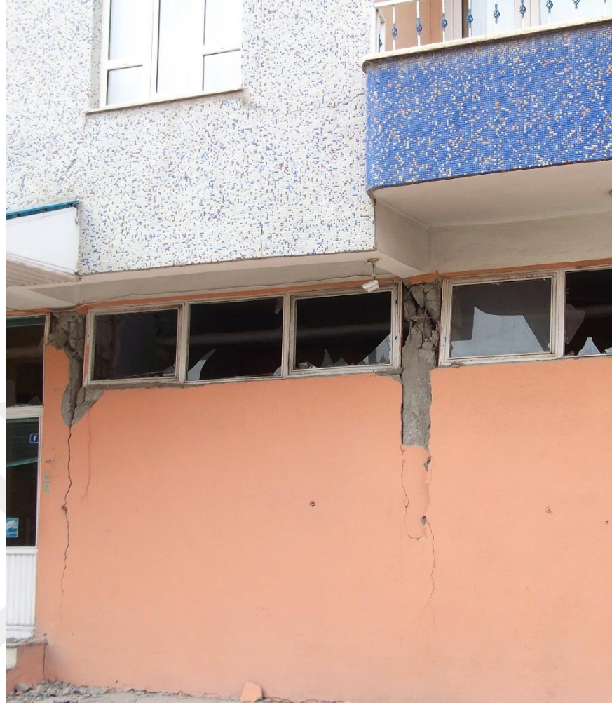
Şekil 1. 2. 2011 Van depremi kısa kolon kesme hasarı (Doç. Dr. İdris Bedirhanoğlu'nun arşivinden alınmıştır.)
