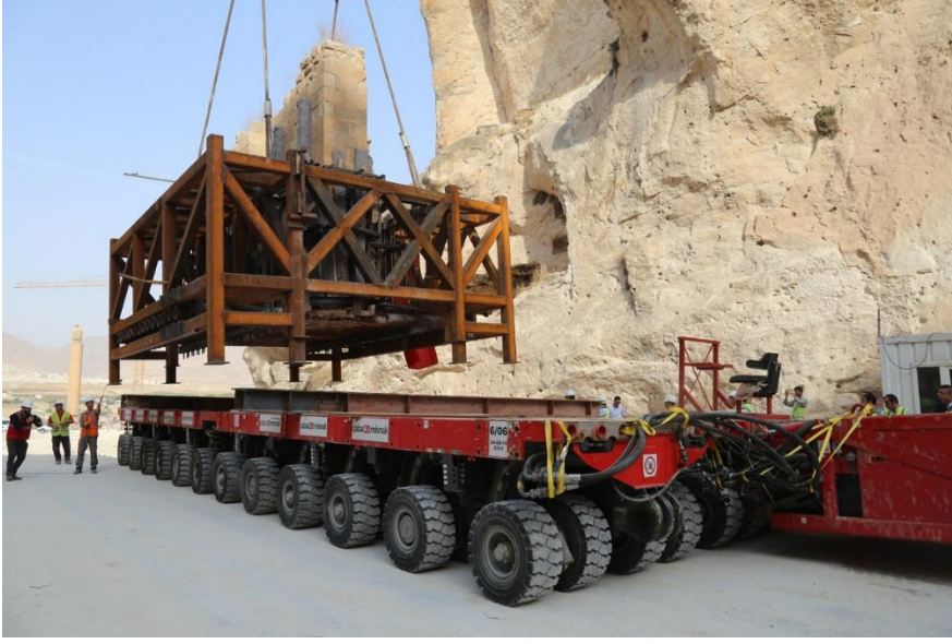
Resim 3. 36- Orta Kapı'nın kesilen bir bloğunun vinç yardımı ile SPTM aracına yerleştirilmesi, Hasankeyf-2018 ( http://bolge16.dsi.gov.tr )
