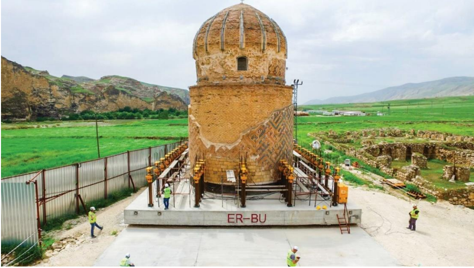
Resim 3. 10- Zeynel Bey türbesi, düşey yönde kaldırma için yerleştirilmiş hidrolik krikolar (Sevgi, Çetin, Yılmaz,2017)
