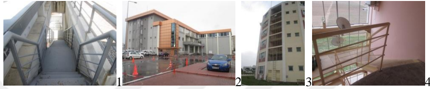
Şekil 4.30. Hibrit 1 (1), Tekno 3 (2) ve Yazılımkule (3 ve 4) yangın merdivenleri
