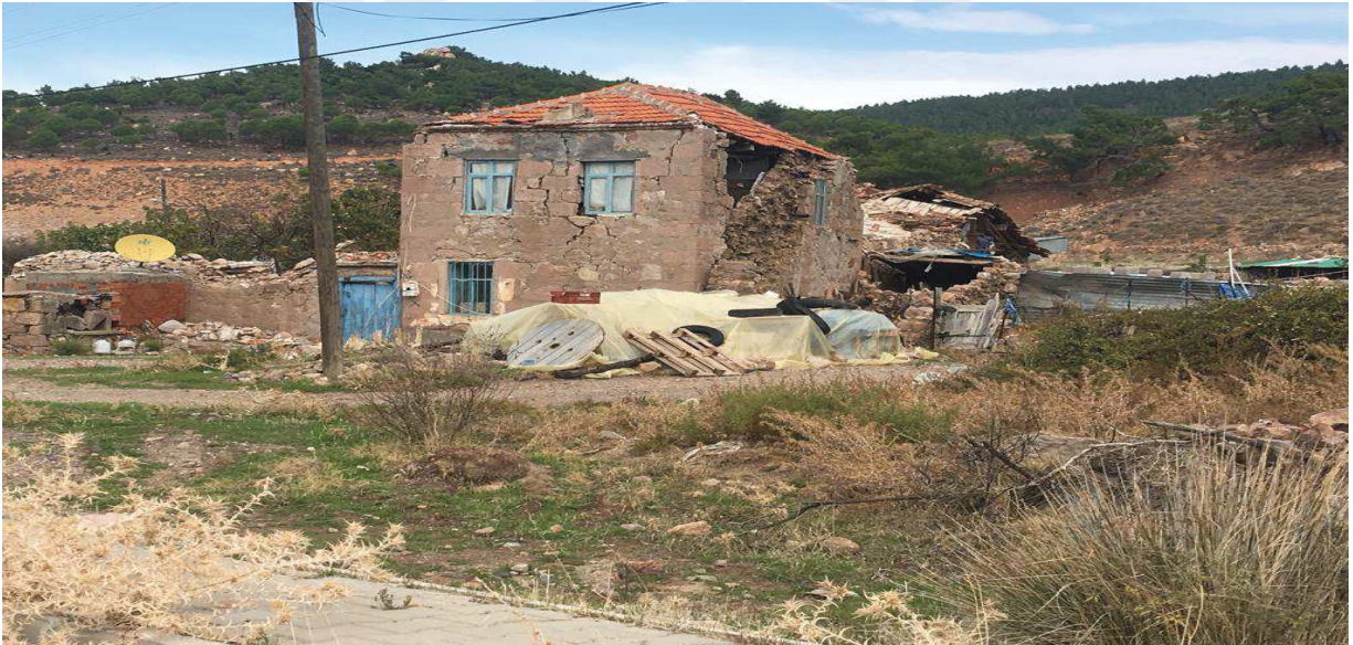
Fotoğraf 2. Çanakkale-Ayvacık Depremi Tuzla Köyü hasar alan bina 16.3.2019
