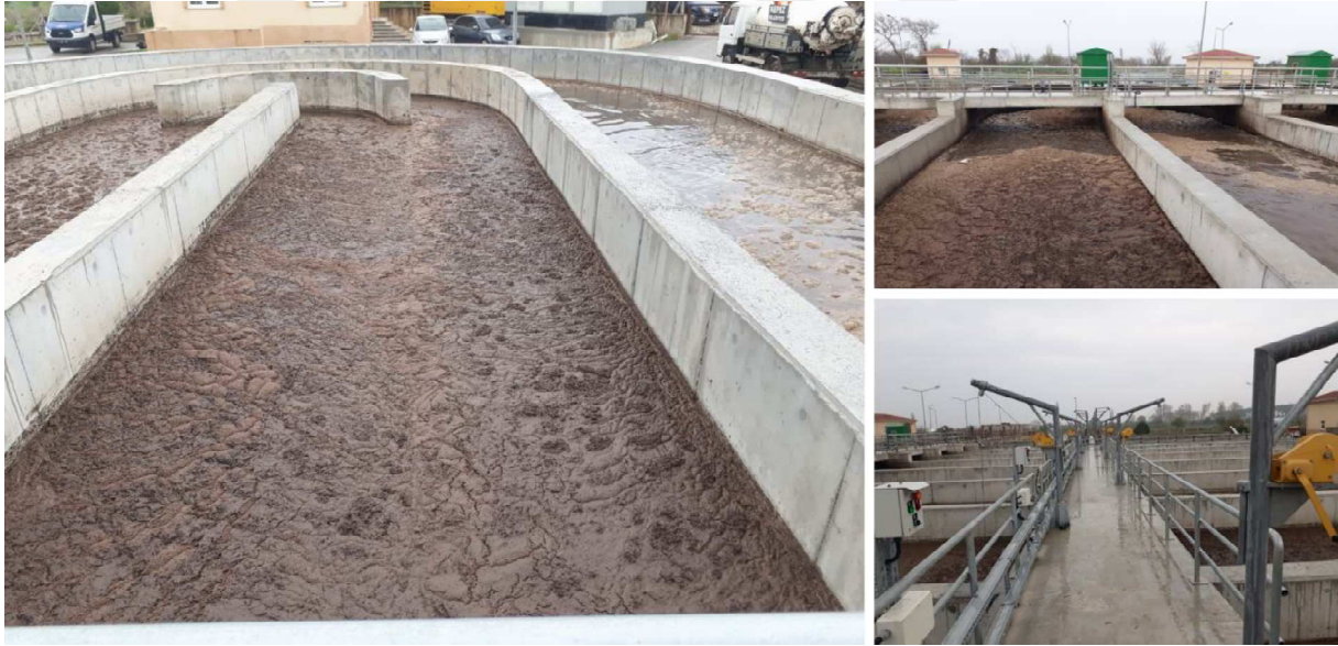
Şekil 8. Çanakkale Kepez arıtma tesisi (Akarsu, 2019)
