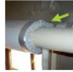
Asbest içerikli bez
