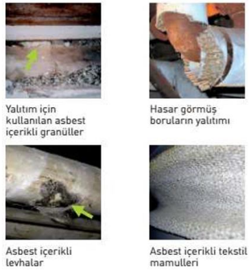
Resim 11.Asbestli Yalıtım Malzemesi (Cebecioğlu, 2016).
