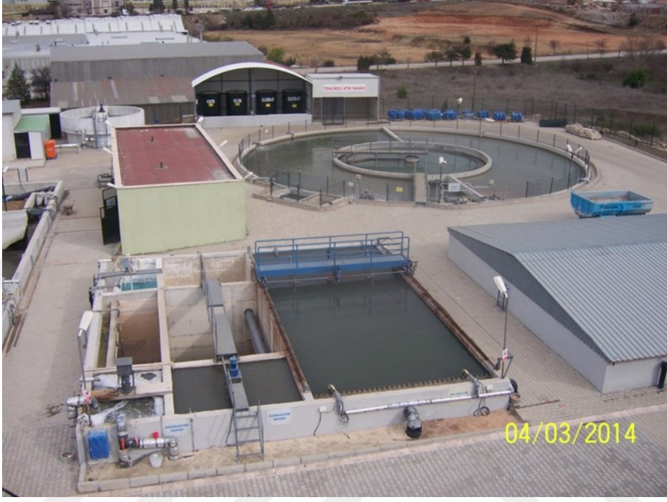
Şekil 11. Bilecik 1. OSB Arıtma Tesisi
