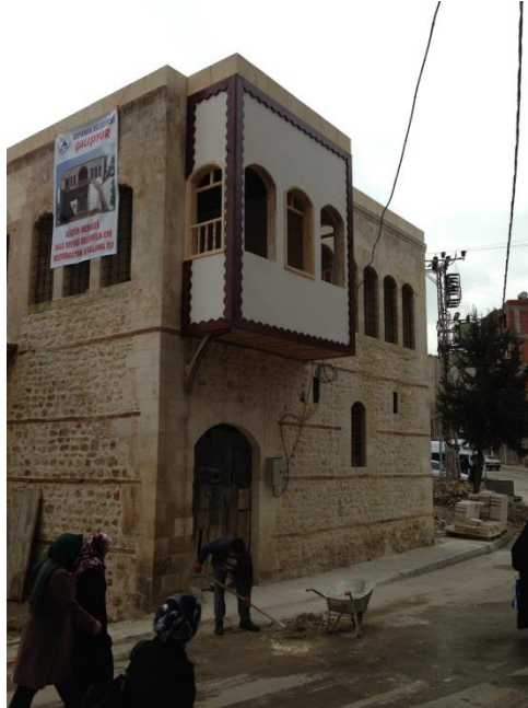
Şekil 200: Adıyaman Geleneksel Evi (Eski Değirmen Evi) Keleş Konağı Restorasyon Aşaması (Adıyaman Belediyesi, 2012)
