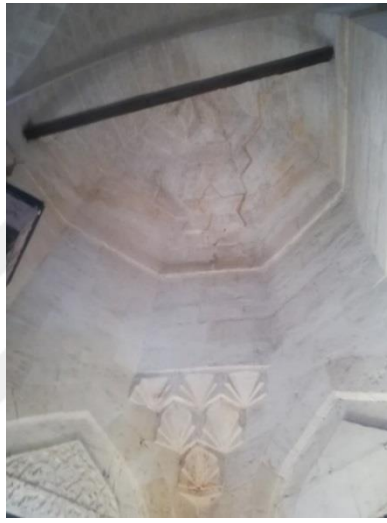
Resim 51 Dört köşede bulunan manastır tonozu, bindirmeli mukarnas geçişi ve gergi çubuğu görünüm 2018.
