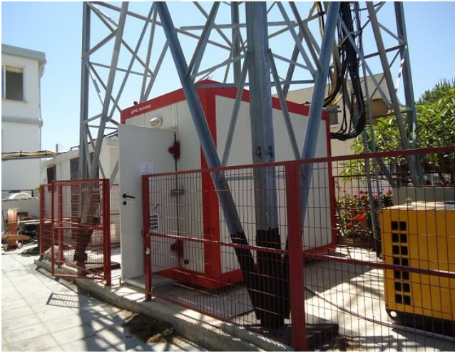
Resim 2: Baz istasyonu konteynirından bir görünüş, KKTC Girne Telefon Dairesi
