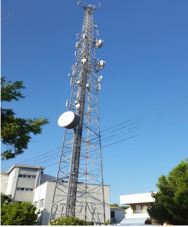
Resim 1: Kule tipi baz istasyonu, KKTC Girne Telefon Dairesi
