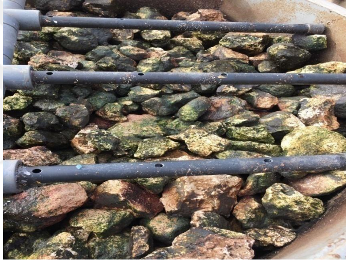
Resim 4.6. Dolgu malzemesi yüzeyinde oluşan biyofilm tabakası
