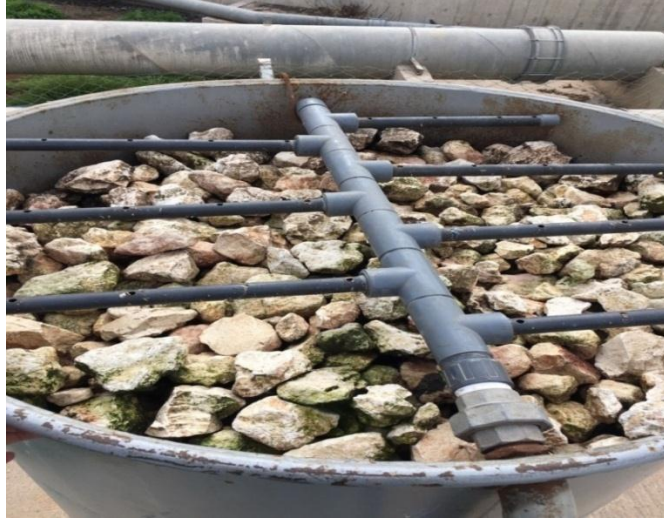
Resim 3.5. İkinci aşama reaktör içerisindeki dolgu malzemesinin durumu
