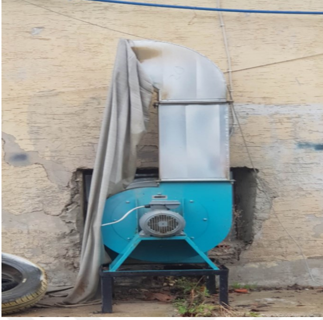
Şekil 4.11. Boya Atölyesi Havalandırma Uygulaması
