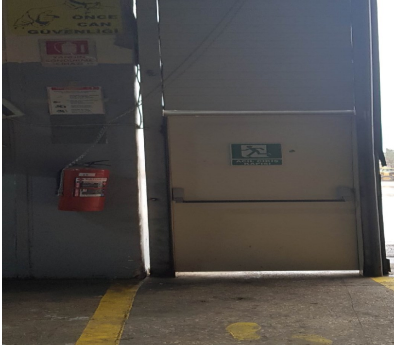
Şekil 4.9.Kamyon Tamir Atölyesi Acil Çıkış Kapısı Uygulaması
