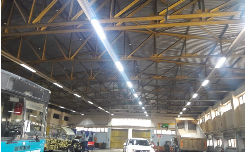
Şekil 4.12. Kamyon Tamir Atölyesi Aydınlatma Sistemi Uygulaması
