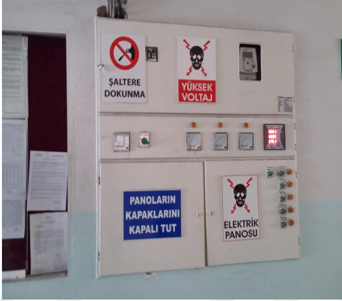
Şekil 4.6.İşaret, İkaz ve Uyarı Levhası Uygulamaları-2
