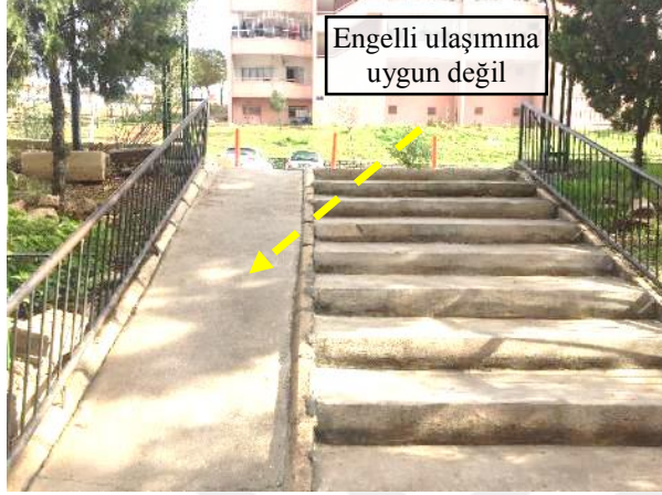
Çıksorut Toplu Konut Alanı Engelli Erişimine Uygun Olmayan Rampa Çözümleri (Eğim Uygun Değil, Rampa Korkuluk Yok)
