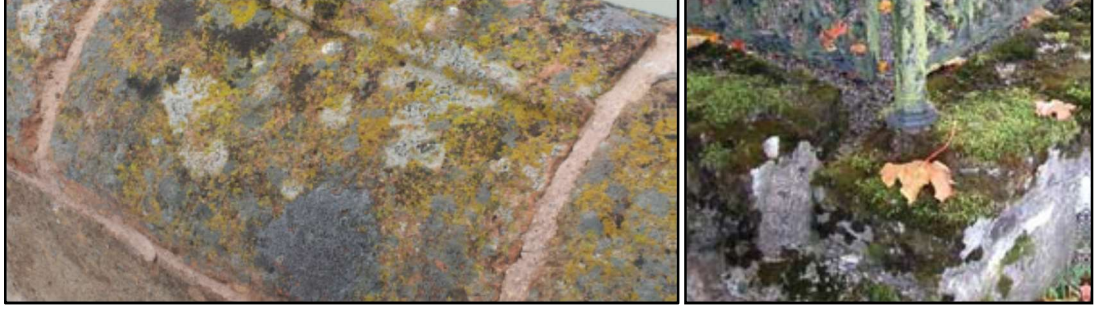
Şekil 3.17. Taşlar üzerinde alg ve karayosunu oluşumu
