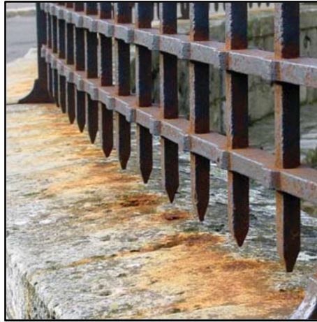
Şekil 3.23. Niteliksiz ek sonucu oluşan hasarlar
