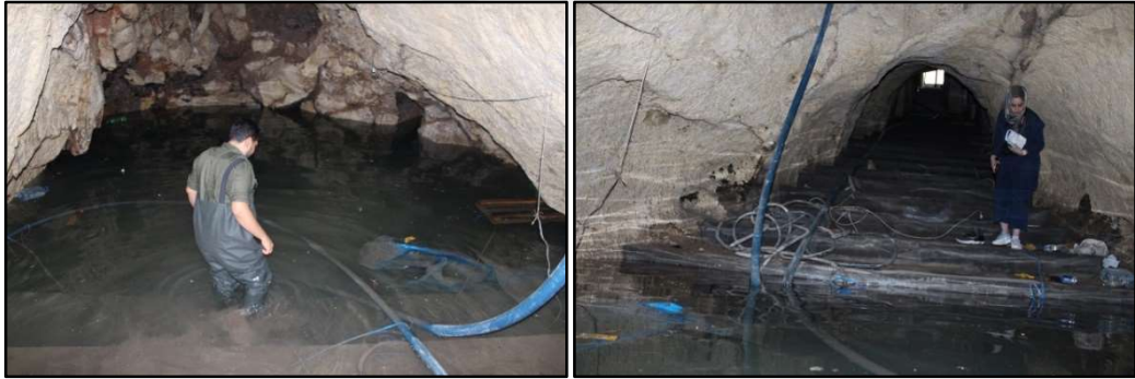
Şekil 2.16. İmam-ı Gazali Kasteli'nde su basan ve balçık oluşan kısım
