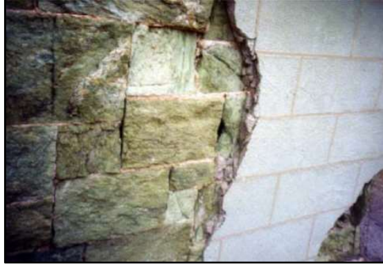
Şekil 3.22. Onarımda hatalı malzeme seçimi
