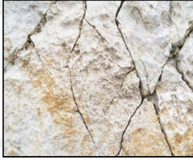
Şekil 3.5. Yıldız şeklinde çatlaklar
