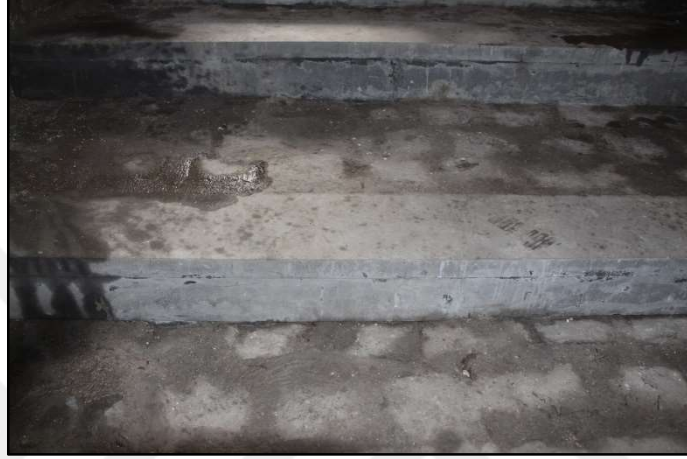
Şekil 5.9. İmam-ı Gazali Kasteli merdiven basamaklarında niteliksiz ekler
