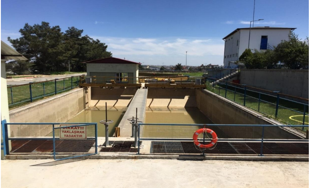
Şekil 3.12: Geri Yıkama Ünitesi - 2
