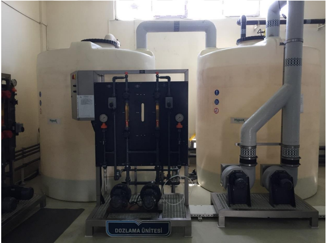
Şekil 3.10: Klor Dozlama Ünitesi
