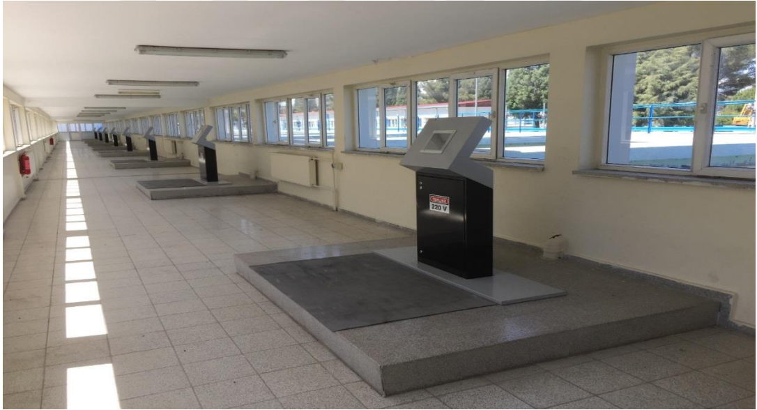
Şekil 3.8: Filtrasyon Ünitesi Kontrol Merkezi
