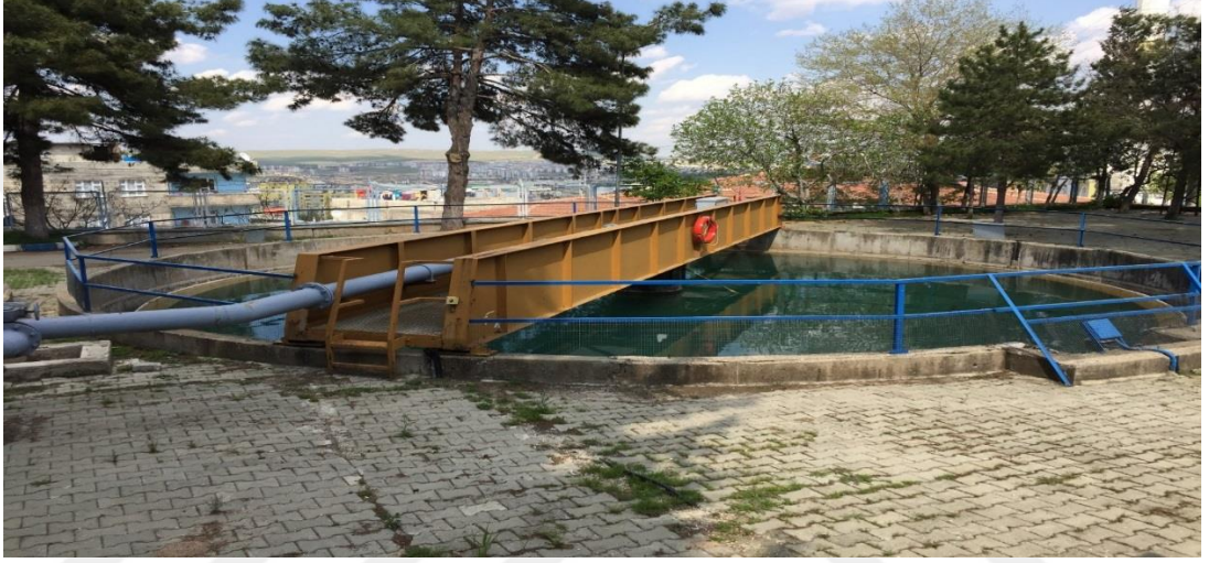
Şekil 3.11: Geri Yıkama Havuzu - 1
