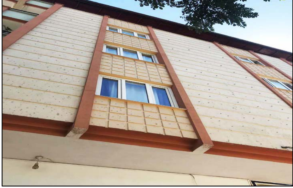
Şekil 3.3: Dolu yağışından etkilenmiş dış cephe örneği (Orbay, 2019).
