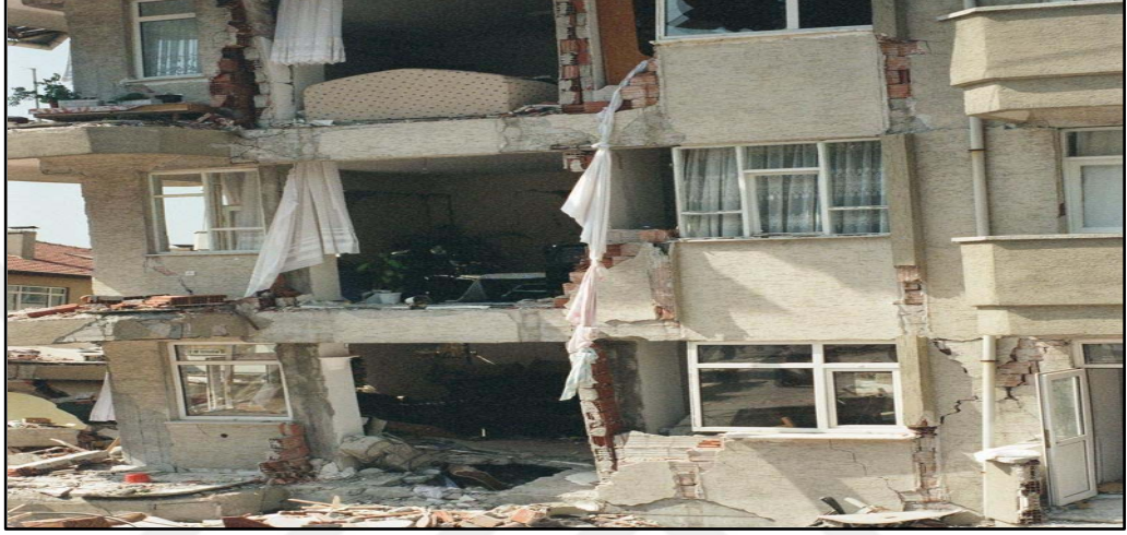
Şekil 3.1: 1999 Gölçük Depreminde duvarları hasar görmüş bir bina örneği (URL-20).
