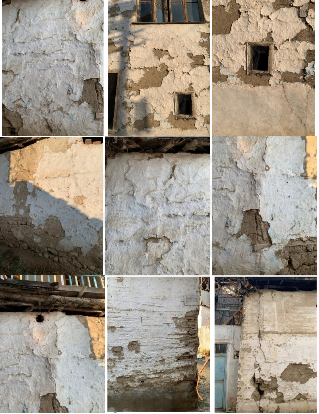
Şekil 4.28: Yapılardaki malzeme kaybı örneği (2019)
