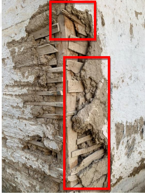
Şekil 4.26: Nemin kerpiç duvarda ve strüktürde yarattığı tahrip örneği (2019)
