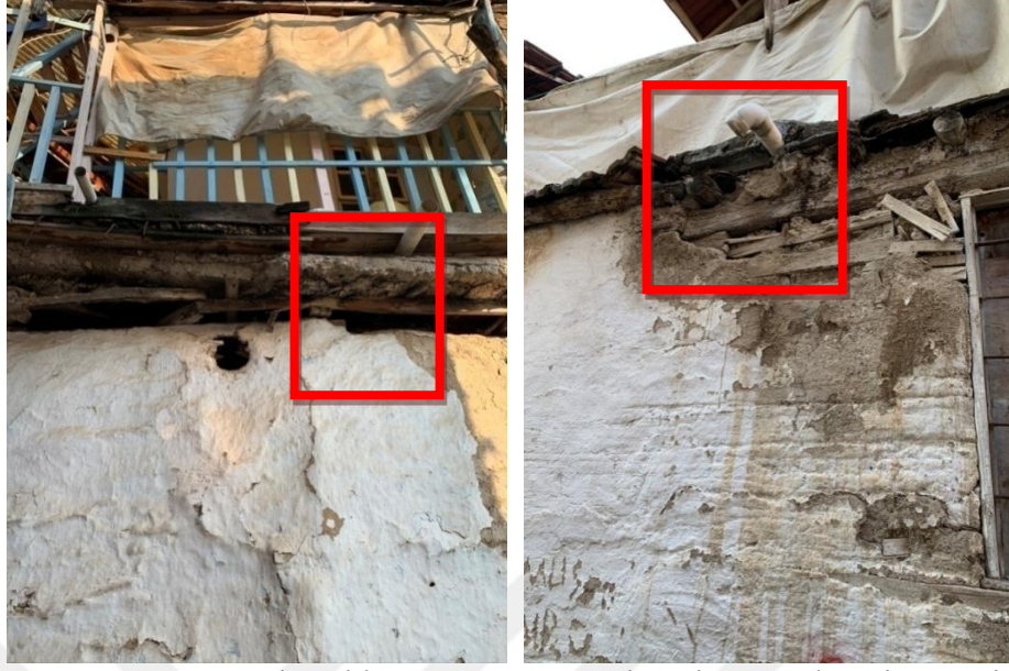
Şekil 4.25: Yapıya sonradan eklenen ve zarara neden olan çatı drenajı örneği (2019)
