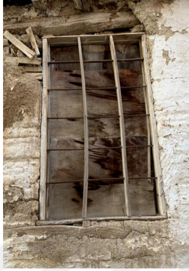
Şekil 4.27: Don etkisiyle pencerelerin duvarlarda ve ahşap da yaptığı hasar örneği (2019)
