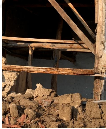
Şekil 4.32: Ahşabın deformasyona (nem, küf, mantar oluşumu) uğraması örneği (2019)
