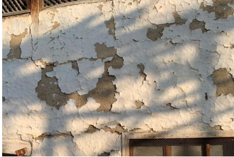
Şekil 4.31: Kabaran, dökülen cephe örneği (2019)
