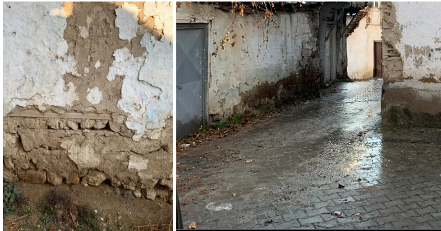
Şekil 4.24: Biriken suyun subasman duvarlarına olan etkisi örneği (2019)
