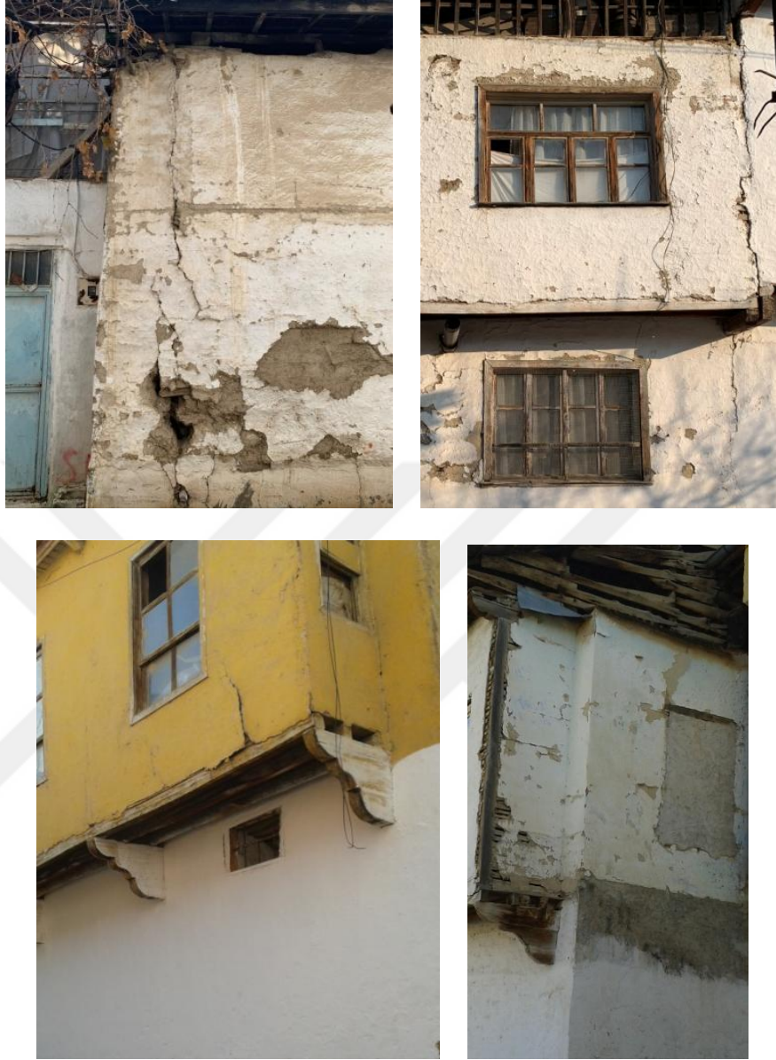
Şekil 4.19: Zeminden kaynaklanan çatlak örneği (2019)
