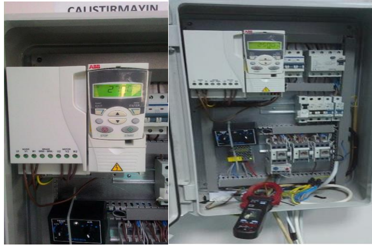
Şekil 3.10 : a) Frekans invertörü ve b) pens ampermetre ile akım ölçümleri.
