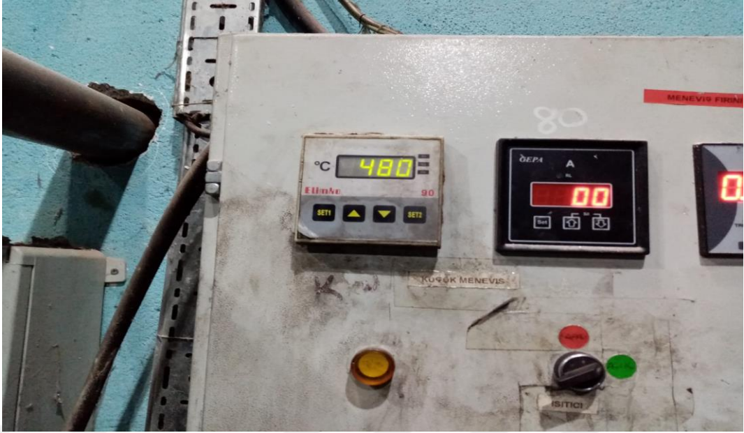
Şekil 4.8 Malzemelerin çözeltiye alma sıcaklığı ve fırın kontrol paneli
