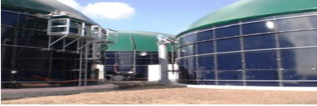
Şekil 6.4. Zorg biyogaz üretim sistemlerinin tesislerinde kullandığı bir tür reaktör (Zorg biyogaz üretim sistemleri, 2015)
