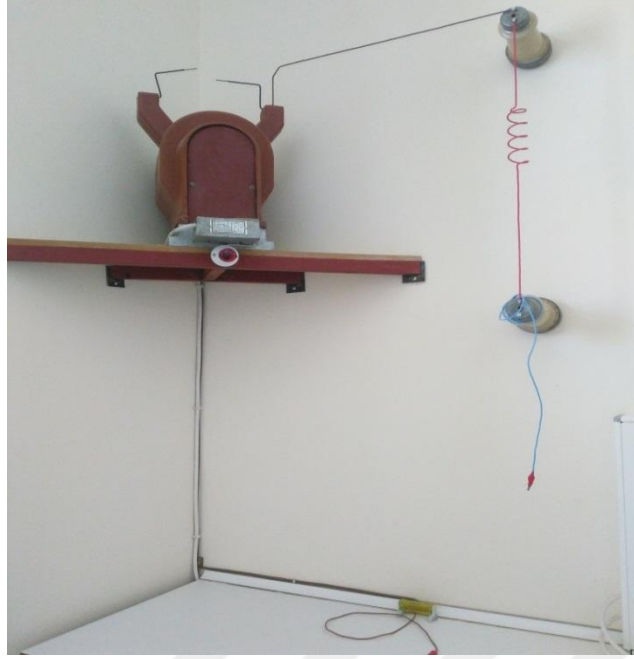
Şekil 3. 1: Deneysel çalışmada kullanılan dâhili tip gerilim trafosu
