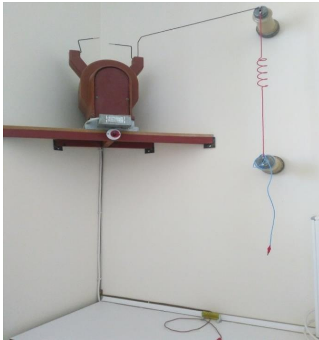
Şekil 3.3. Deney sisteminde kullanılan yüksek gerilim trafosu
