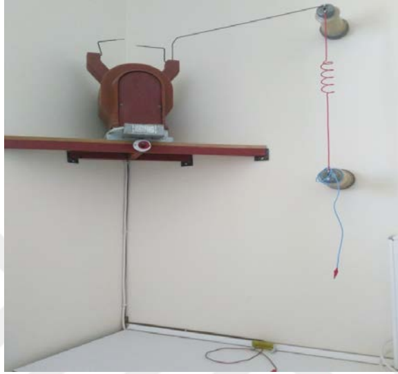
Şekil 3.1. Deney Trafosunun görüntüsü
