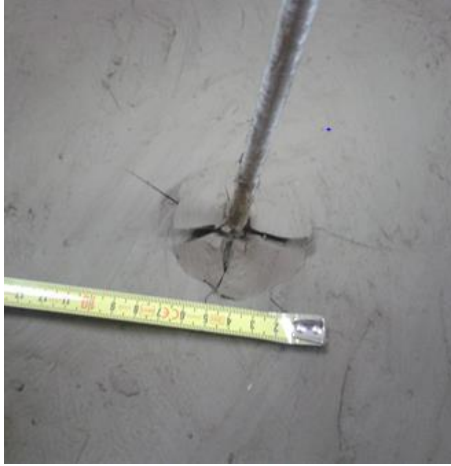
Şekil 5.1. Tipik Gerilme Çatlağı
