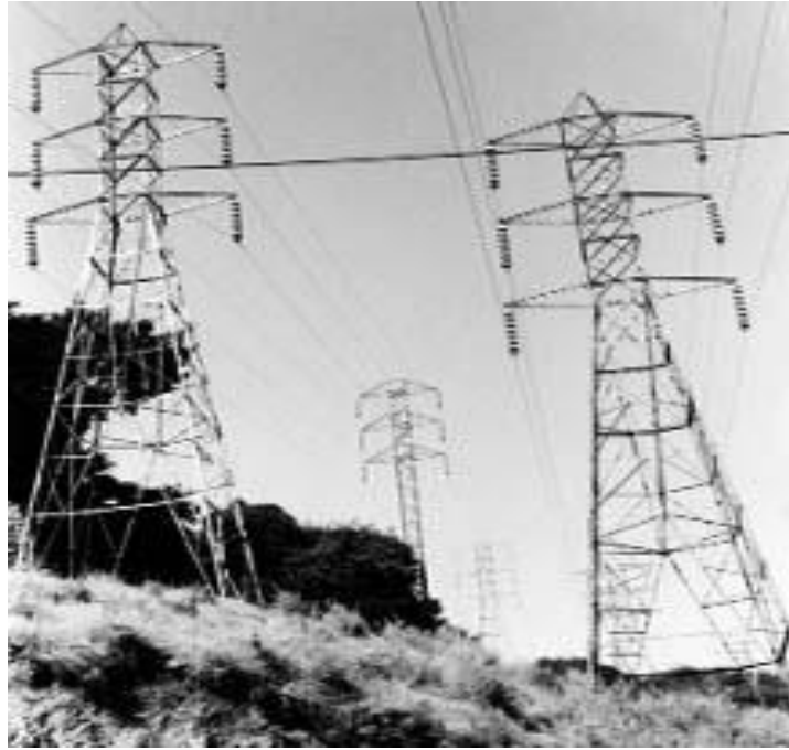
Şekil 1.1 Yüksek Gerilim Hattı (Demir 2006)
