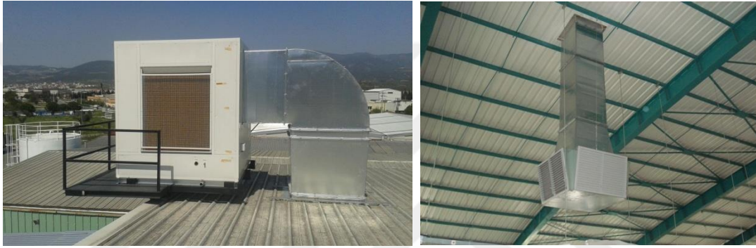
Şekil 1.3. Hava yıkayıcıların endüstriyel tesislerde kullanımı [20]
