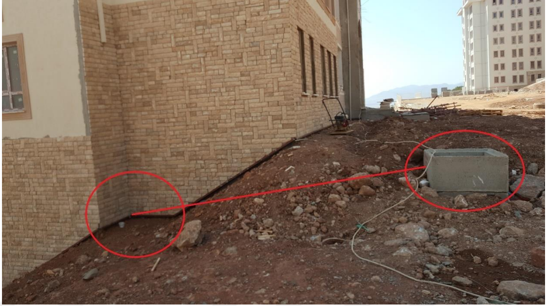
Şekil 6.3. Yağmur suyu kotu sorunu-1
