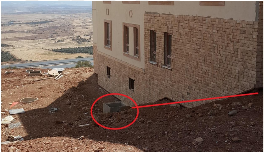
Şekil 6.4. Yağmur suyu kotu sorunu-2
