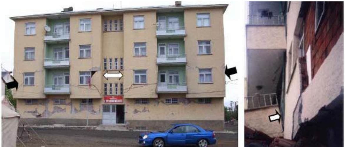
Şekil 3.4. 2003 Bingöl depreminde kapalı çıkma hasarları [5]
