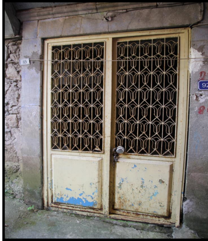
Görsel 138. Tescilli Ev 1, Batı Cephesi Görünüşü (Trabzon Rölöve ve Anıtlar Müdürlüğü Sokak Sağlıklaştırma Projesinden)
