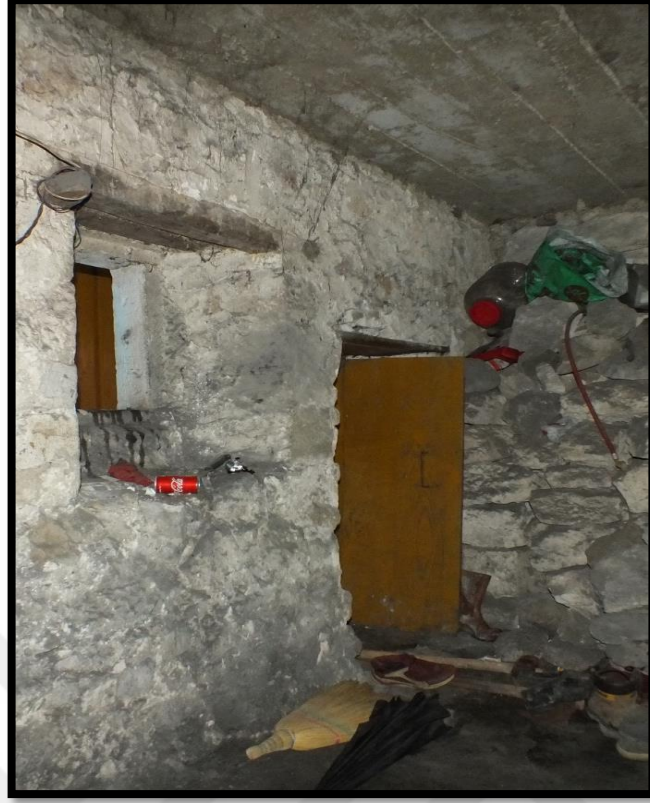
Görsel 211. Tescilli Ev 5, Bodrum Katı Oda Görünüşü (Trabzon Rölöve ve Anıtlar Müdürlüğü Sokak Sağlıklaştırma Projesinden)
