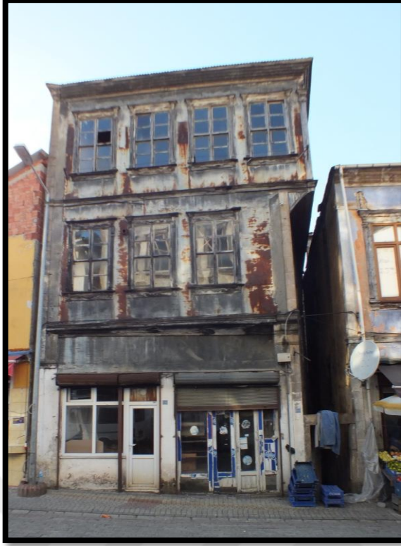
Görsel 187. Tescilli Ev 4, Güney Cephesi Görünüşü (Trabzon Rölöve ve Anıtlar Müdürlüğü Sokak Sağlıklaştırma Projesinden)
