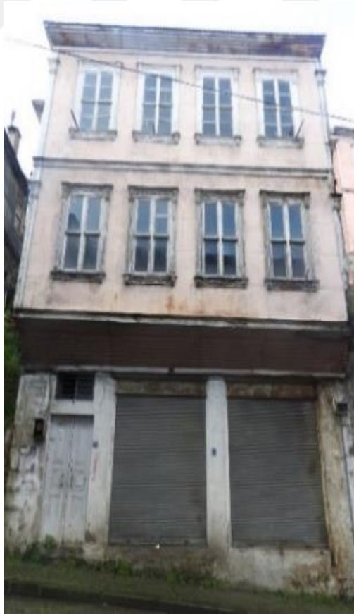
Görsel 350. Tescilli Ev 11, Kuzey Cephesi Görünüşü (Trabzon Rölöve ve Anıtlar Müdürlüğü Sokak Sağlıklaştırma Projesinden)
