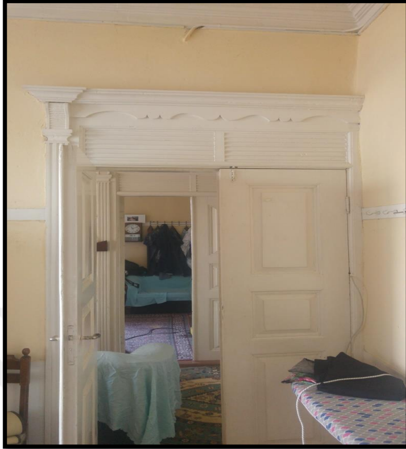
Görsel 449. Tescilli Ev 14, İkinci Kat Oda Görünüşü (Trabzon Rölöve ve Anıtlar Müdürlüğü Sokak Sağlıklaştırma Projesinden)
