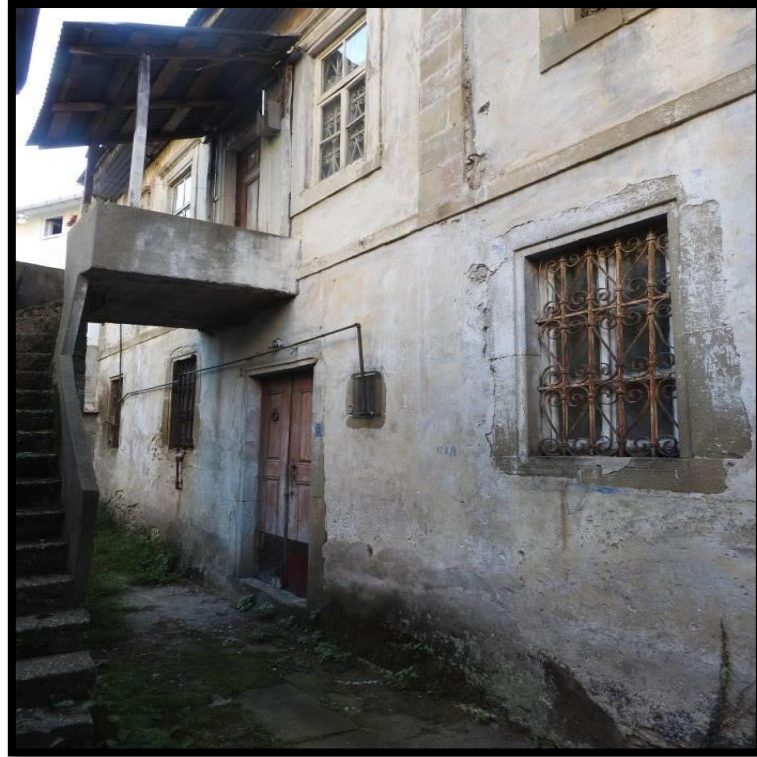
Görsel 280. Tescilli Ev 8, Güney Cephesi Görünüşü (Trabzon Rölöve ve Anıtlar Müdürlüğü Sokak Sağlıklaştırma Projesinden)
