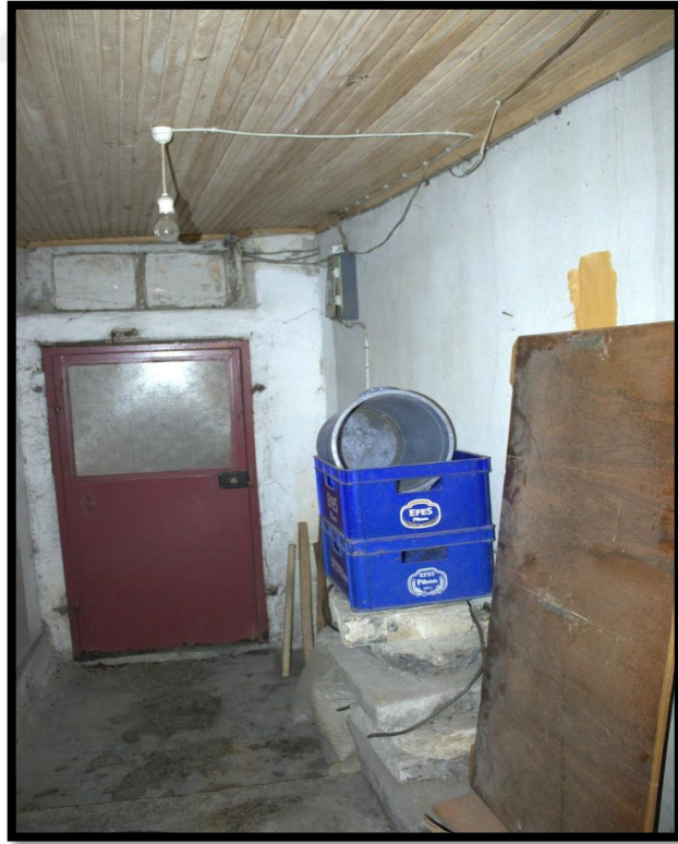
Görsel 214. Tescilli Ev 5, Bodrum Katından Görünüş (Trabzon Rölöve ve Anıtlar Müdürlüğü Sokak Sağlıklaştırma Projesinden)
