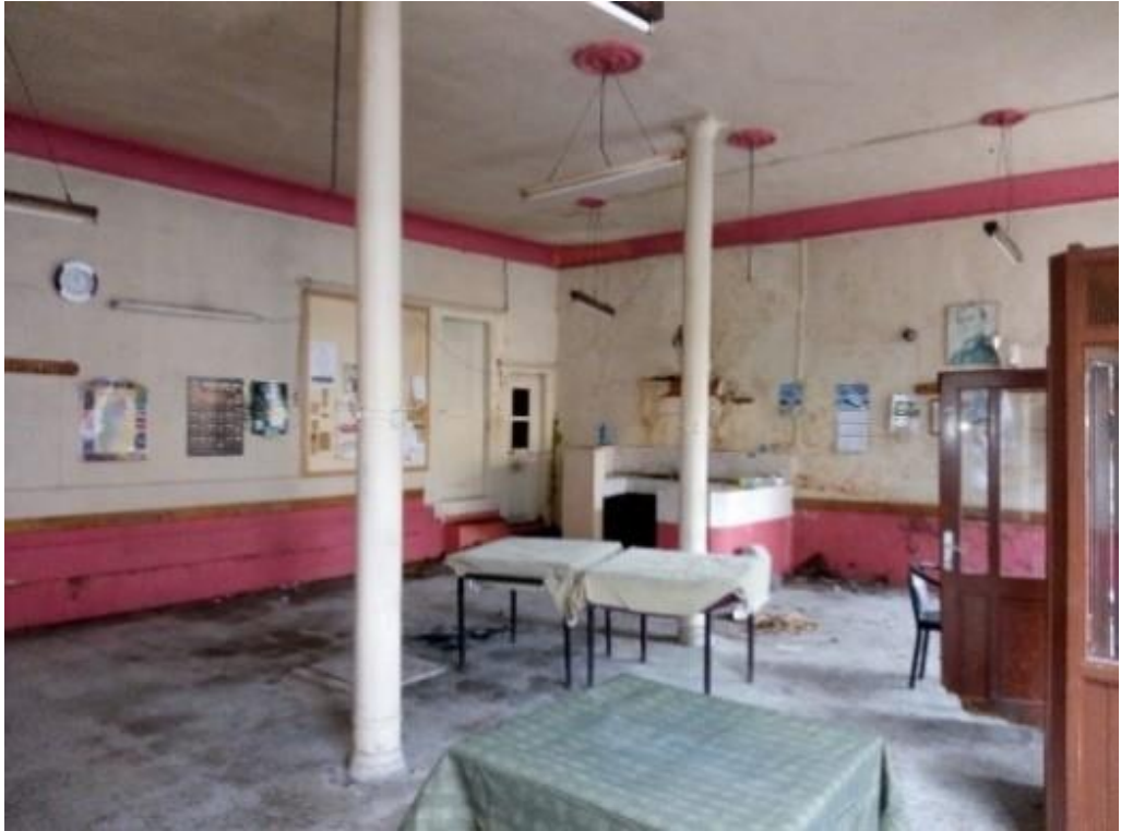
Görsel 170. Tescilli Ev 2, Zemin Katta Kahvehanenin Görünüşü (Trabzon Rölöve ve Anıtlar Müdürlüğü Sokak Sağlıklaştırma Projesinden)
