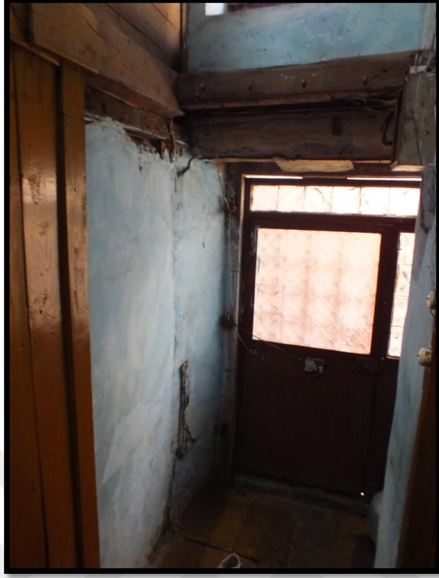
Görsel 209. Tescilli Ev 5, Bodrum Katı Görünüşü (Trabzon Rölöve ve Anıtlar Müdürlüğü Sokak Sağlıklaştırma Projesinden)
