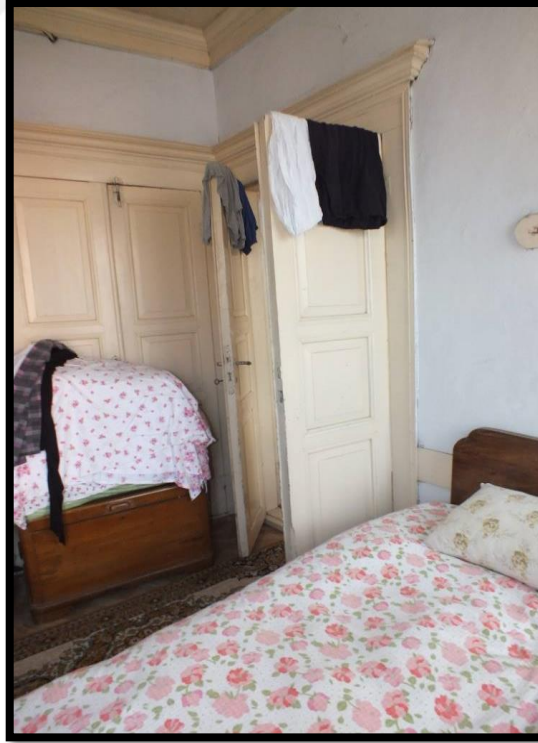
Görsel 330. Tescilli Ev 9, İkinci Kattan Görünüş (Trabzon Rölöve ve Anıtlar Müdürlüğü Sokak Sağlıklaştırma Projesinden)
