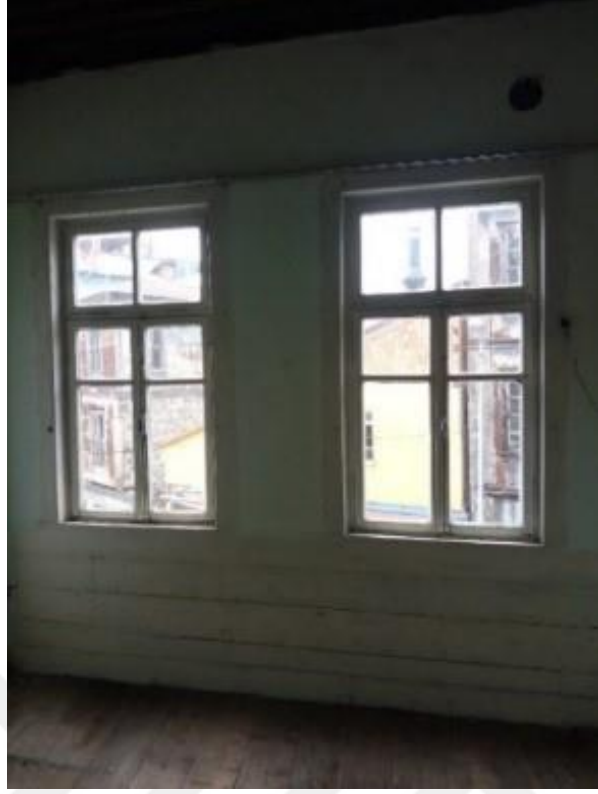
Görsel 167. Tescilli Ev 2, Pencere Altlarında Ve Alt Seviyede Devam Eden Ahşap Şeritler (Trabzon Rölöve ve Anıtlar Müdürlüğü Sokak Sağıklaştırma Projesinden)
