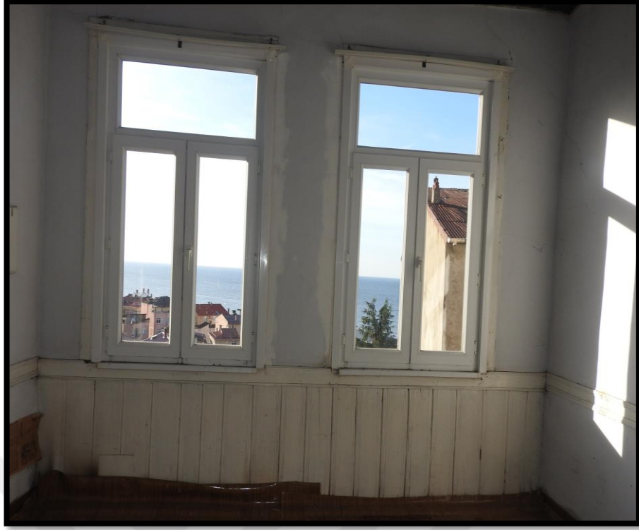
Görsel 309. Tescilli Ev 8, İkinci Kat Oda Görünüşleri (Trabzon Rölöve ve Anıtlar Müdürlüğü Sokak Sağlıklaştırma Projesinden)
