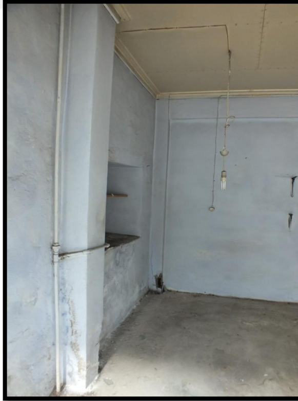
Görsel 380. Tescilli Ev 12, Zemin Kat Dükkân Görünüşü (Trabzon Rölöve ve Anıtlar Müdürlüğü Sokak Sağlıklaştırma Projesinden)
