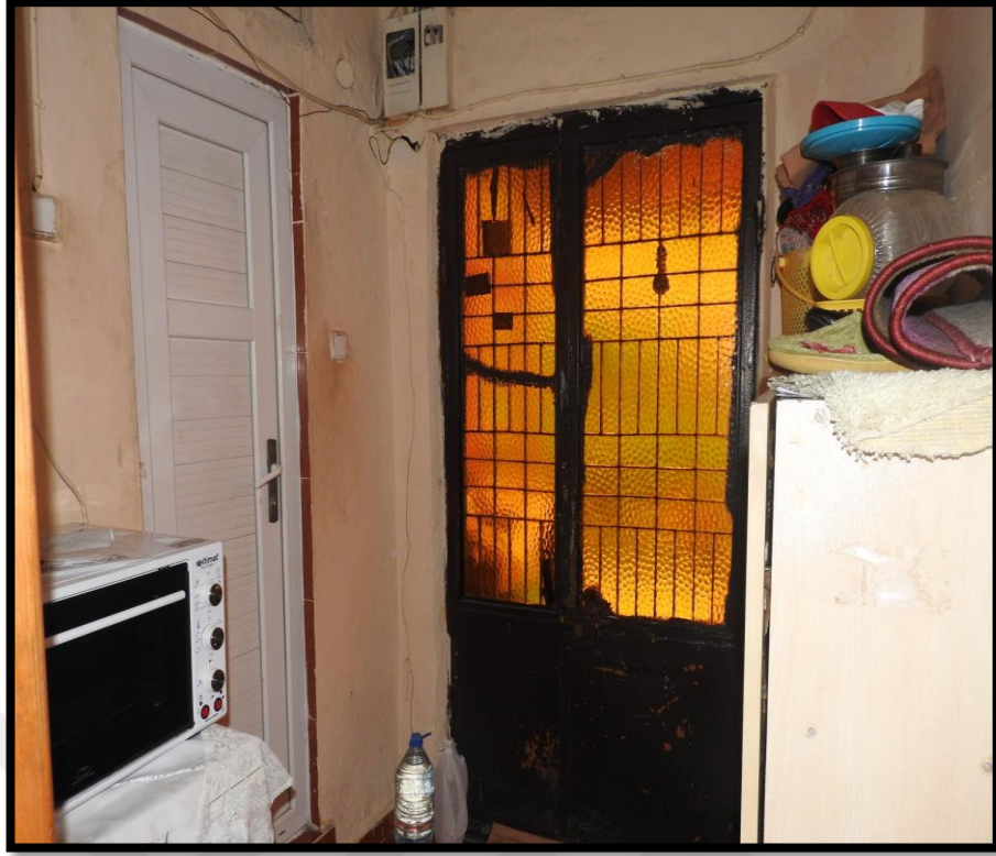
Görsel 415. Tescilli Ev 13, İkinci Kat Girişten Görünüş (Trabzon Rölöve ve Anıtlar Müdürlüğü Sokak Sağlıklaştırma Projesinden)
