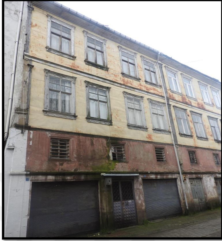
Görsel 279. Tescilli Ev 8, Kuzey Cephesi Görünüşü (Trabzon Rölöve ve Anıtlar Müdürlüğü Sokak Sağlıklaştırma Projesinden)
